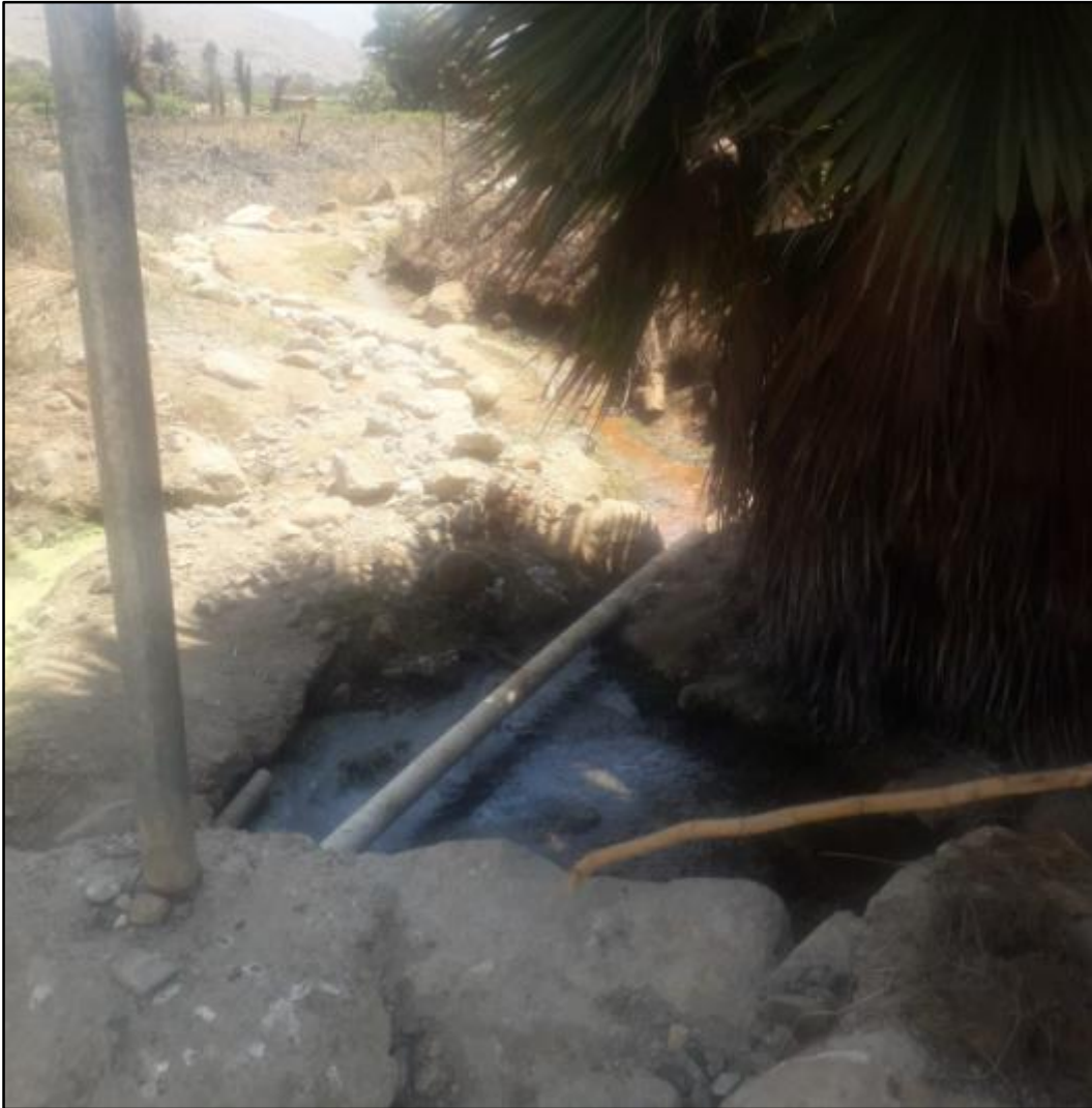
Imagen 13: Fotografía de tubería de conducción expuesta
