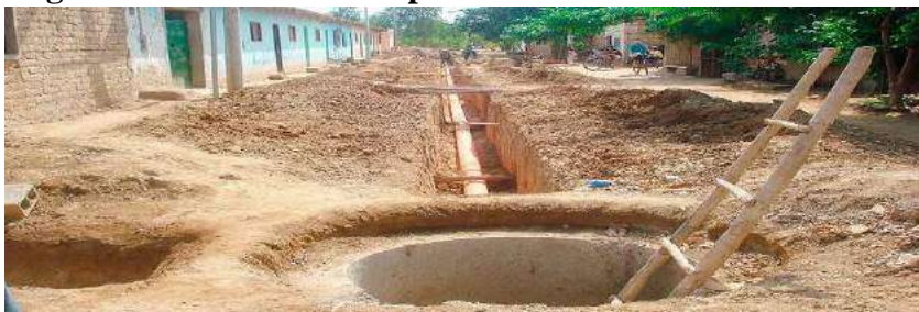
Figura N° 3: Buzon de Inspección
