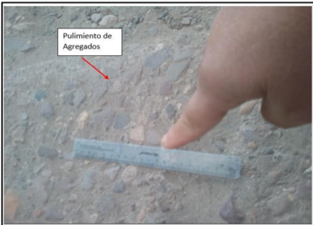
Fotografía 4: Patologías encontradas en el Jr. Bellavista.
