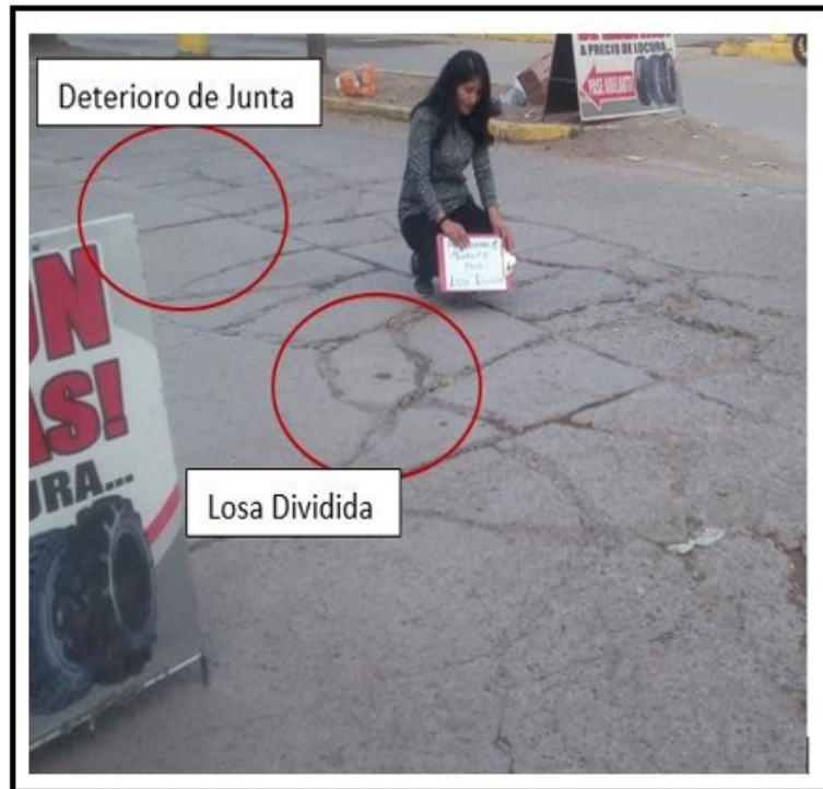
Fotografía 8: Deterioro de junta y Losa dividida.
