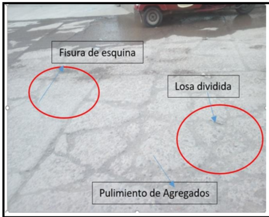
Fotografía 2: Patologías encontradas en el Jr. Bellavista.
