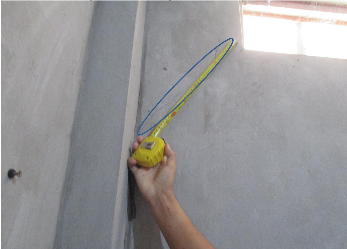
Fotografía 4: Muro afectado por fisura en Unidad Muestral 5.
