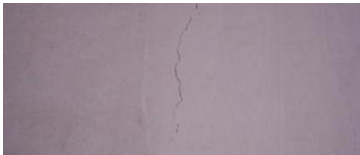
Figura 14. Fisura en el Revestimiento de un Muro. Nota. Fuente: Elaboración Propia. (2017).
