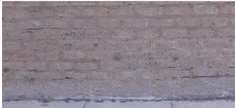
Figura 15. Erosión Química en Muro y Sobrecimiento. Nota. Fuente: Elaboración Propia. (2017).
