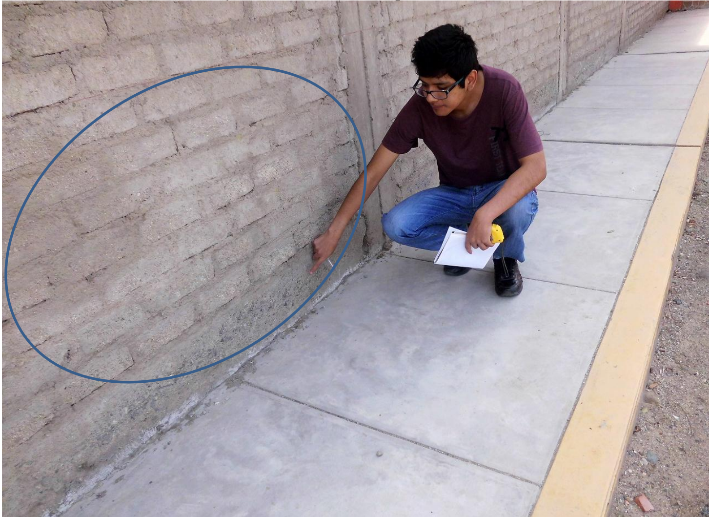
Fotografía 7: Muro y sobrecimiento afectado por erosión en Unidad Muestral 3.
