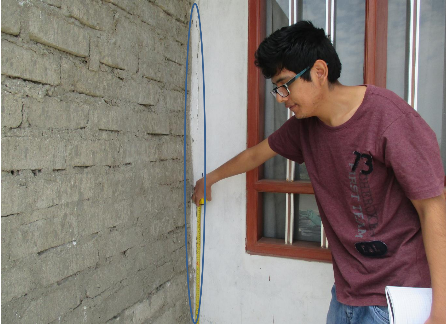
Fotografía 3: Columna afectada por fisura en Unidad Muestral 6.
