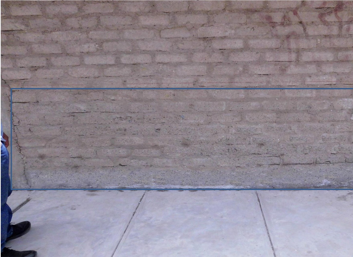
Fotografía 6: Muro y sobrecimiento afectado por erosión en Unidad Muestral 1.
