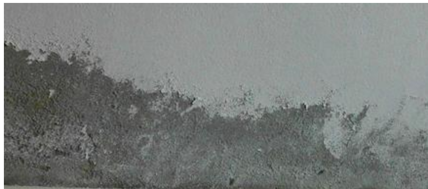
Figura 16. Eflorescencia en Muro.
