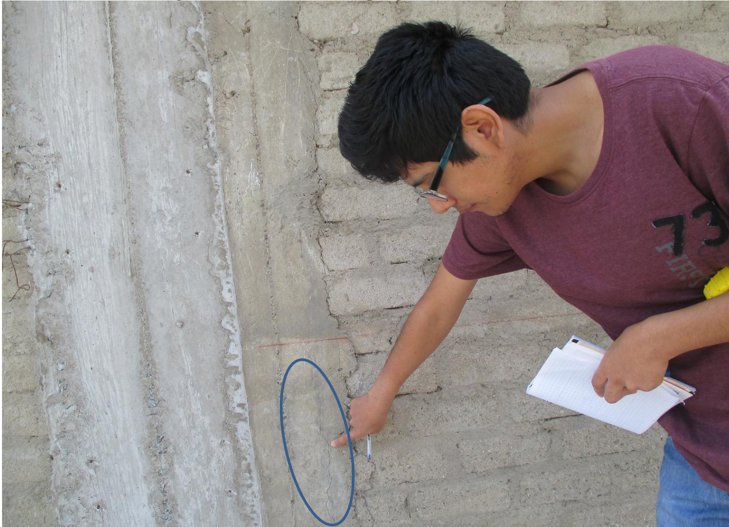
Fotografía 2: Columna afectada por grieta en Unidad Muestral 1.
