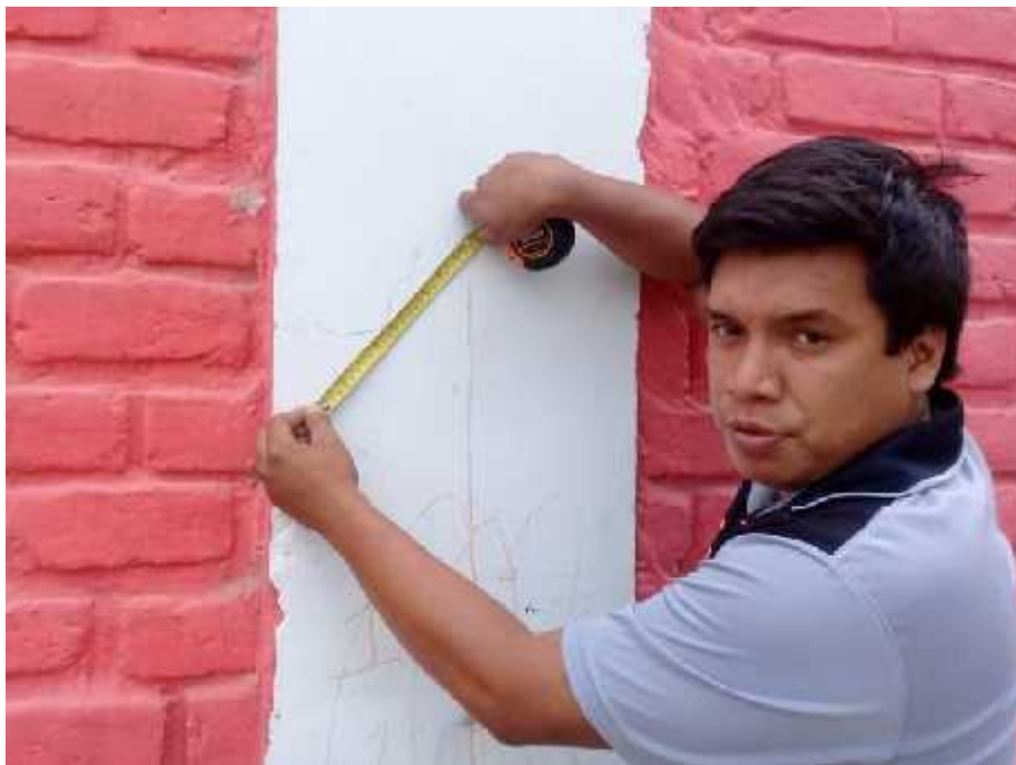
Gráfico 61: Presencia de fisuras en la columna de concreto armado.
