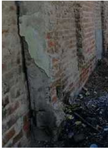
Gráfico 11: Desprendimiento en el tarrajeo de la columna de confinamiento.
