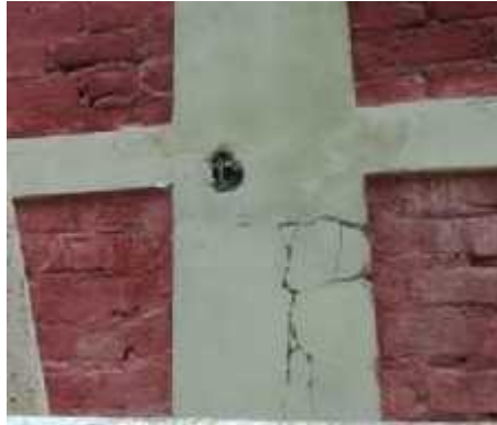
Gráfico 9: Grietas afectando la columna de confinamiento.
