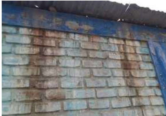
Gráfico 7: Suciedad afectando al muro de albañilería
