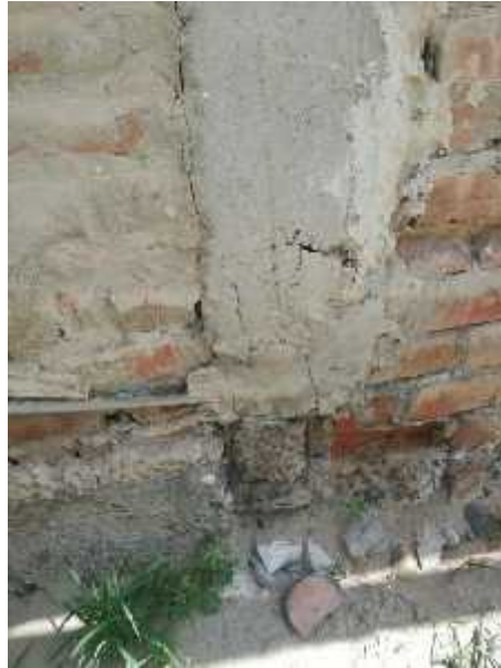
Gráfico 13: Oxidación y corrosión en el acero en la parte inferior de la columna de concreto armado
