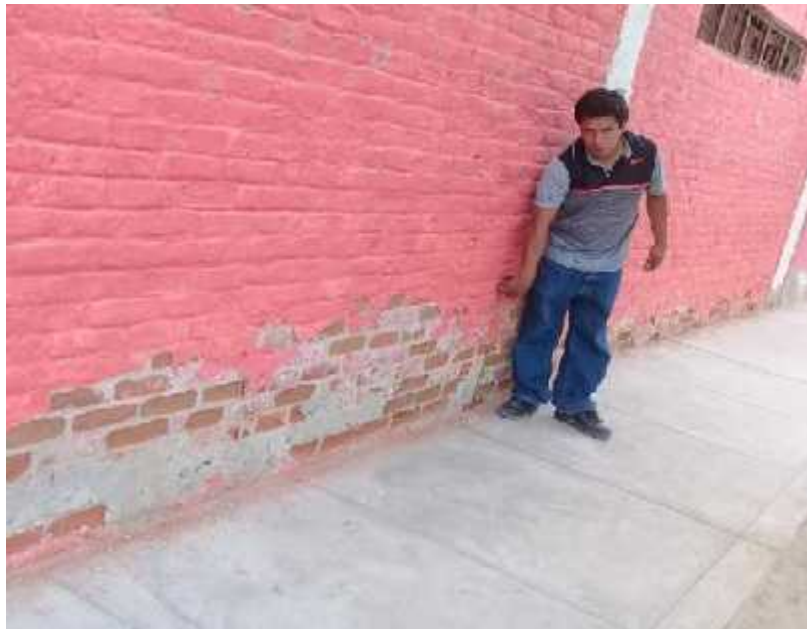
Gráfico 57: Presencia de erosión en la parte inferior de todo el muro en la unidad de muestra 3.
