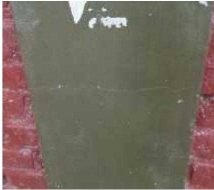
Gráfico 10: Fisura afectando la columna de confinamiento.
