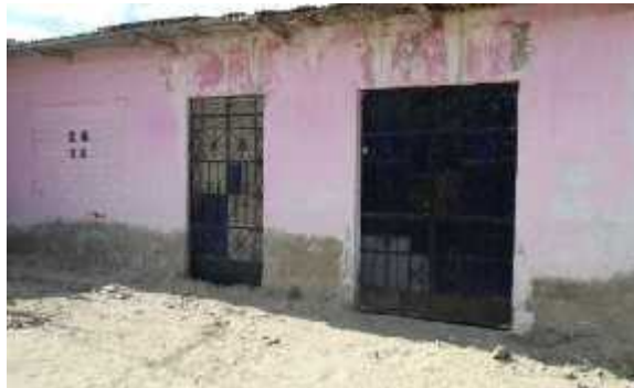
Gráfico 6: Humedad afectando la vivienda.
