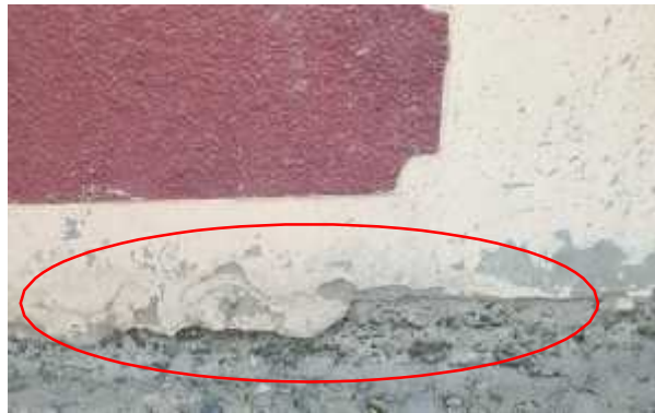
Gráfico 8: Erosión en el Sobrecimiento.
