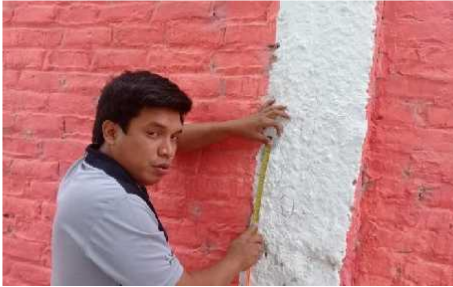
Gráfico 60: Fisura en la columna de concreto.
