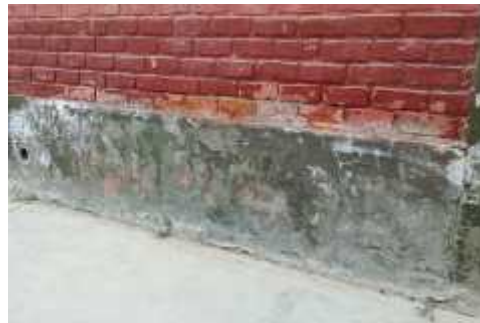
Gráfico 12: Eflorescencia en el sobrecimiento.
