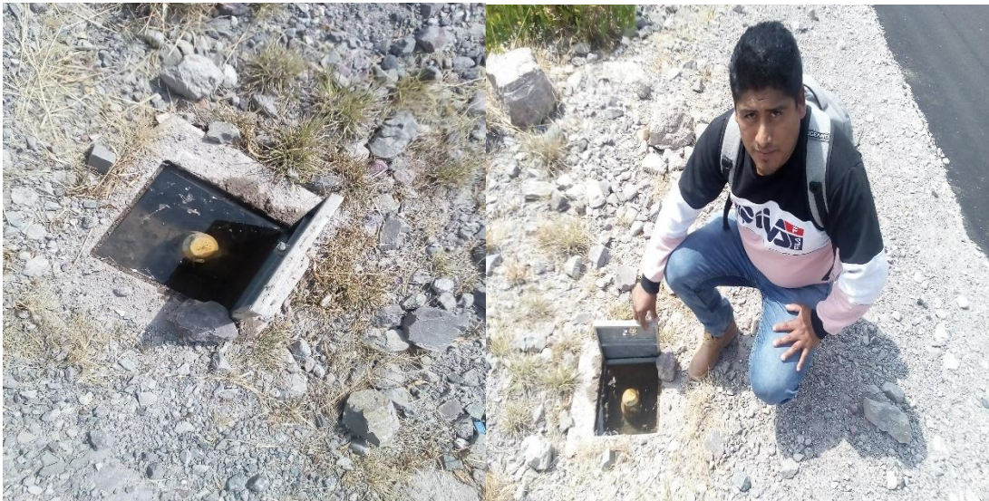
Figura 17: Válvula de control para la red de distribución.
