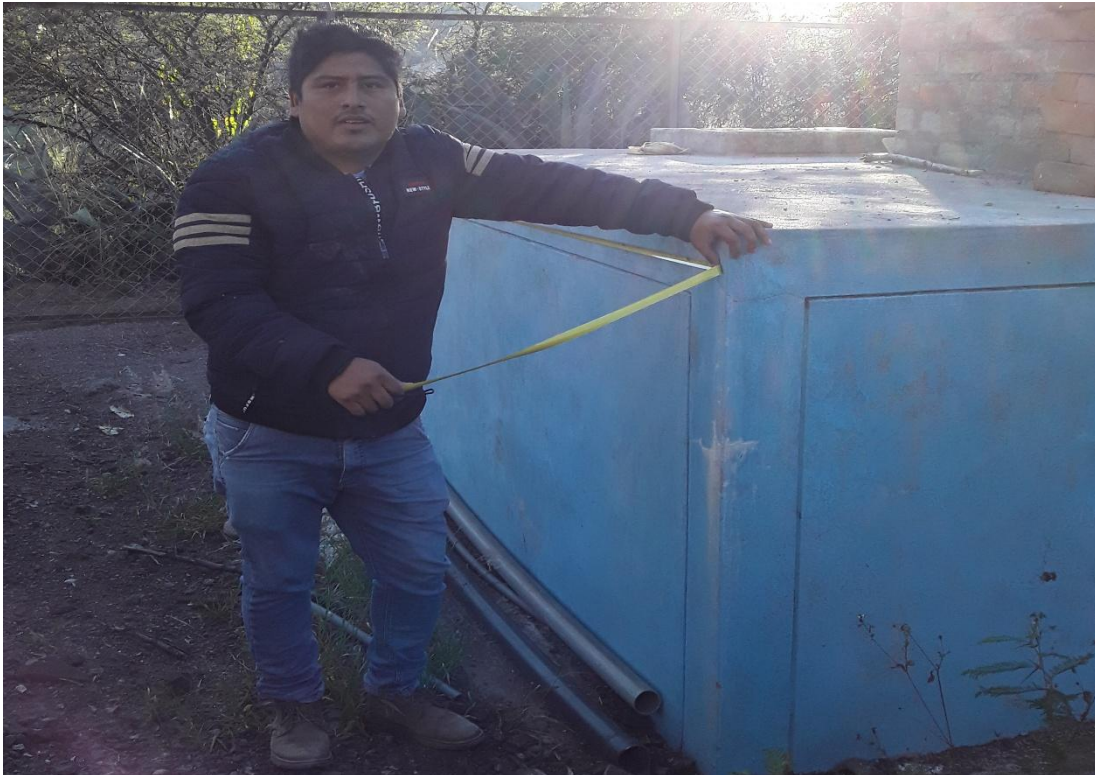
Figura 37: Reservorio capacidad de 16 m 3 .
