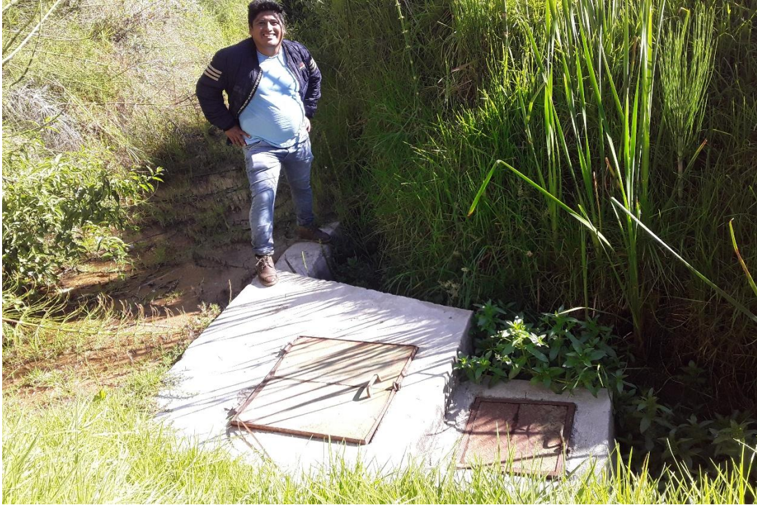
Figura 33: Estructura de captación-manante
