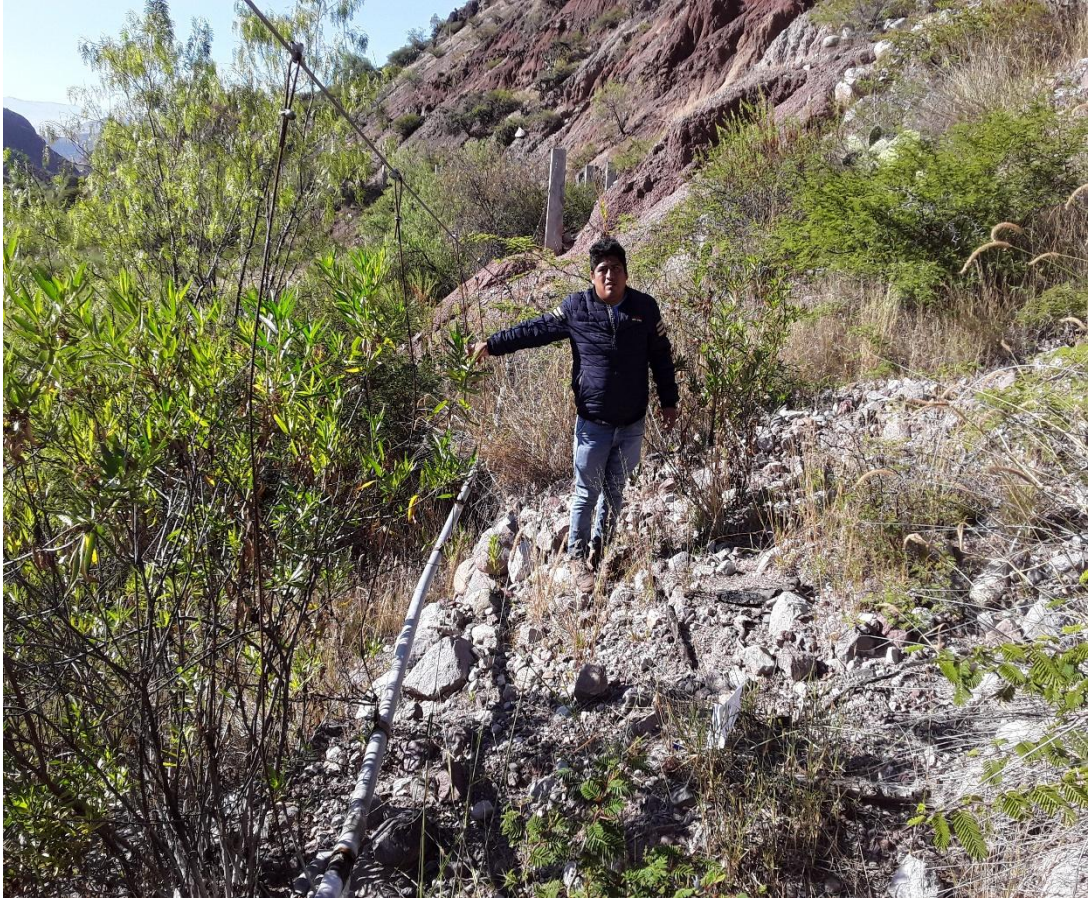
Figura 14: Línea de conducción con tubo galvanizado.
