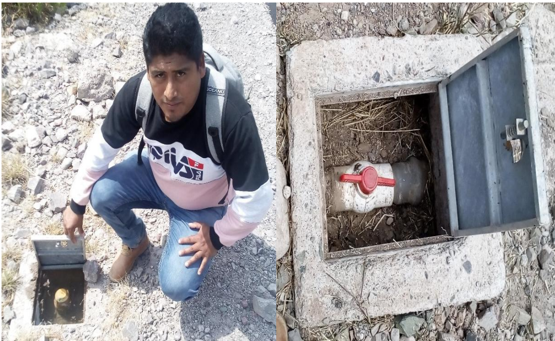
Figura 40: válvula de control en la línea de distribución.
