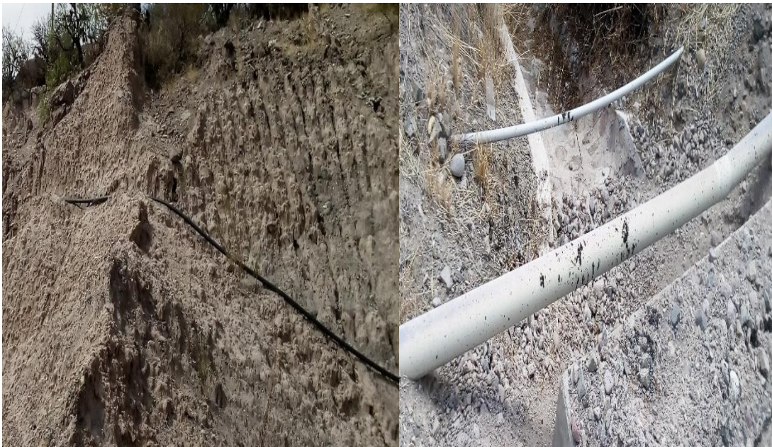
Figura 34: línea de conducción.
