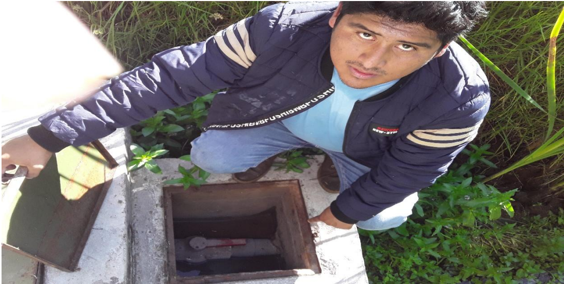
Figura 16: Válvula de control-salida de captación.
