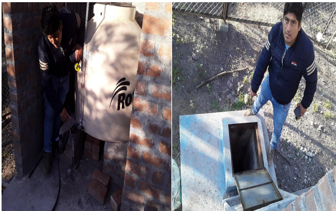
Figura 19: Reservorio-sistema de cloración-válvula de control
