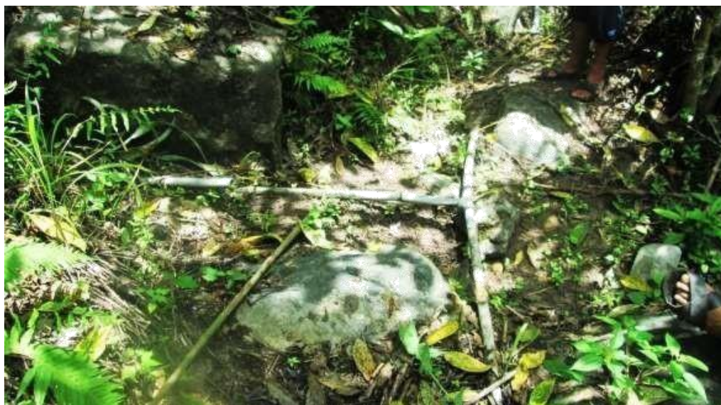
ILUSTRACIÓN 4: TUBERIA EXPUESTA Y DIAMETRO INADECUADO
