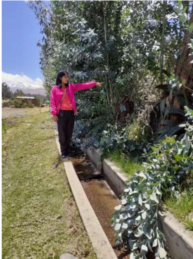
Foto N°07: Agentes que causan la grieta
