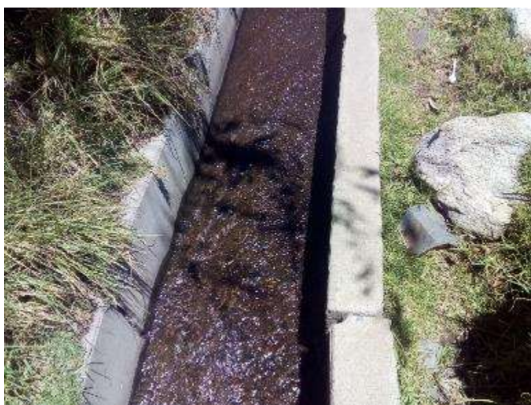
Foto N°02: Hundimiento en una junta del canal de Caururo
