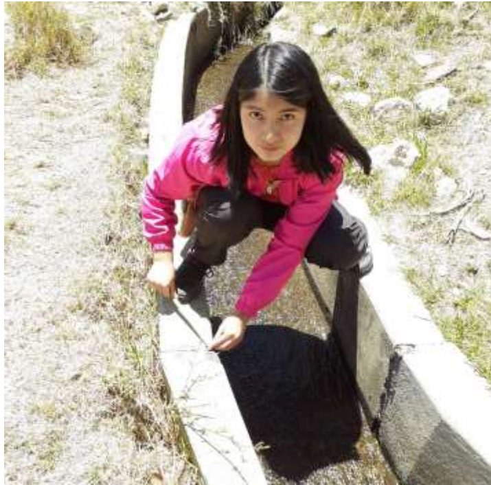
Foto N°05: Medición de las patologías del muro derecho del canal
