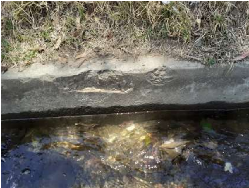
Foto N°10: Patología de impacto por agentes externos
