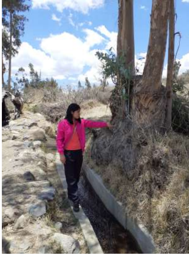
Foto N°09: Agentes biológicos que causa patología de grieta y vegetación
