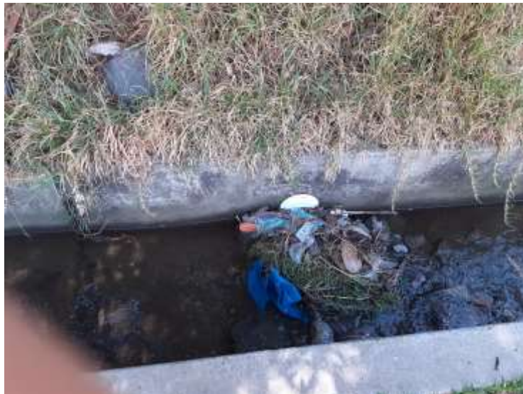
Foto N°08: Falta de mantenimiento
