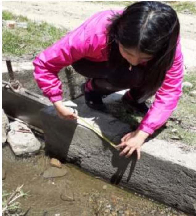
Foto N°03: Medición de las grietas del muro izquierdo del canal
