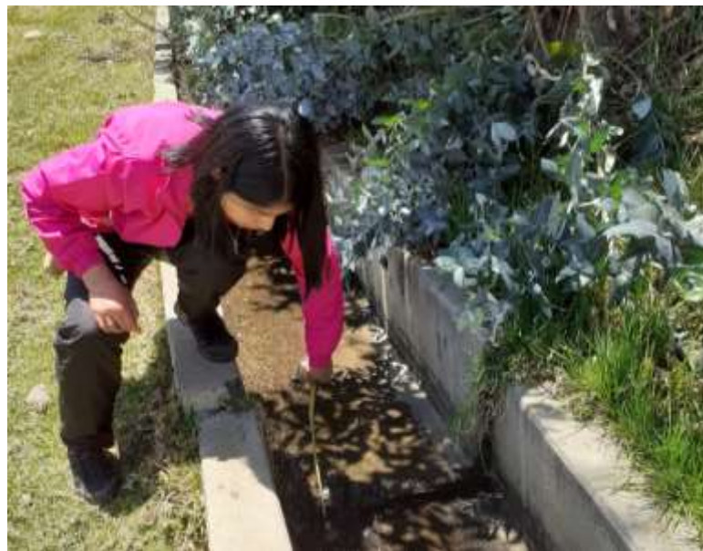
Foto N°04: Medición de las patologías del piso del canal
