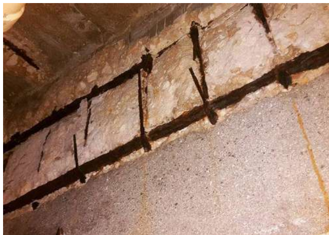
Gráfico: 11 Corrosión en el acero de construcción Fuente: Revista aceros Arequipa 10
