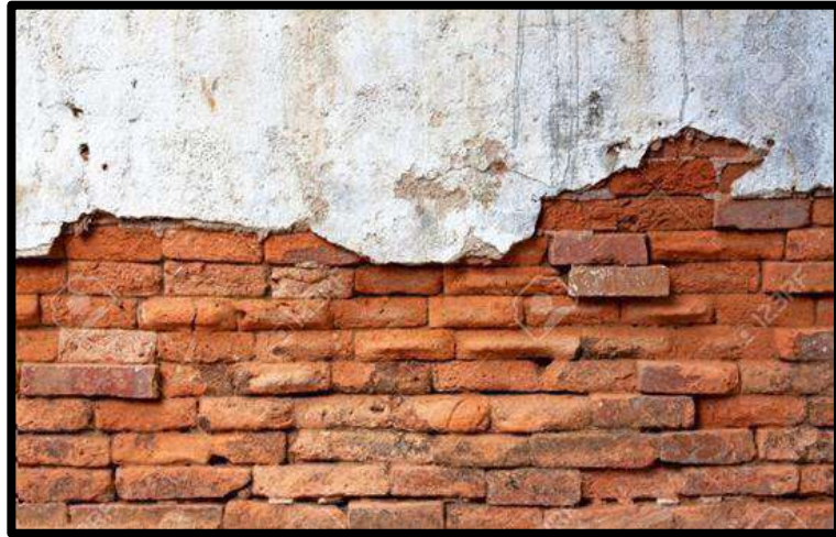
Gráfico: 8 Erosión en el muro de albañilería Fuente: (WANHKIRI J) 23
