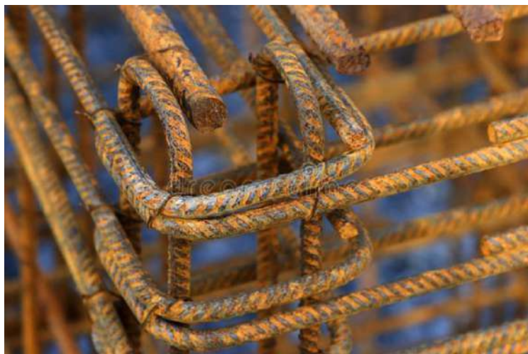
Gráfico 21: Oxidación en el acero de construcción.
