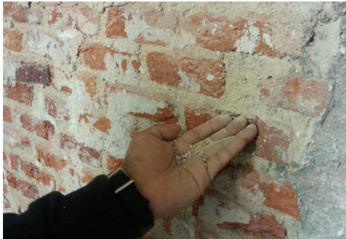
Gráfico 19: desagregación del mortero de asentado.
