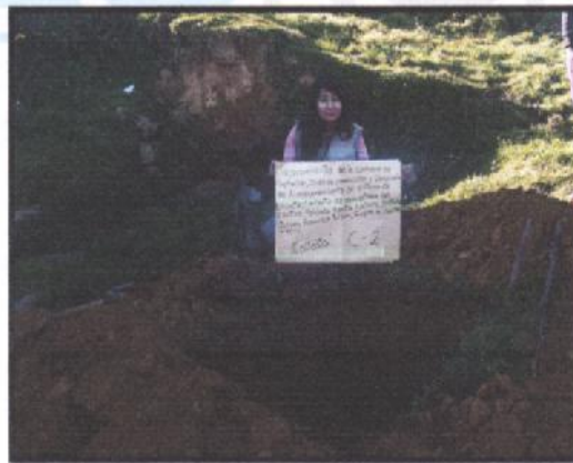
Foto N° 02.- En la toma se aprecia una vista panorámica del lugar donde se excavo la Calicata C-02
