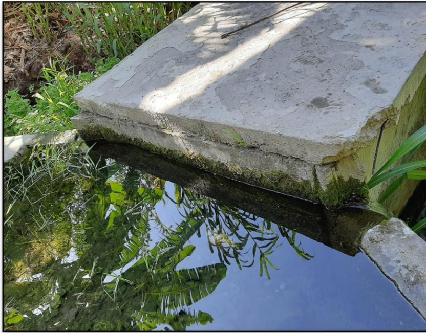
Fotografía 03: Se visualiza el agua estancada en la captación existente.
