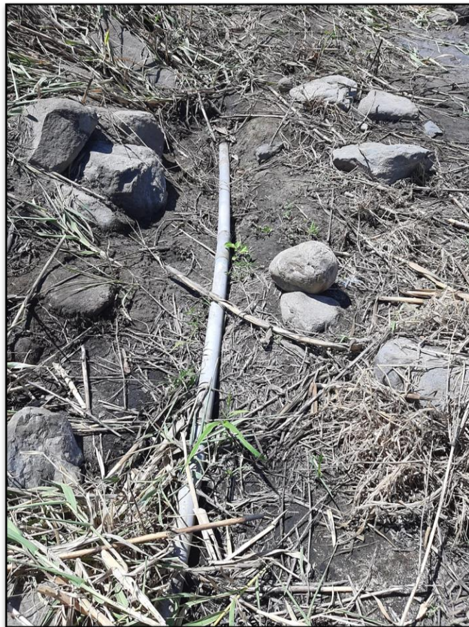
Fotografía 04: Se observa la tubería de la línea de conducción expuesta a la intemperie.
