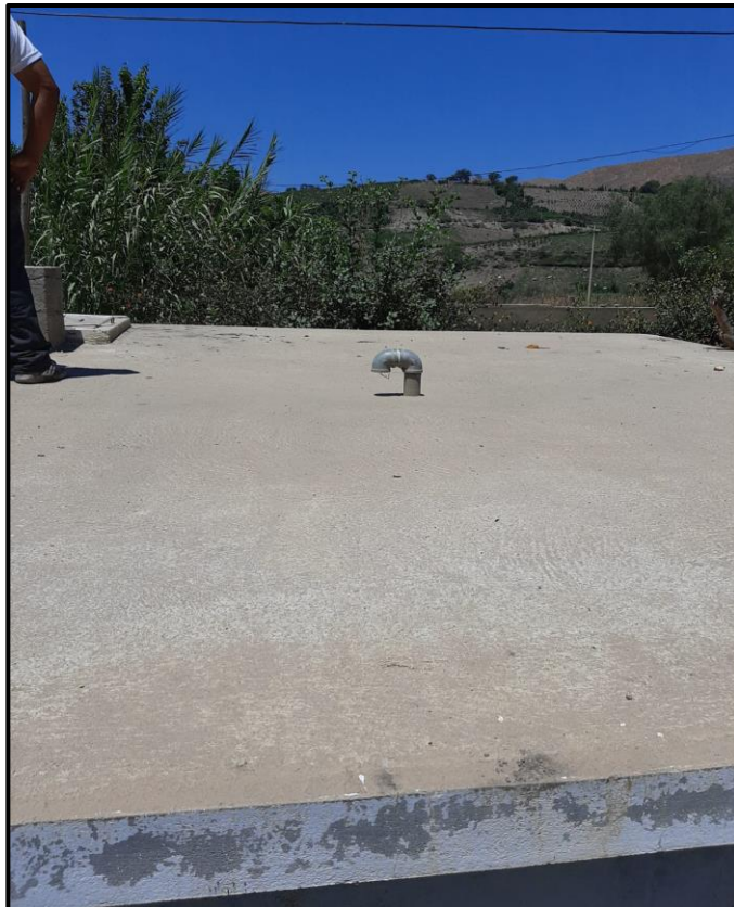
Fotografía 06: Tubo de ventilación PVC en el reservorio existente.
