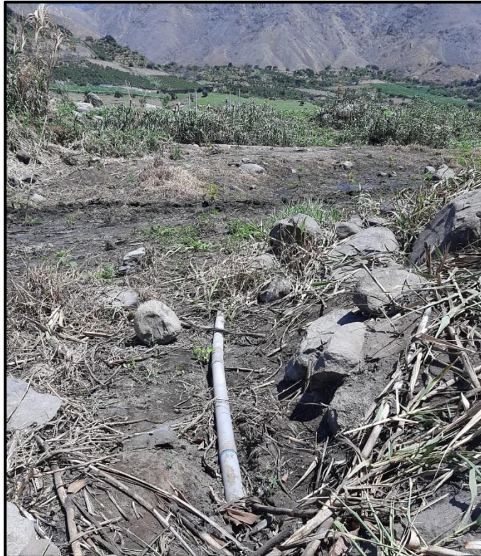
Fotografía 05: Tubo PVC expuesta a la intemperie.
