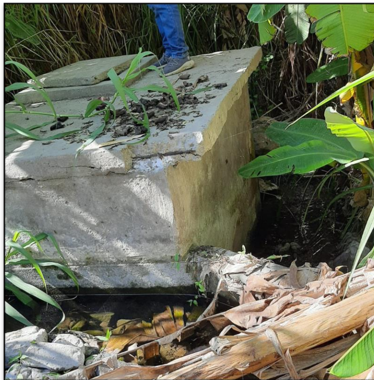
Fotografía 02: Se visualiza la captación existente con algunas deficiencias en la estructura.
