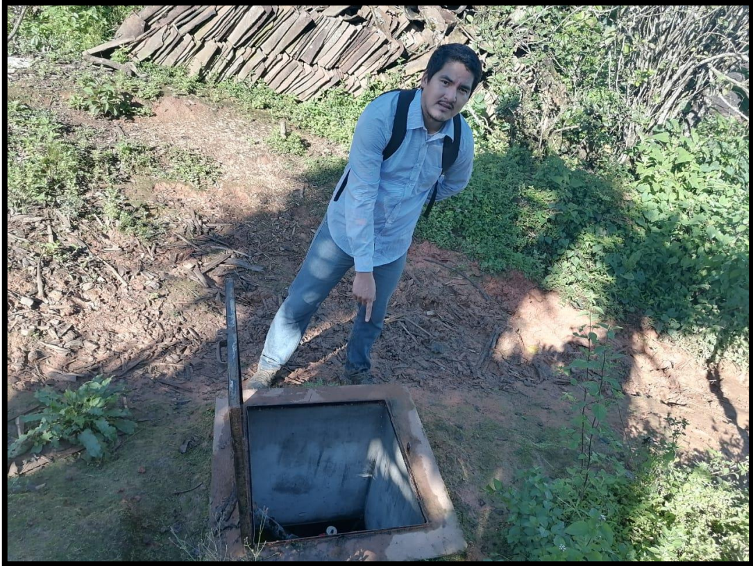
Caja de válvulas deteriorada y en mal estado.
