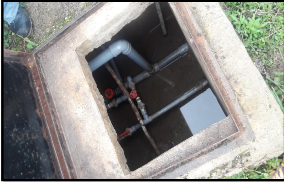
Caja de válvulas deteriorada con filtración y en mal estado.
