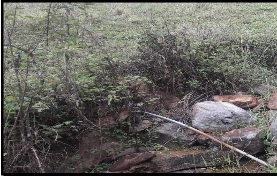
Línea de distribución de 3/4" expuesta a los rayos del sol en mal estado.
