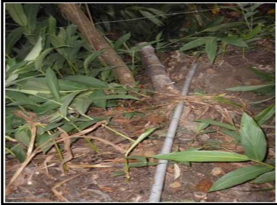
Imagen 01. Tramo de Línea de Conducción
