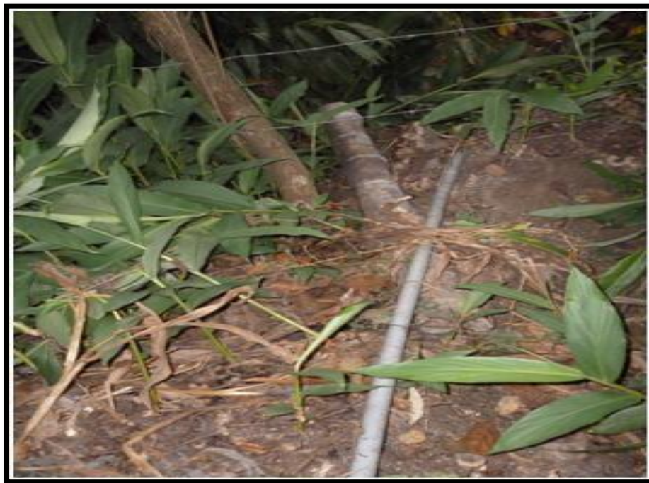
Línea de distribución de 1" a la intemperie e instalada de manera artesanal por los mismos pobladores.
