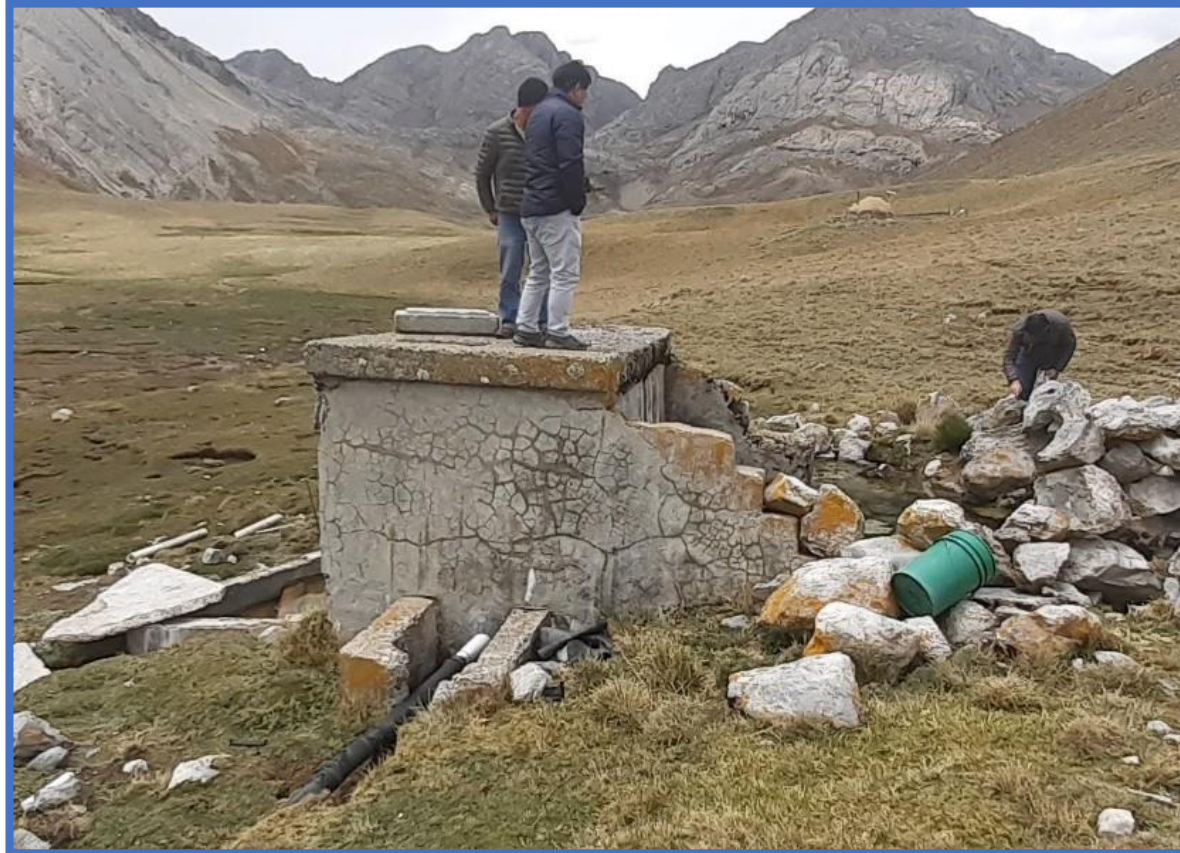
Imagen 1. Captación artesanal de anexo de Corpacancha
