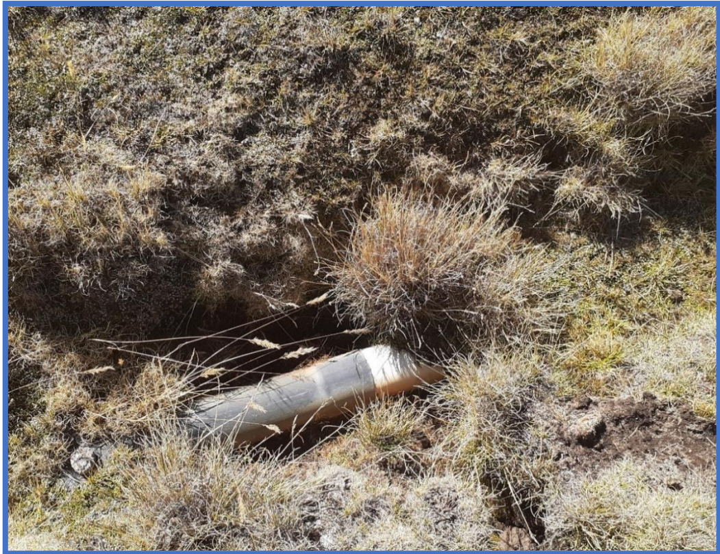
Imagen 4. Línea de aducción
