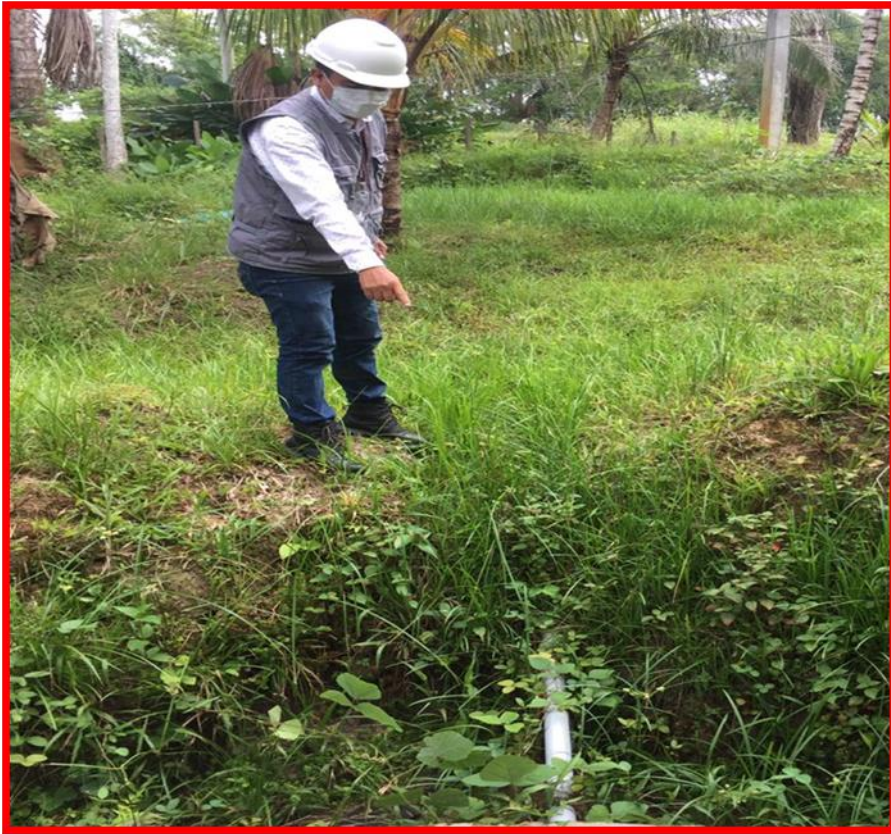
Imagen 14. Tubería de la línea de conducción
