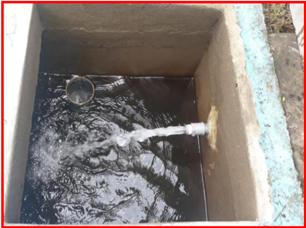
Imagen 10. Cámara húmeda de la CRP6 actual
