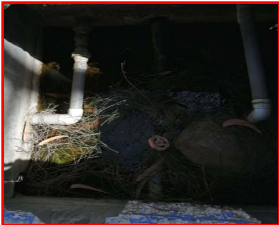
Imagen 05. Accesorios de la caseta de válvulas del reservorio
