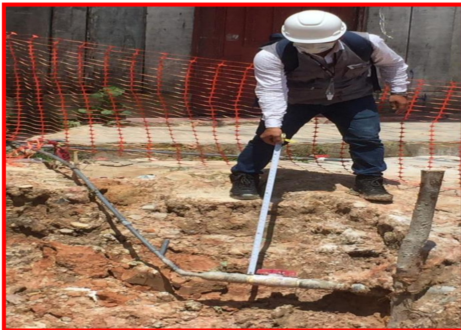
Imagen 17. Red de distribución (tubería secundaria)
