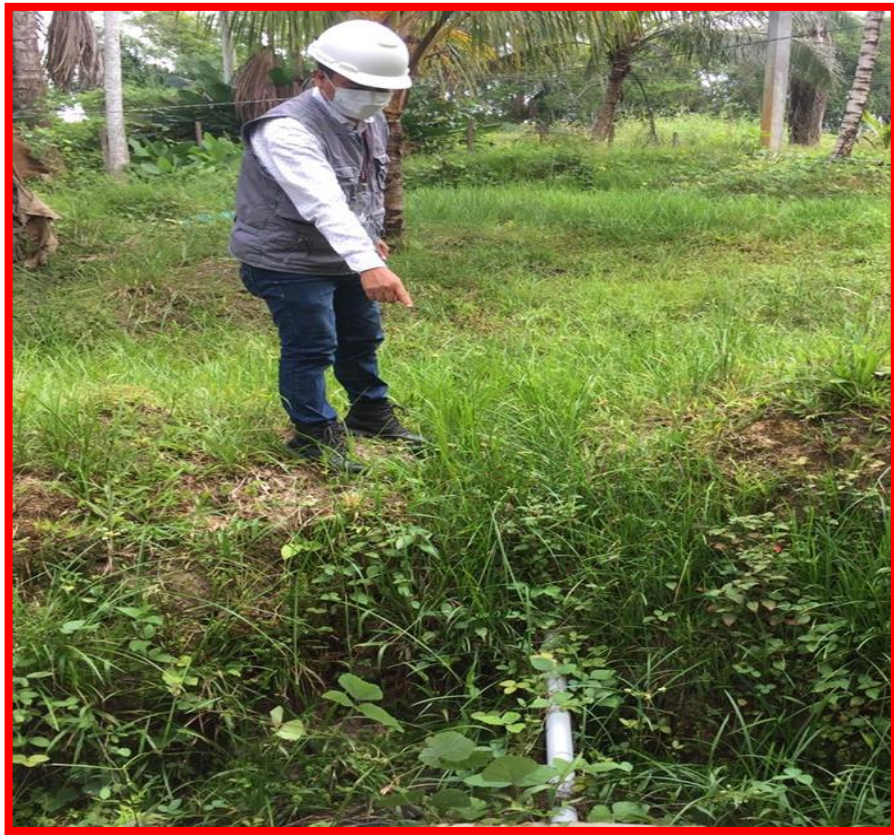
Imagen 03. Línea de conducción tramo 1 expuesta a la intemperie
