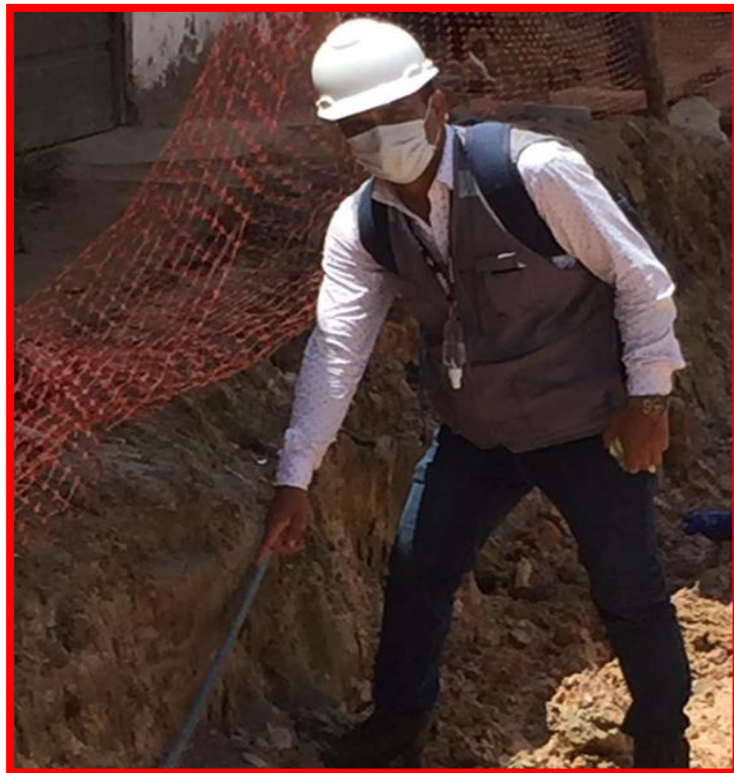
Imagen 09. Red de distribución expuesta a la intemperie (tubería secundaria)
