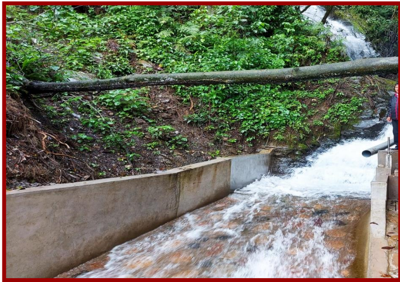
Figura 3. Captación una fuente superficial (río).
