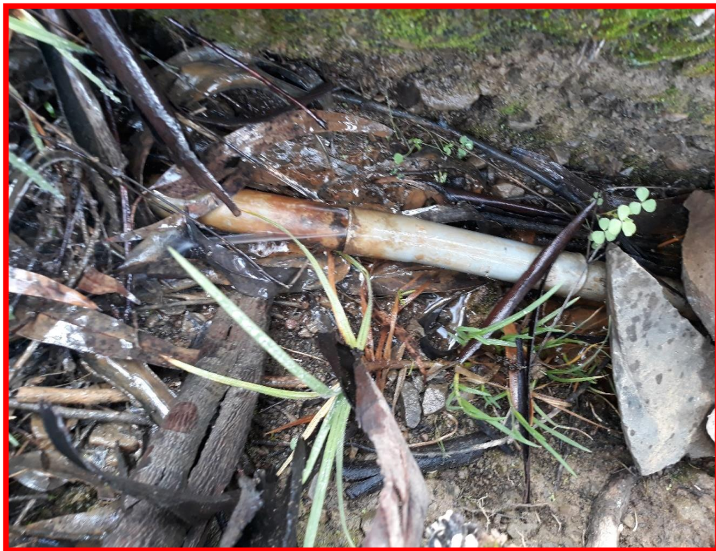
Imagen 06. Patologías presentadas en la tubería de la línea de aducción
