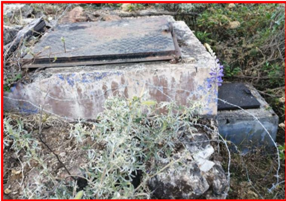
Imagen 13. Captación Huargopata (Cámara húmeda y seca deterioradas)
