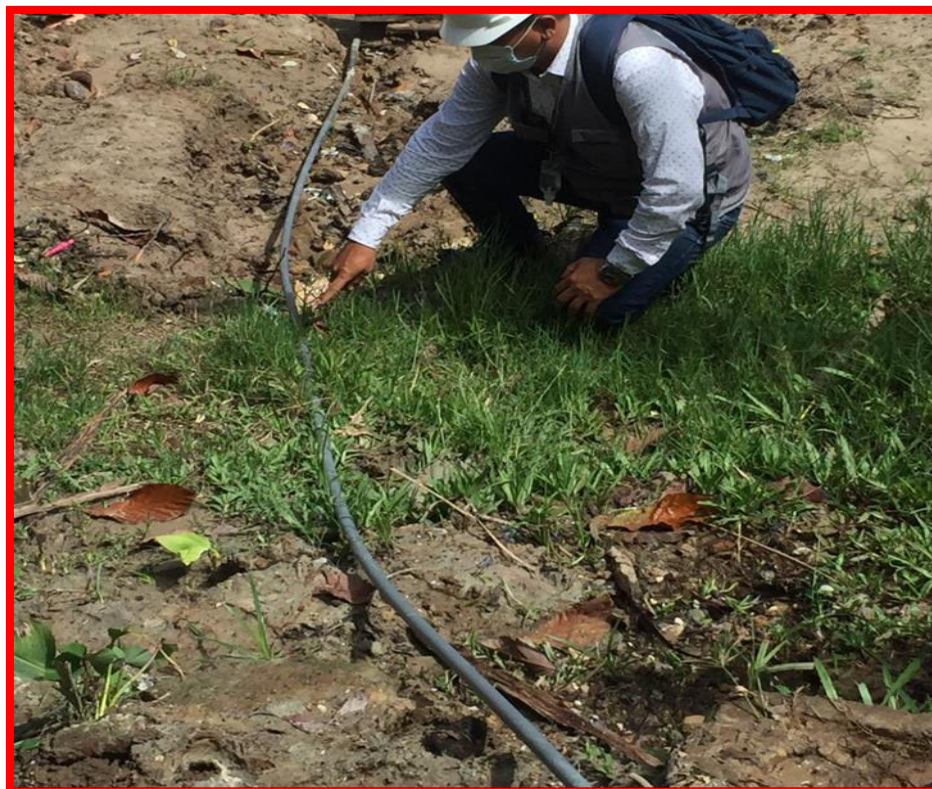
Imagen 07. Línea de aducción expuesta a peligros de la zona
