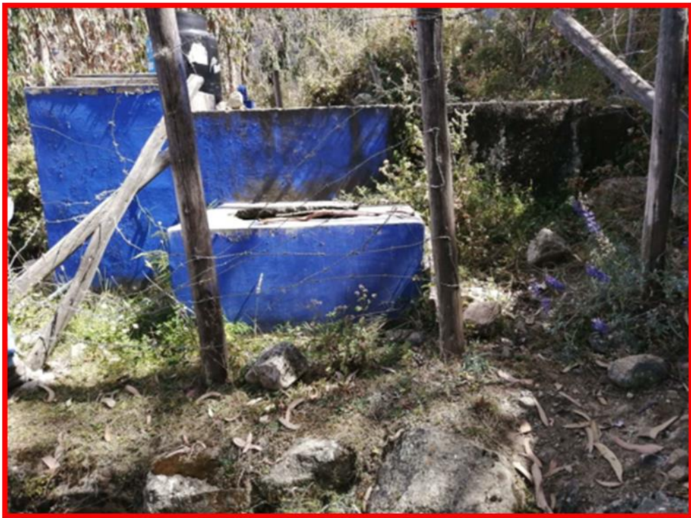
Imagen 15. Reservorio de almacenamiento del caserío Huargopata
