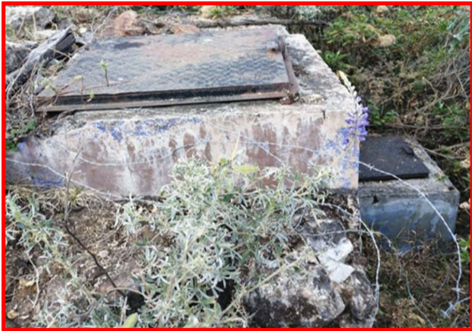
Imagen 01. Captación actual del caserío de Hurgopata sin cerco perimétrico de protección y en malas condiciones partes de la estructura.
