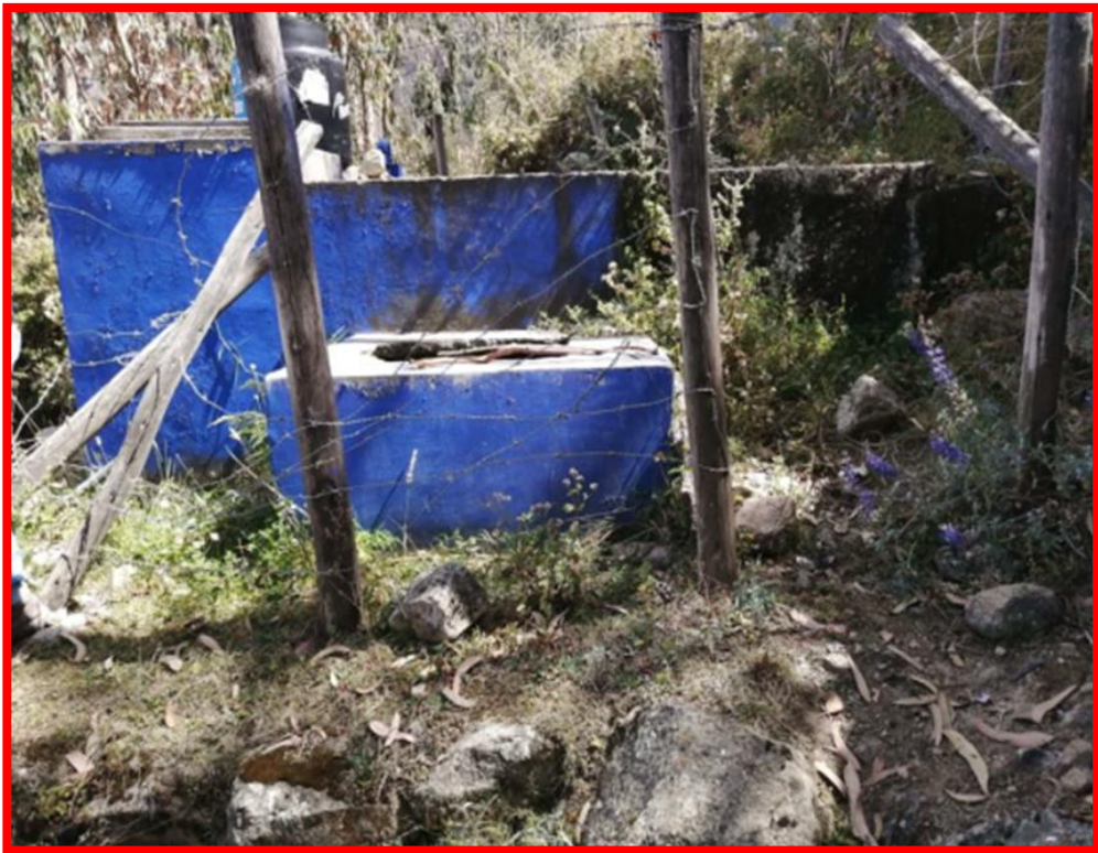
Imagen 04. Reservorio de almacenamiento con cerco perimétrico rustico expuesto a contaminación
