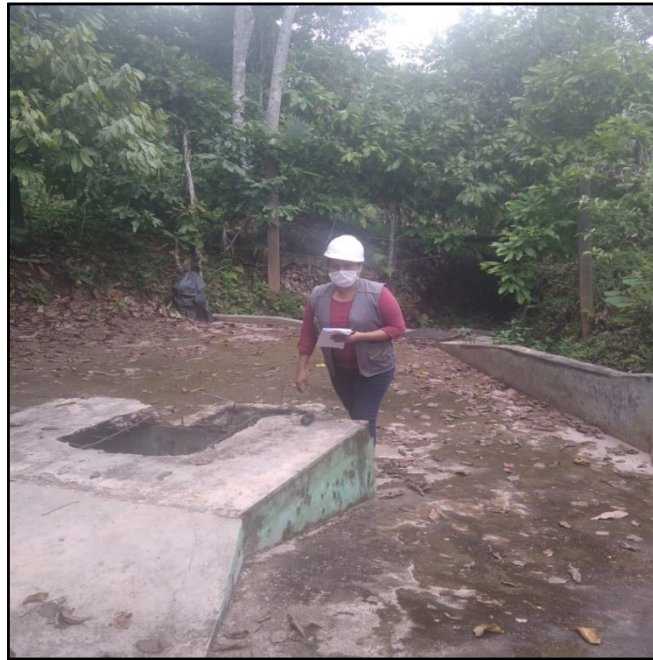
Figura 1: Se aprecia la captación de José Gálvez deteriorada por el tiempo y la falta de mantenimiento por parte de los pobladores.
