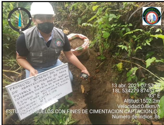
Figura 24: Calicata de la captación a proyectarse (estudio de suelos) Fuente: Elaboración propia
