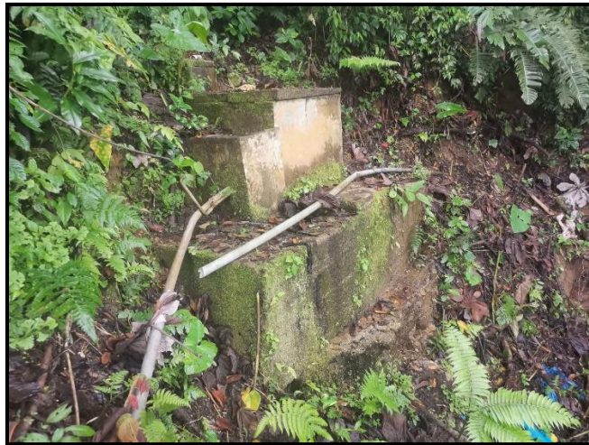
Figura 20: Captación existente en mal estado Fuente: Elaboración propia
