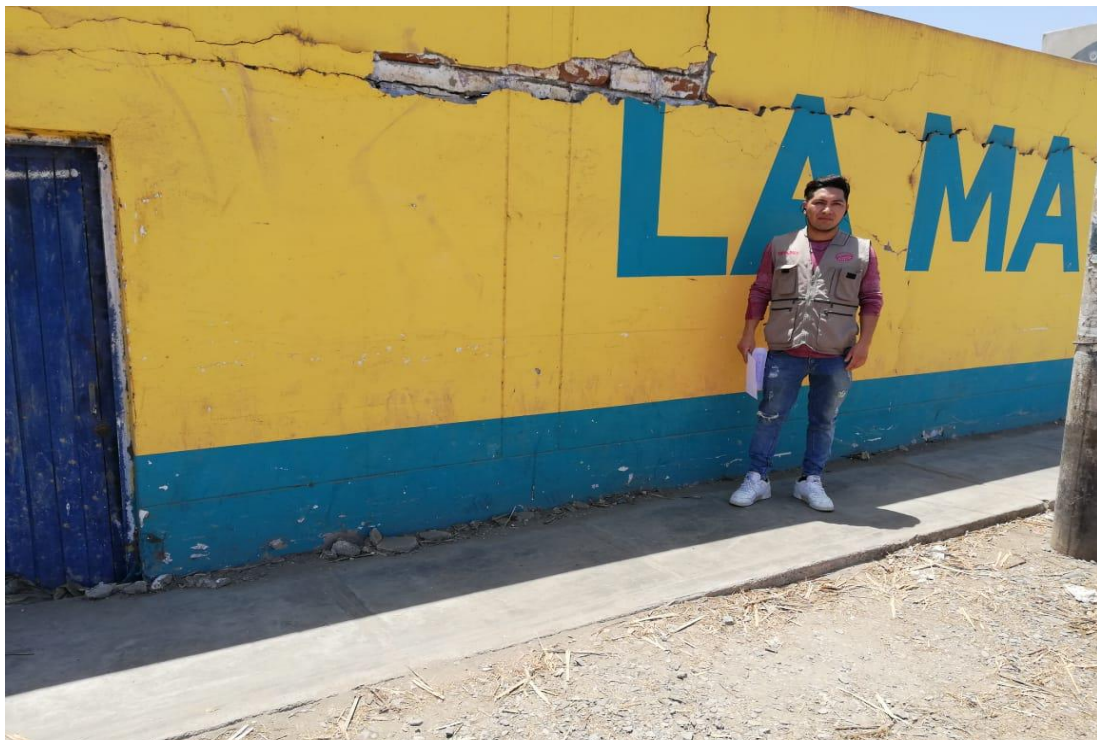
Gráfico 24. Fotografía de grietas y desprendimientos en los muros de albañilería Fuente: Elaboración Propia, 2019.
