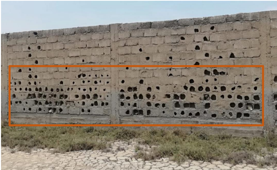
Gráfico 22. Fotografía de muro afectado por erosión Fuente: Elaboración Propia, 2019.
