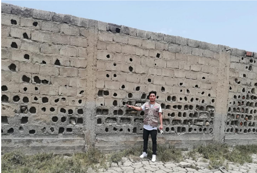
Gráfico 25. Fotografía de la erosión que afecta el muro de albañilería Fuente: Elaboración Propia, 2019.
