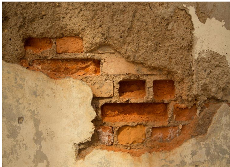
Gráfico 8 . Fotografía de erosión en muros (Fuente: Pexels. 2013)
