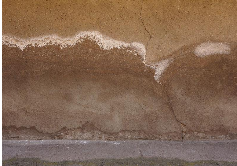
Gráfico 11. Fotografía de Eflorescencia en muro (Fuente: Montó. 2017)
