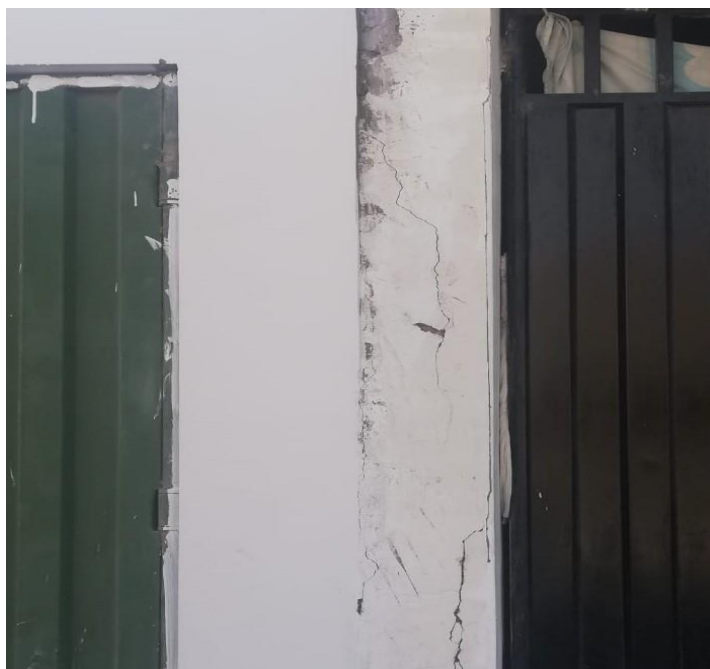
Gráfico 10. Fotografía de fisura en columnas (Fuente. Investigación propia. 2019)
