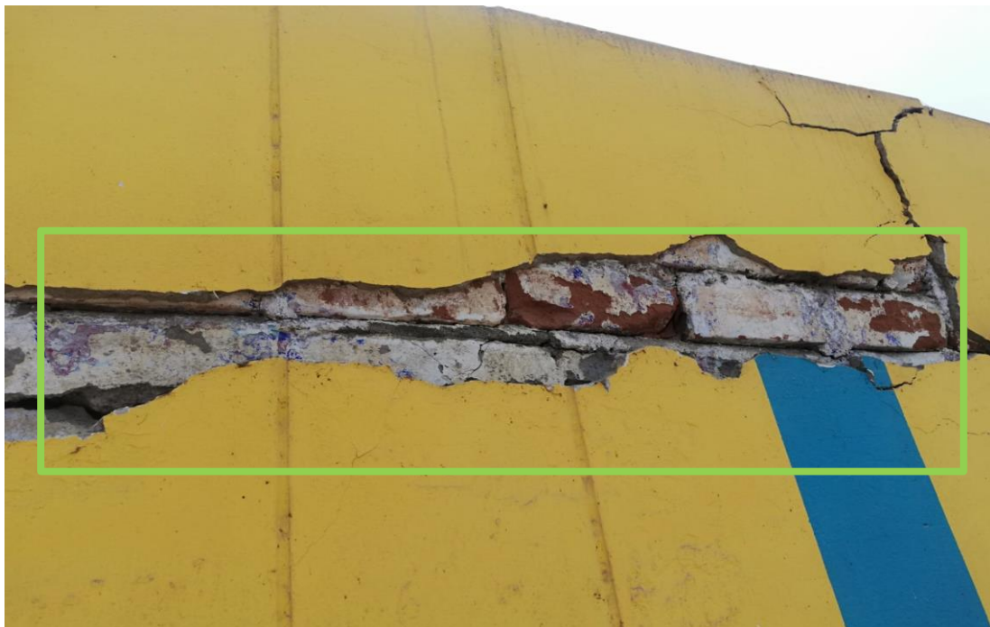
Gráfico 23. Fotografía de muro afectado por desprendimiento de tarrajeo Fuente: Elaboración Propia, 2019.
