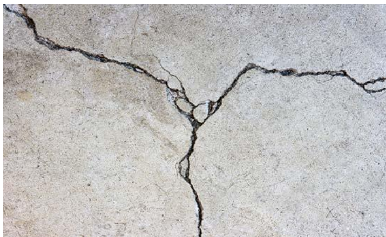
Gráfico 9. Fotografía de grietas en muros (Fuente. Ideco. 2018)
