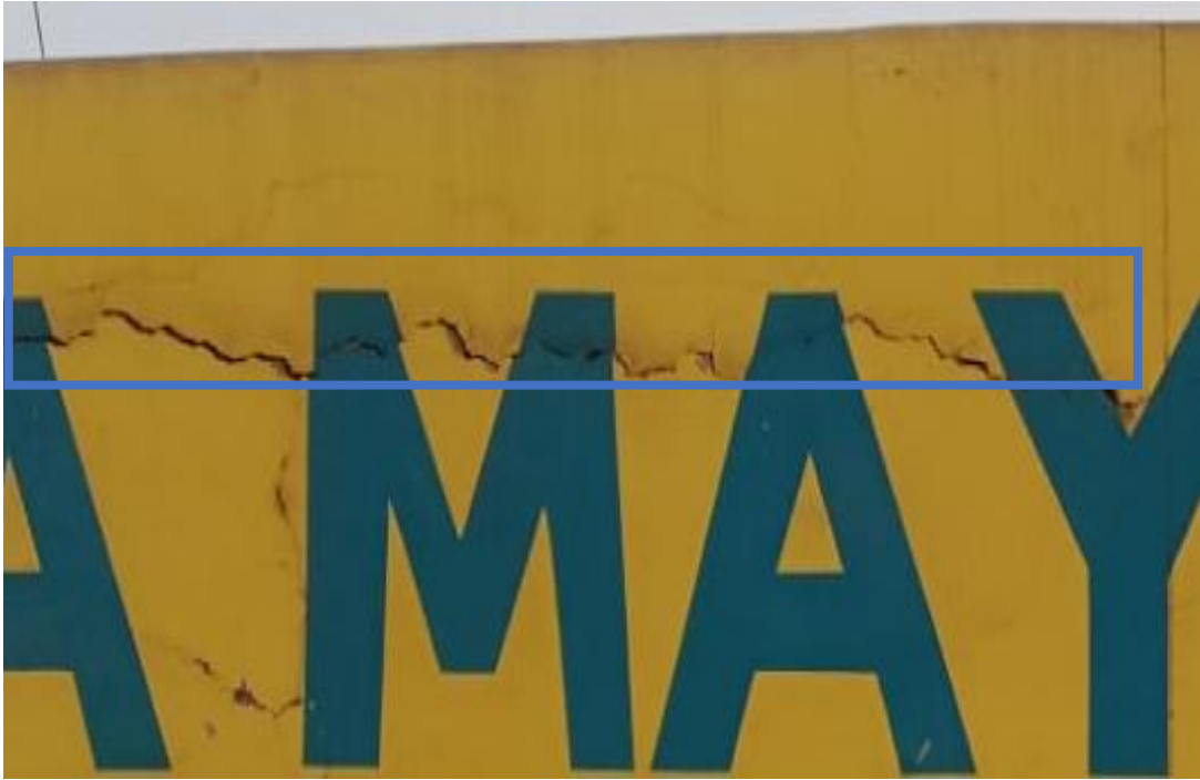
Gráfico 20. Fotografía de muro afectado por grieta en la muestra 03
