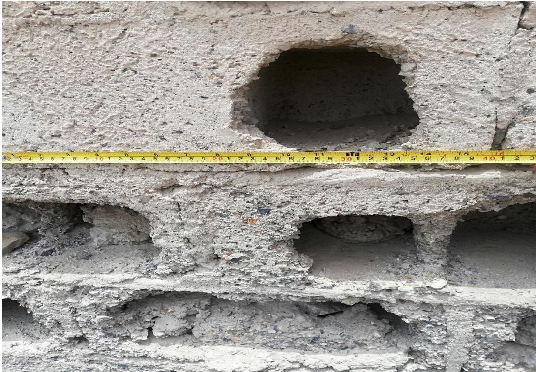
Gráfico 26. Fotografía de área afectada por erosión
