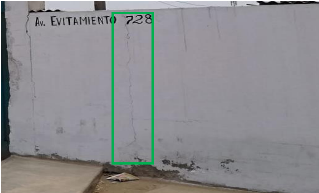
Gráfico 21. Fotografía de muro afectado por fisura en la UM 08
