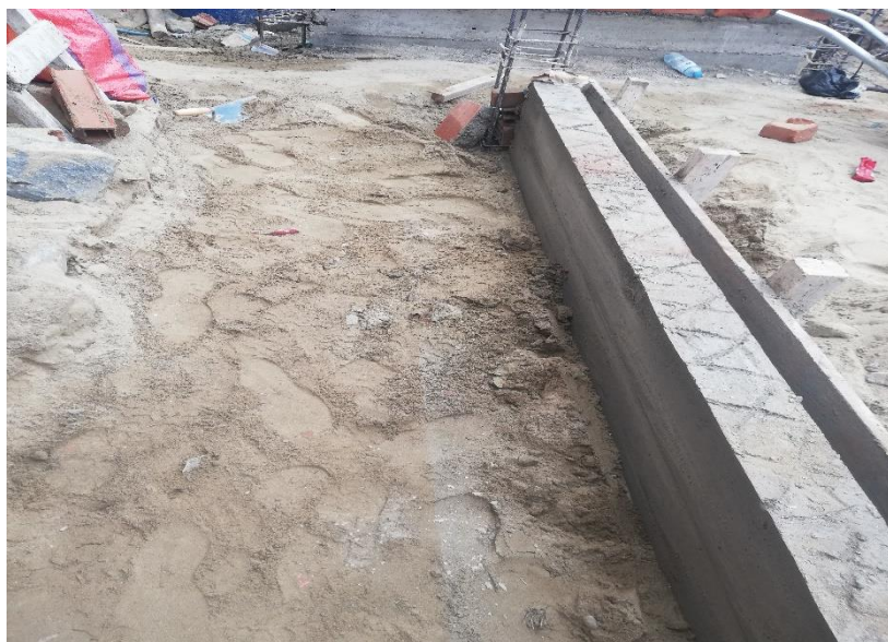
Gráfico 5 . Fotografía de sobrecimiento de una vivienda (Fuente: Investigación propia. 2019)
