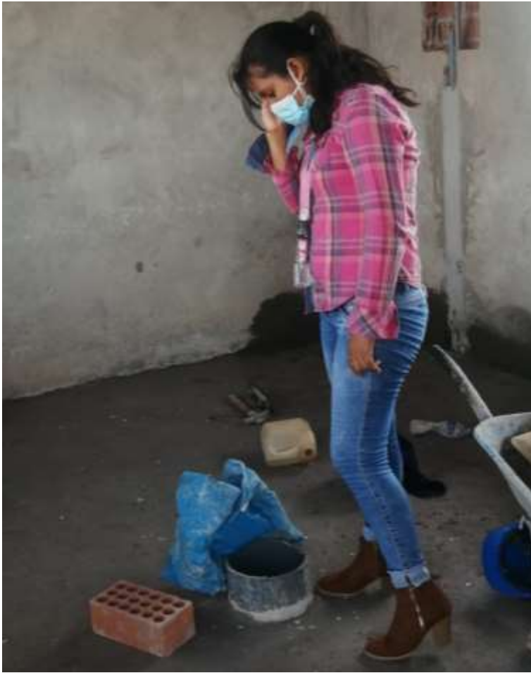
Imagen 3. Pozo tubular existente, no cuenta con válvulas de control
