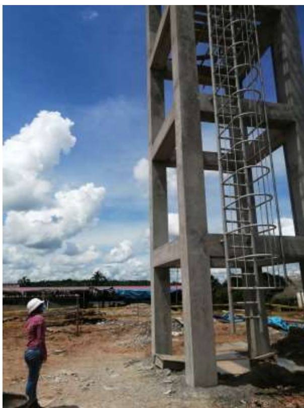
Imagen 12. Tanque elevado del sector 02 caserío Monte de los Olivos
