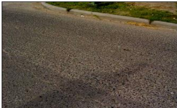
Figura 2. 22: Desprendimiento de agregados
