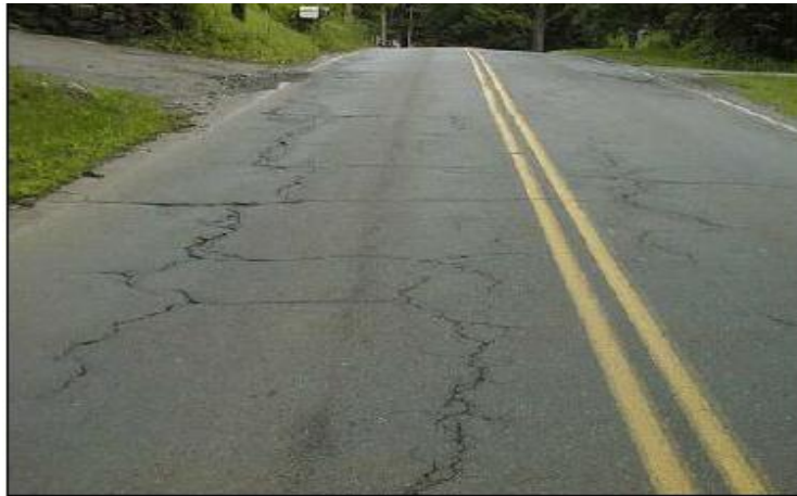
Figura 2. 8: Agrietamiento en bloque
