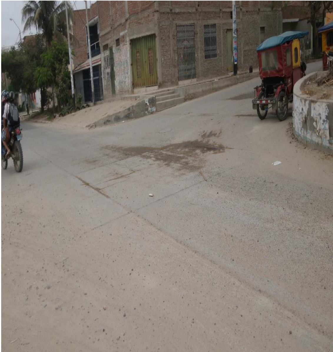
FOTOGRAFÍA N° 07. Presencia de desplazamiento en el pavimento
