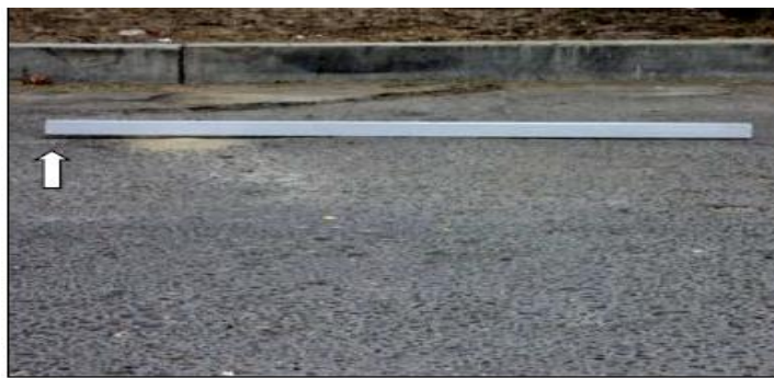
Figura 2. 9: Abultamiento y hundimiento
