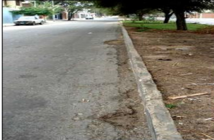
Figura 2. 12: Grieta de borde
