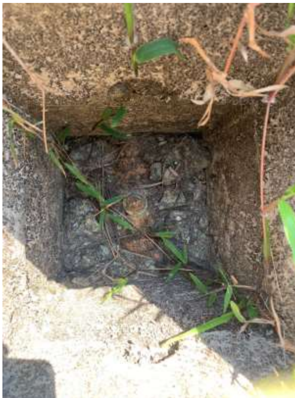
FOTOGRAFIA 06: ESTADO DE LA LLAVE DE PASO PARA LA TUBERIA DE IMPULSION
