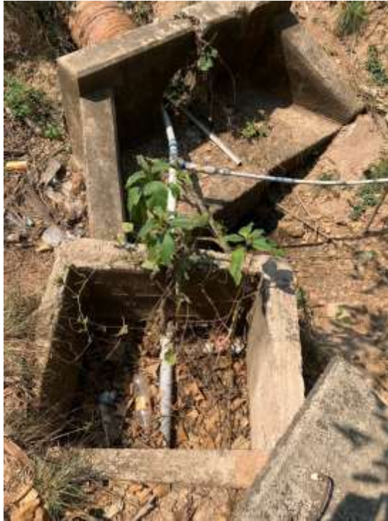
FOTOGRAFIA 05: TUBERAS EXPUESTAS DEL CENTRO POBLADO EL TRIUNFO
