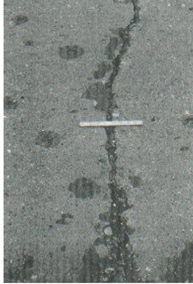
Figura 17. Grietas lineales de severidad media en losa de concreto reforzado. Fuente: ASTM D6433-03.
