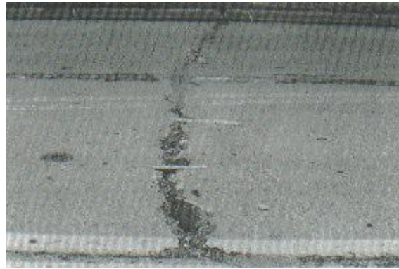
Figura 18. Grietas lineales de severidad alta en losa de concreto simple. Fuente: ASTM D6433-03.
