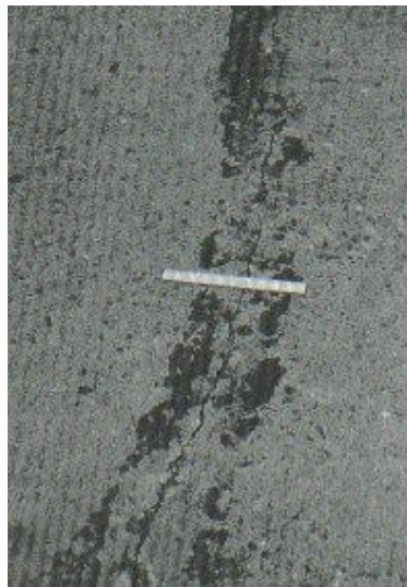
Figura 16. Grietas lineales de severidad baja en losa de concreto simple.
