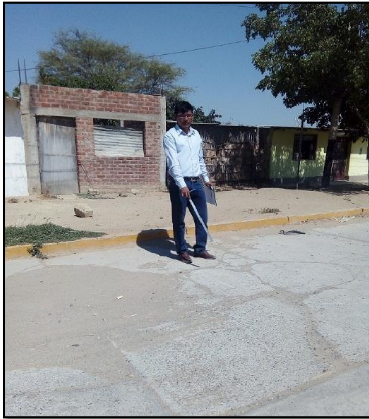
Figura D7. Pavimento con presencia de losa dividida ubicado en la Avenida El Cementerio. Fuente: Elaboración propia.
