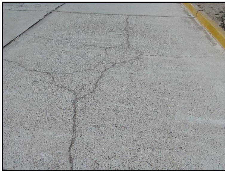
Figura D10. Pavimento con presencia de losa dividida ubicado en Calle José Carlos Mariátegui. Fuente: Elaboración propia.
