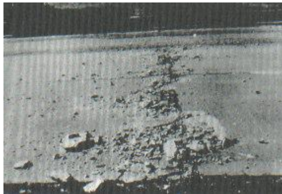
Figura 2. Blowup/Buckling de severidad media. Fuente: ASTM D6433-03.
