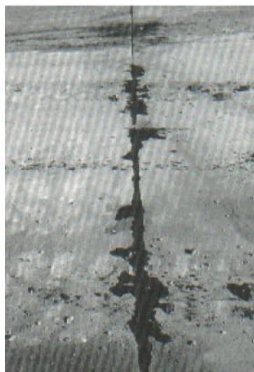
Figura 19. Bombeo de severidad baja. Fuente: ASTM D6433-03.
