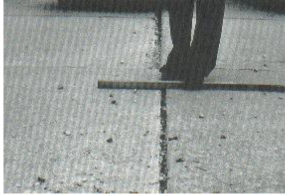
Figura 13. Escala de severidad baja. Fuente: ASTM D6433-03.
