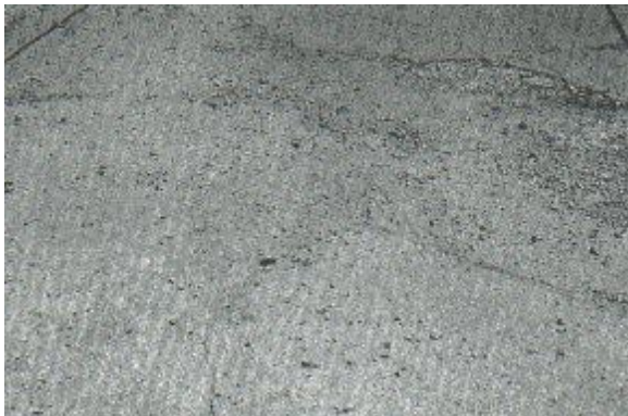
Figura 12. Grieta de durabilidad de severidad alta. Fuente: ASTM D6433-03.
