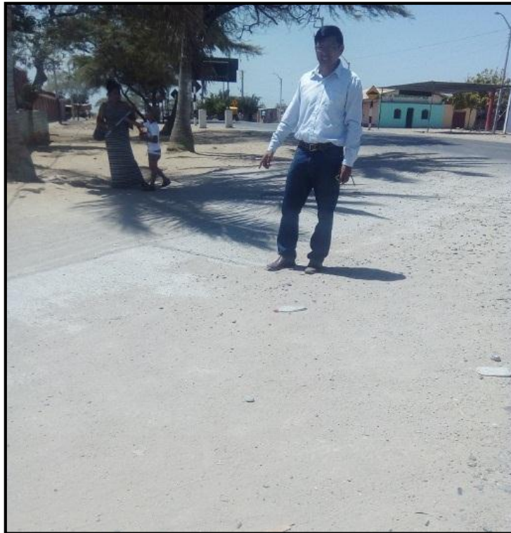
Figura D3. Pavimento con presencia de pulimento de agregados ubicado en la Avenida El Cementerio. Fuente: Elaboración propia.
