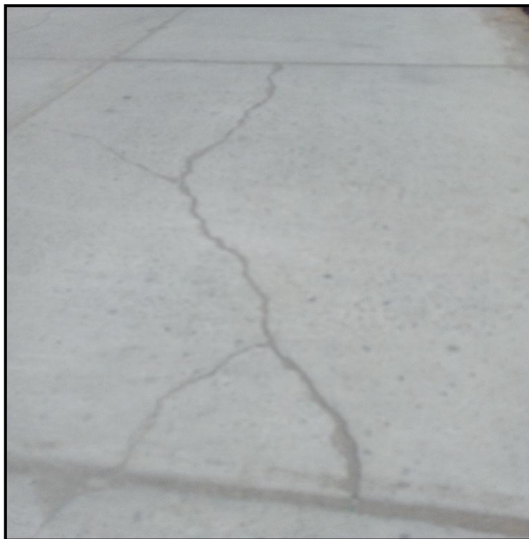
Figura D4. Pavimento con presencia de losa dividida ubicado en la Avenida El Cementerio. Fuente: Elaboración propia.
