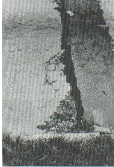
Figura 1. Blowup/Buckling de severidad baja. Fuente: ASTM D6433-03.
