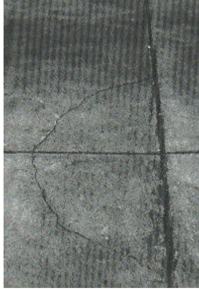
Figura 4. Grieta de esquina de severidad baja. Fuente: ASTM D6433-03.
