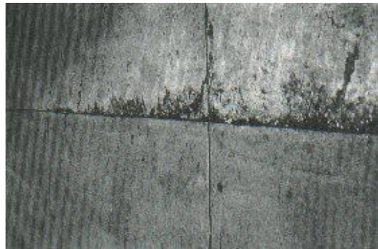
Figura 34. Descascaramiento de junta de severidad media.
