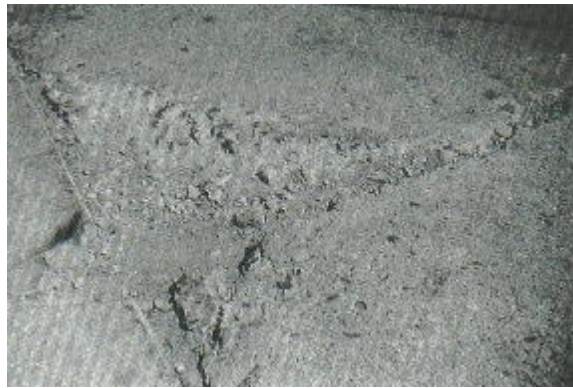
Figura 31. Descascaramiento de esquina de severidad alta. Fuente: ASTM D6433-03.
