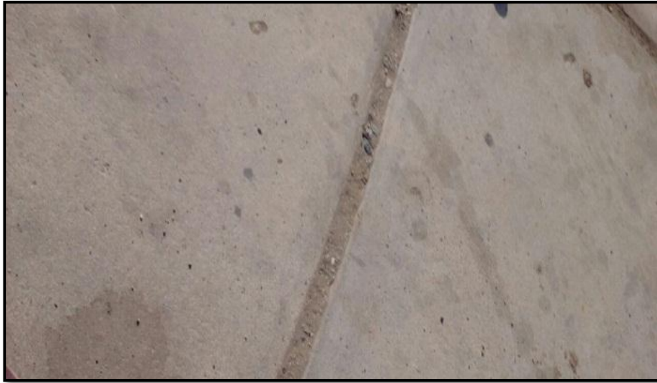
Figura D11. Pavimento con presencia de pulimento de agregados ubicado en Calle José Carlos Mariátegui. Fuente: Elaboración propia.
