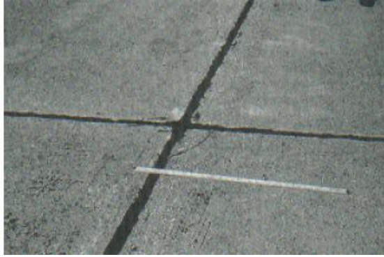
Figura 29. Descascaramiento de esquina de severidad baja. Fuente: ASTM D6433-03.
