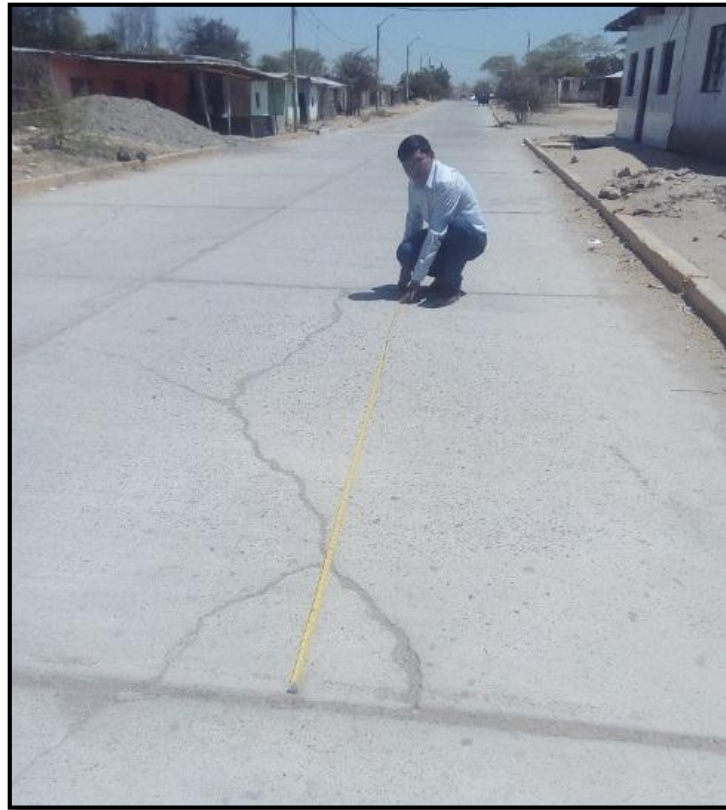
Figura D5. Medición de pacho del pavimento ubicado en la Avenida El Cementerio. Fuente: Elaboración propia.
