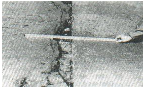
Figura 35. Descascaramiento de junta de severidad alta.
