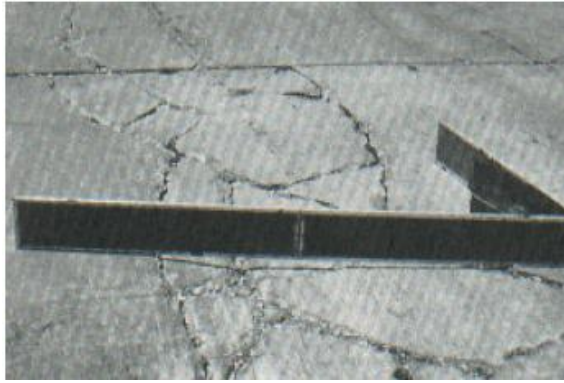
Figura 24. Punzonamiento de severidad alta.
