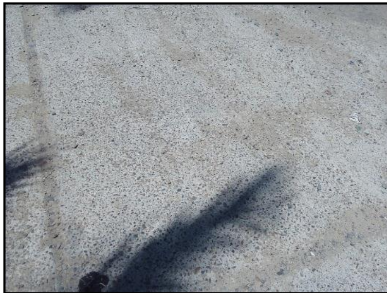
Figura D2. Pavimento con presencia de pulimento de agregados ubicado en la Avenida El Cementerio. Fuente: Elaboración propia.
