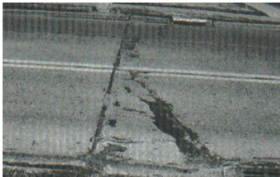
Figura 23. Punzonamiento de severidad media. Fuente: ASTM D6433-03.
