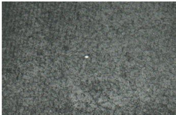
Figura 25. Desconchamiento/Mapa de grietas/Craquelado de severidad baja. Fuente: ASTM D6433-03.
