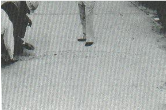
Figura 11. Grieta de durabilidad de severidad media. Fuente: ASTM D6433-03.
