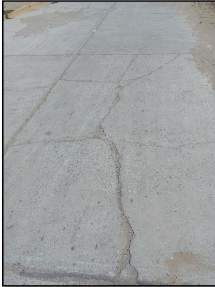
Figura D9. Pavimento con presencia de losa dividida ubicado en Calle José Carlos Mariátegui. Fuente: Elaboración propia.
