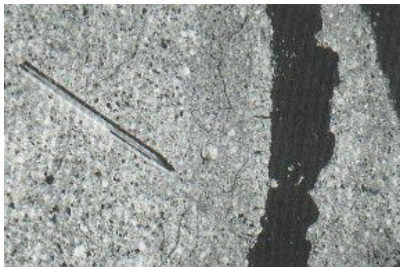
Figura 10. Grieta de durabilidad de severidad baja. Fuente: ASTM D6433-03.
