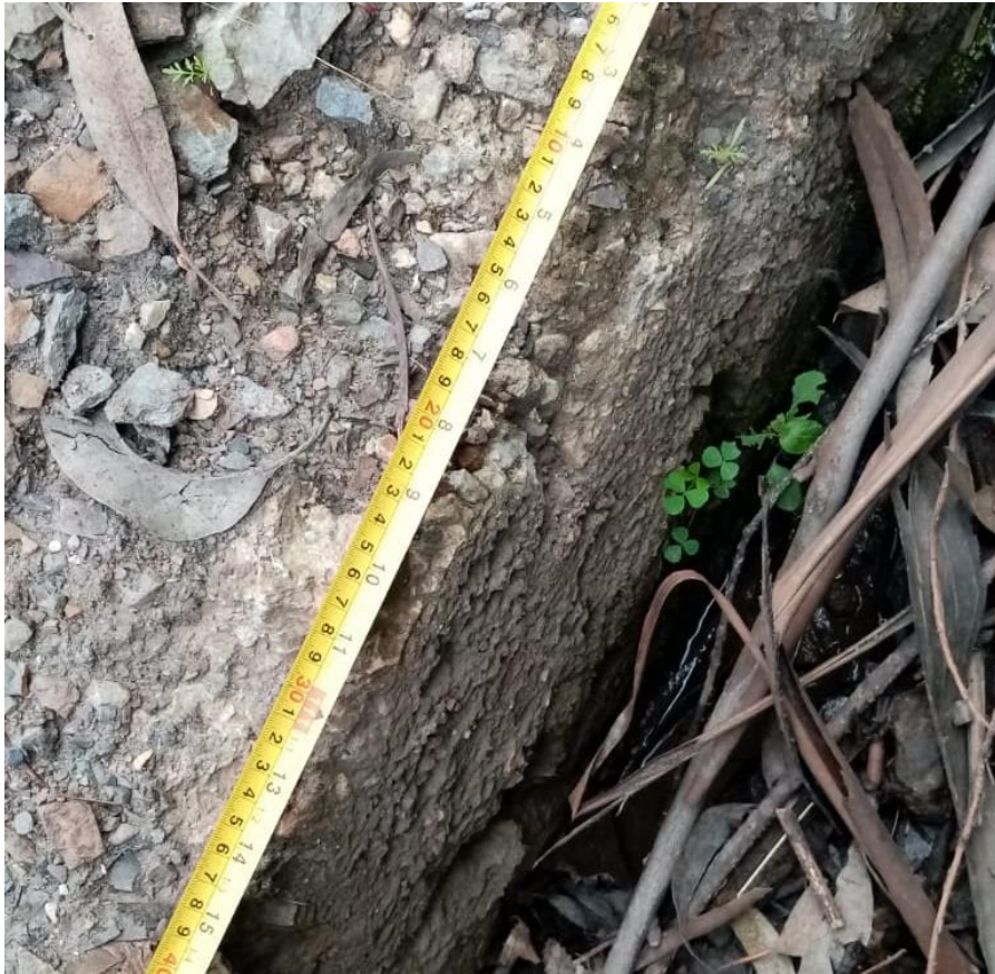
Imagen 5. Erosión en canal
