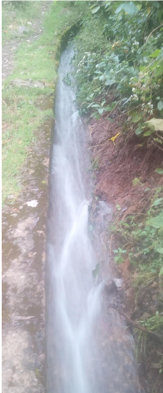
Imagen 10. Desprendimiento de la pared del canal I
