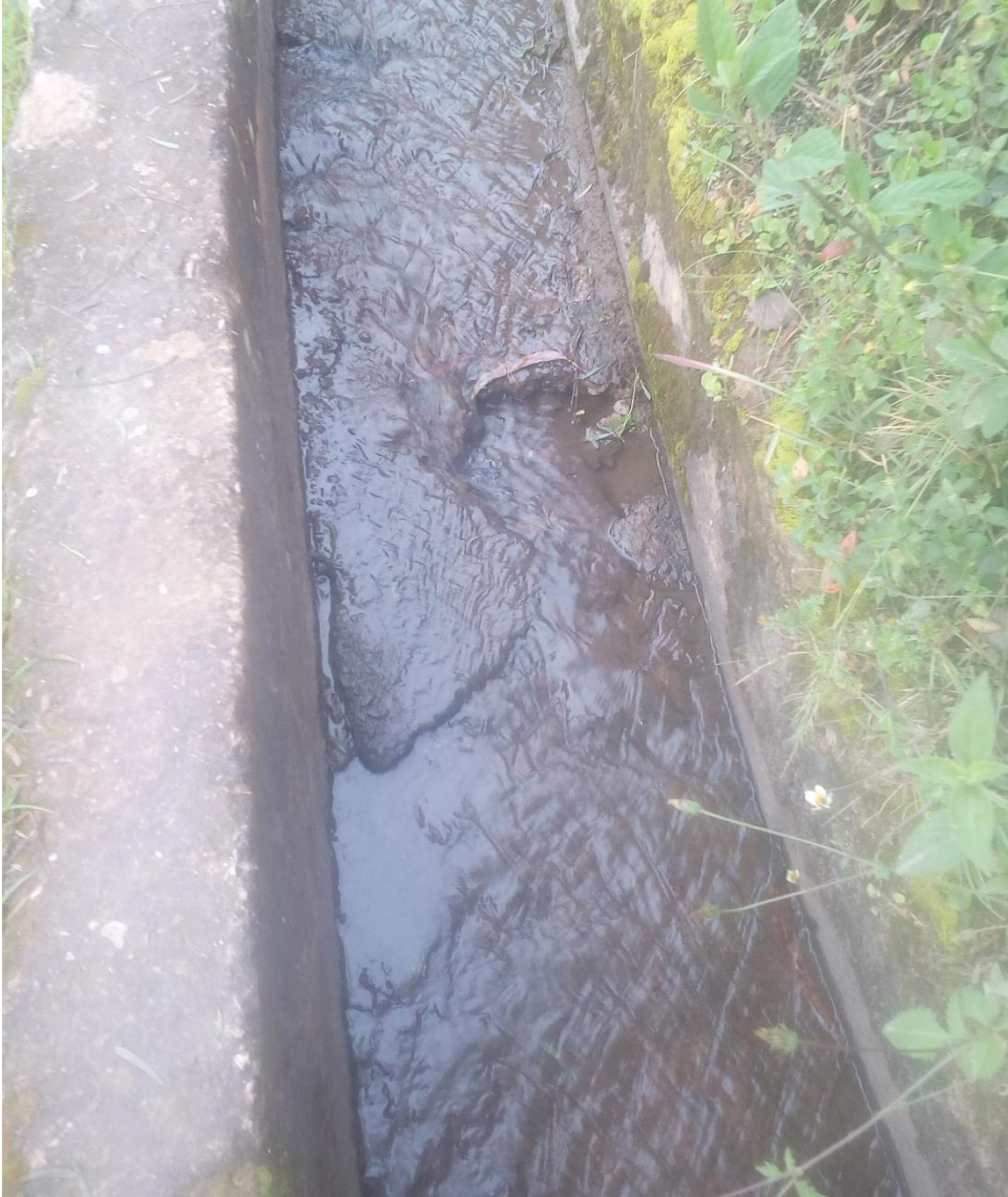
Imagen 18. Se aprecia la corrosión de la base del canal
