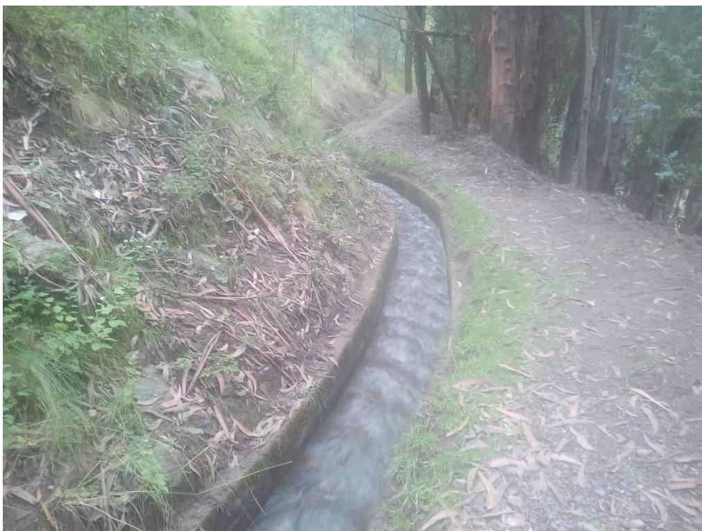
Imagen 14. Se puede observar un tramo del canal
