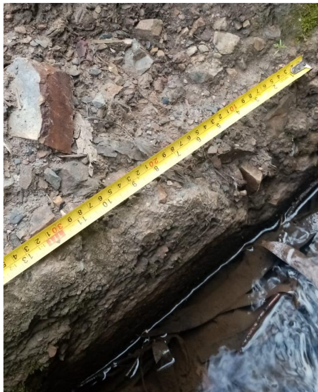
Imagen 12. Patología de impacto en el canal
