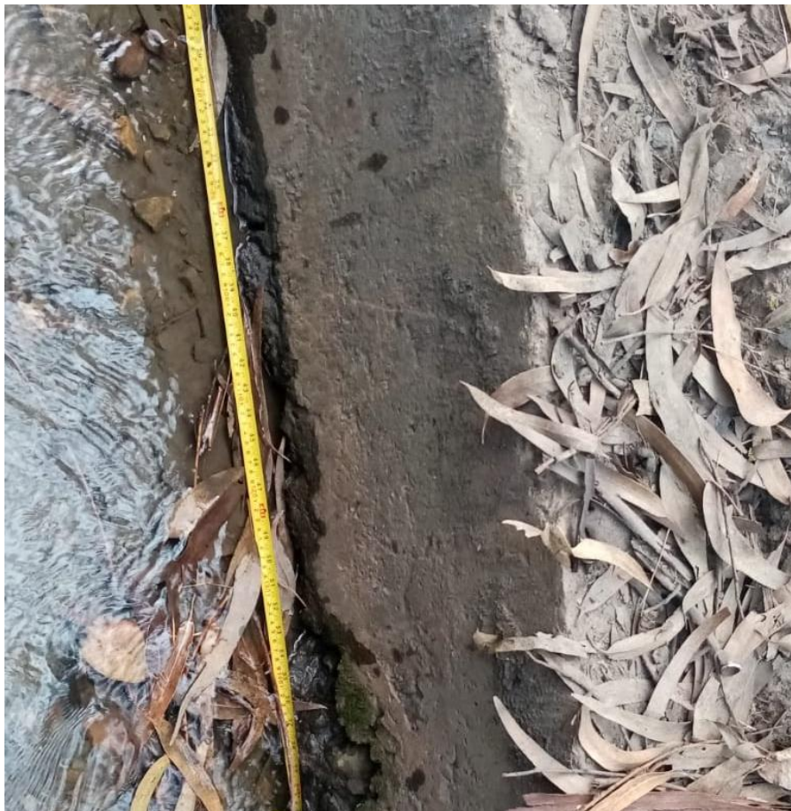
Imagen 2. Erosión en el canal
