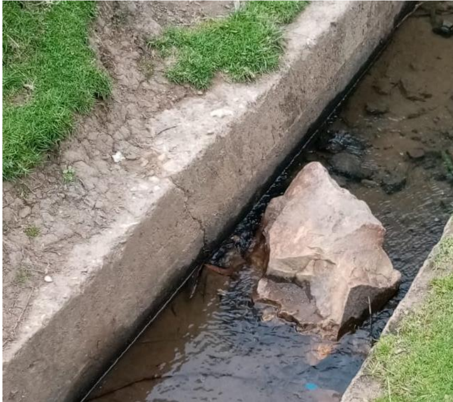
Imagen 7. Fisura en canal
