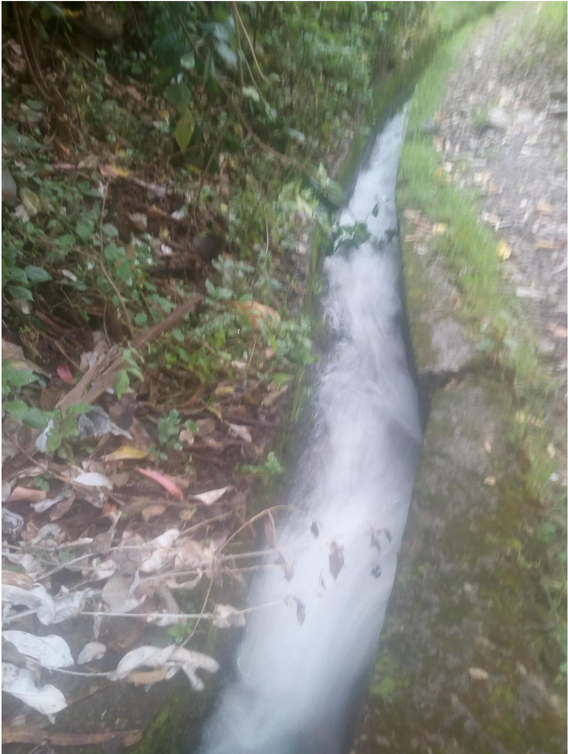
Imagen 19. Se aprecia una grieta en las paredes del canal
