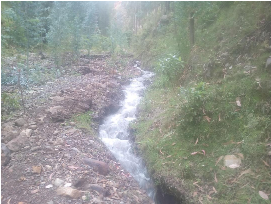
Imagen 17. Se puede observar en la foto que ya se perdió el recubrimiento de concreto
