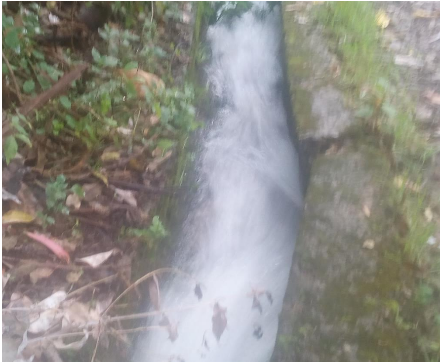
Imagen 1. Grieta en el canal
