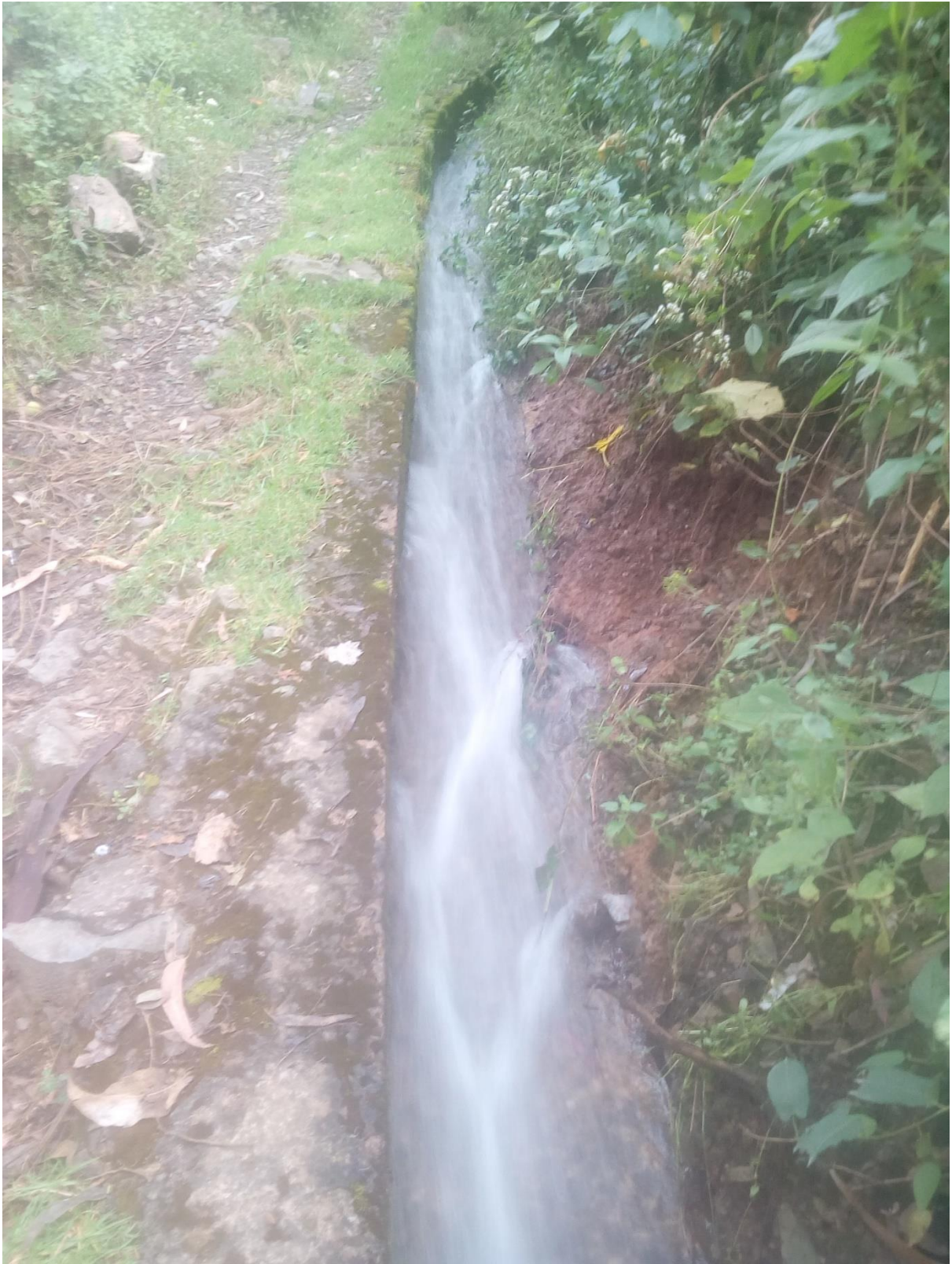
Imagen 1. Se aprecia que la pared del canal en ese tramo desapareció
