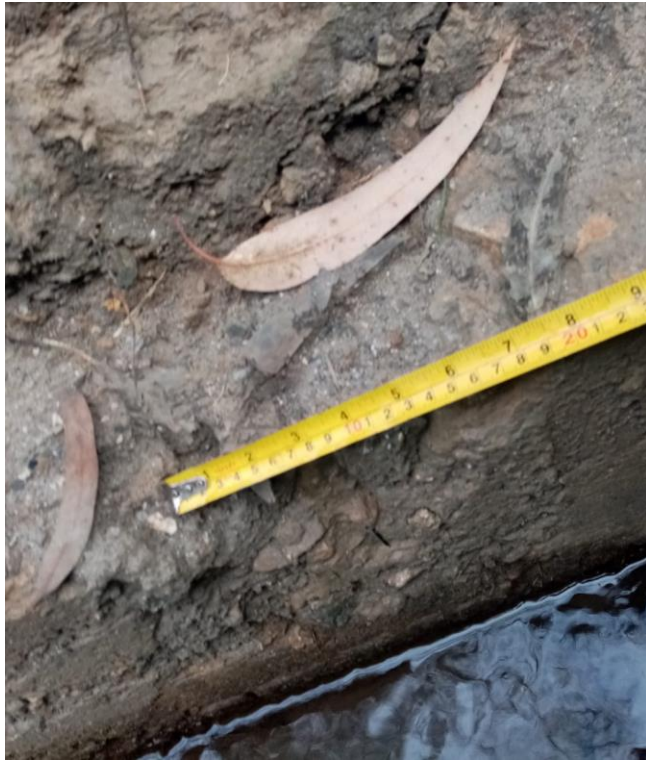
Imagen 11. Patología de impacto en el canal
