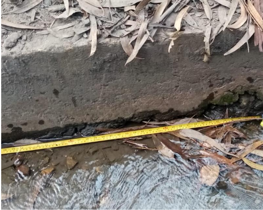
Imagen 3. Erosión en el canal
