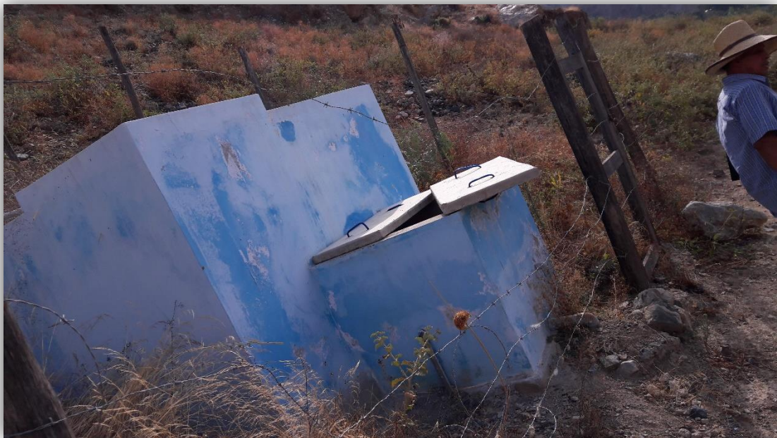
Imagen N° 04: Reservorio de almacenamiento de agua potable del caserío
