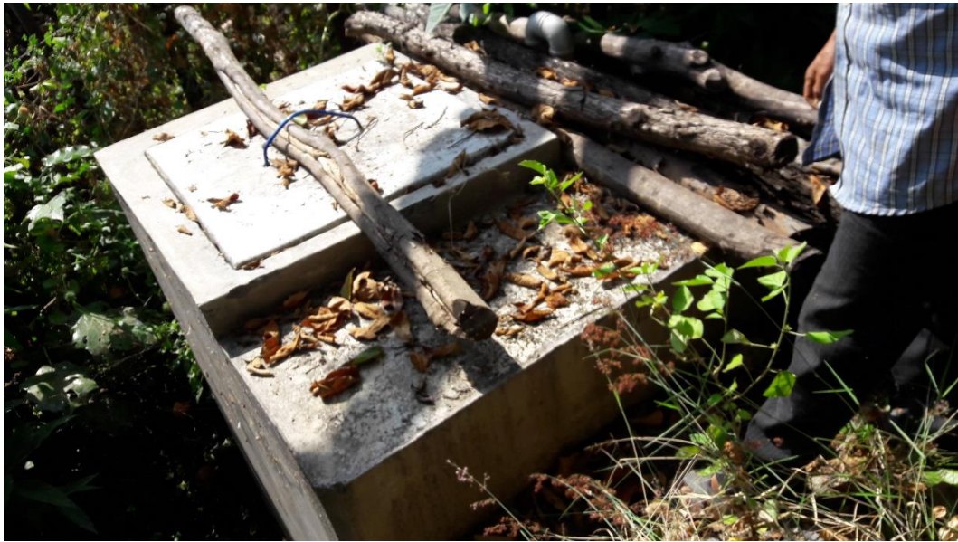
Imagen N° 03 – Camara de captación
