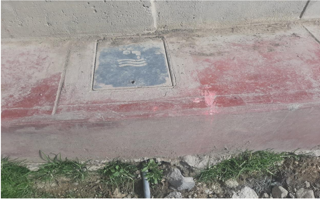
Fotografía 7: Caja del medidor del agua
