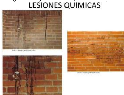
Fuente: Fuente: Patologías mampostería (43)
