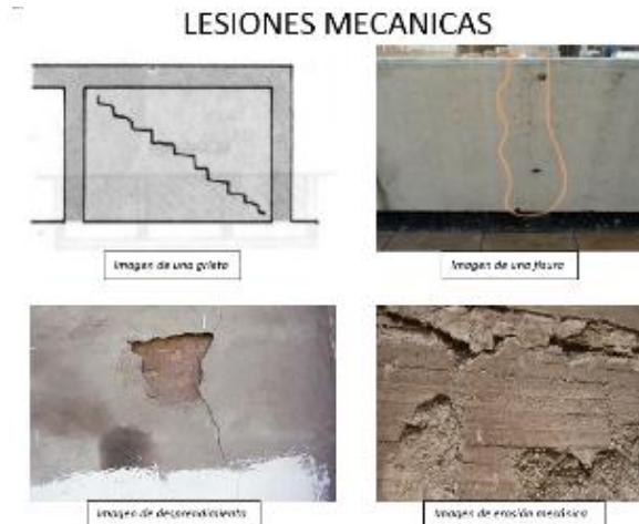
Fuente: .Patologías en la construcción (42)
