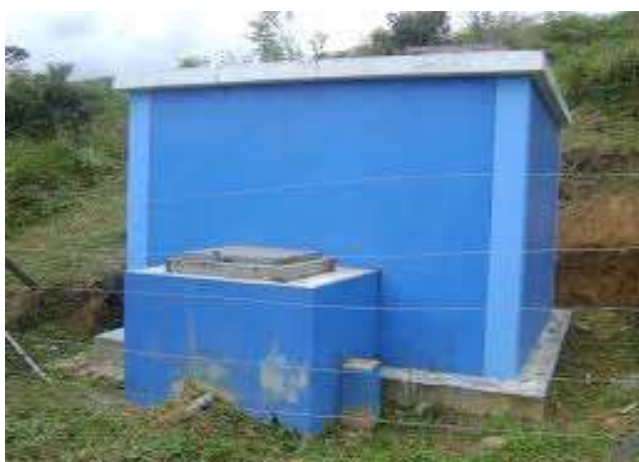
imagen 12 reservorio de almacenamiento de agua potable
