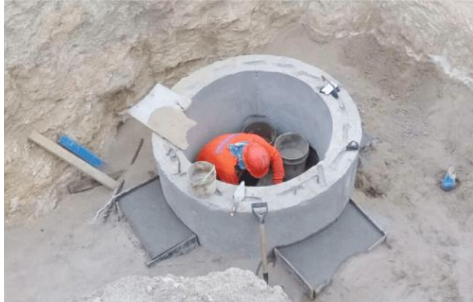
Figura 3. Cámaras de inspección
