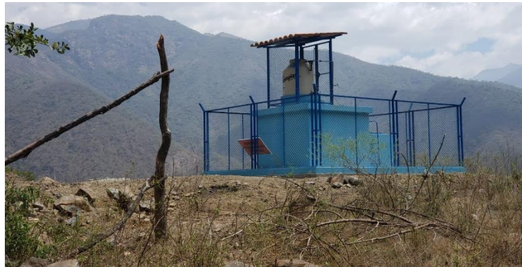
Gráfico 7: Estación de Bombeo
