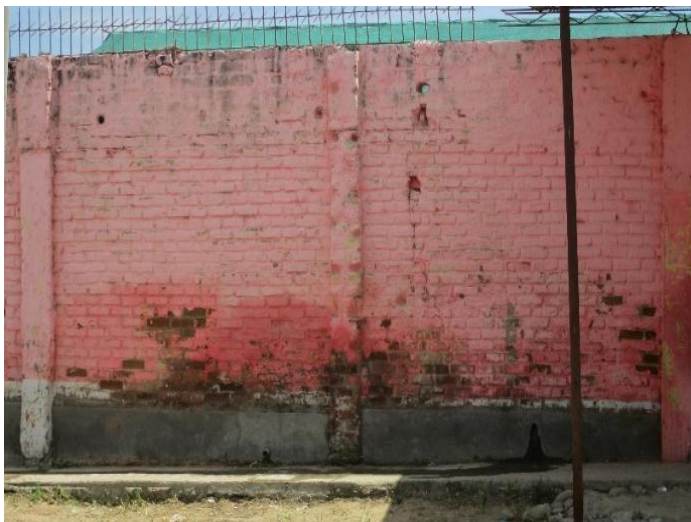
Grafico 8: Patologías en muros de albañilería.
