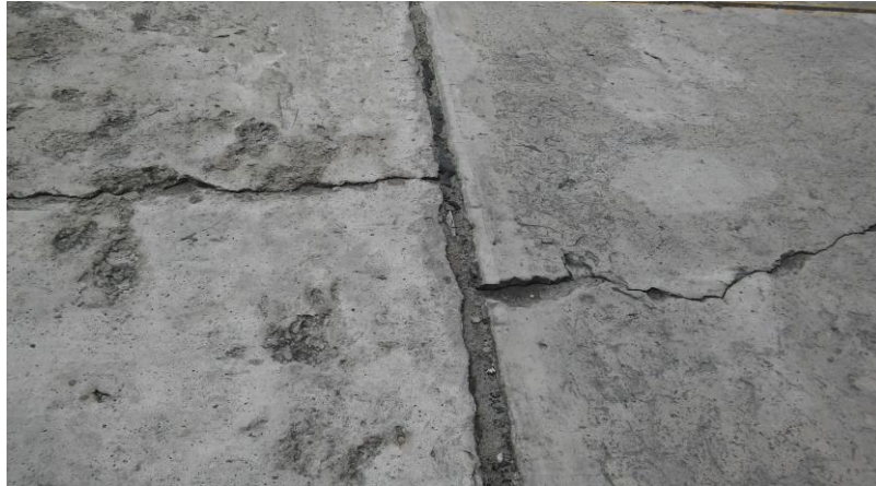
Figura 26: Falla Grietas de retracción
