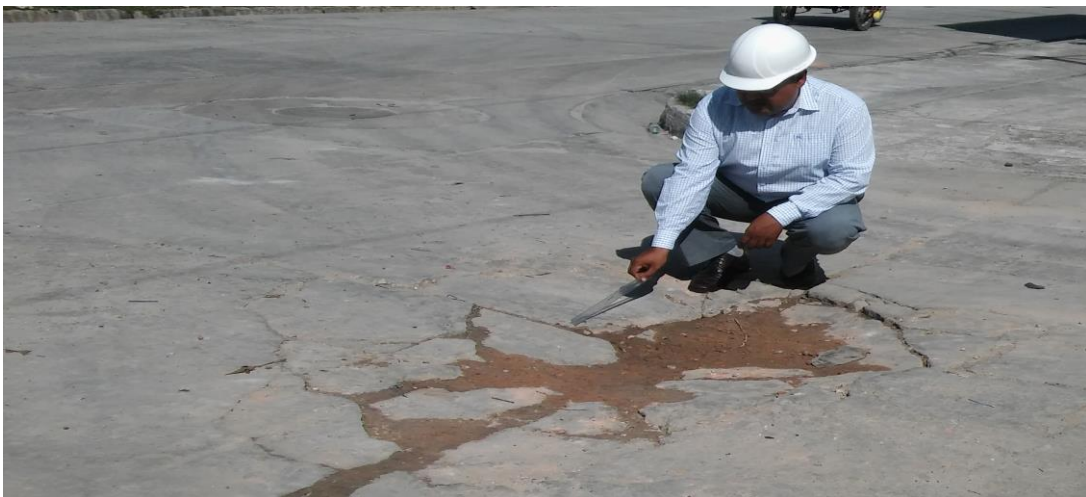
Figura 131: Jirón Sargento lores cuadra 12. Se observa falla Punzonamiento.
