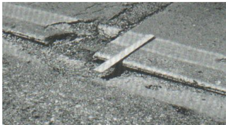
Figura 16: Falla Desnivel de carril/berma
