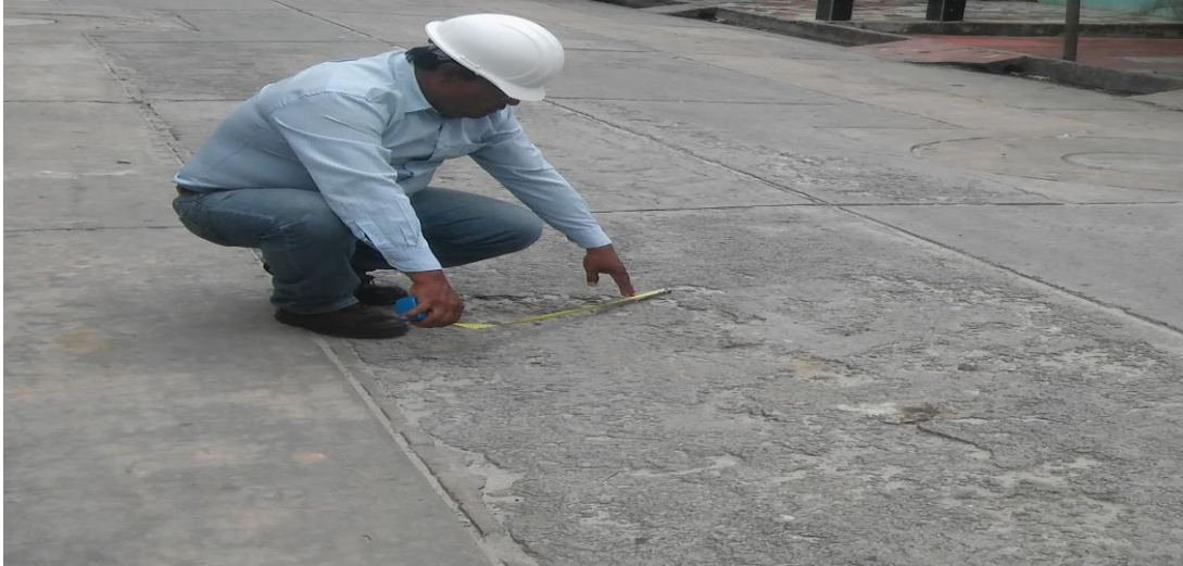
Figura 129: Jirón Sargento lores cuadra 12. Se observa falla Grieta lineal media.
