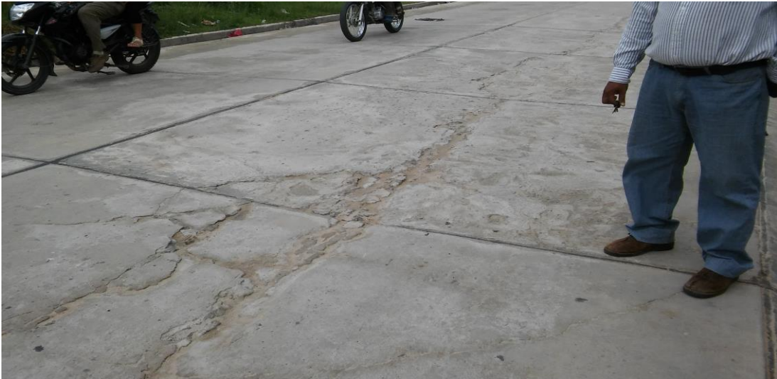
Figura 126: Jirón Sargento lores cuadra 12. Se observa falla Losa dividida alta.
