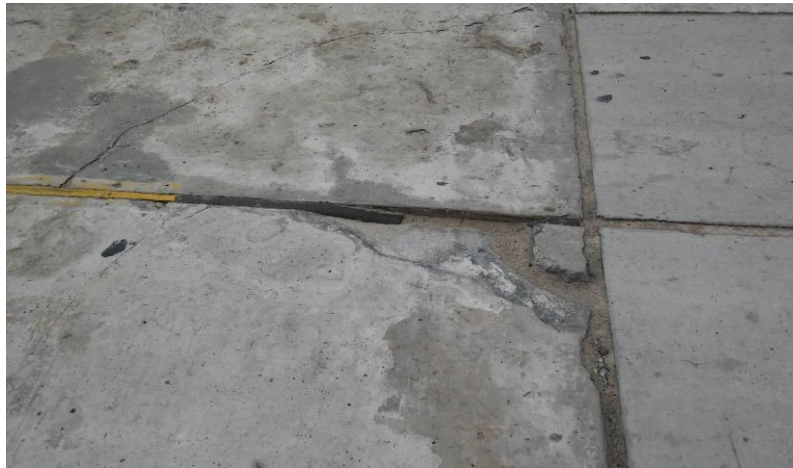
Figura 27: Falla Descascaramiento de Esquina
