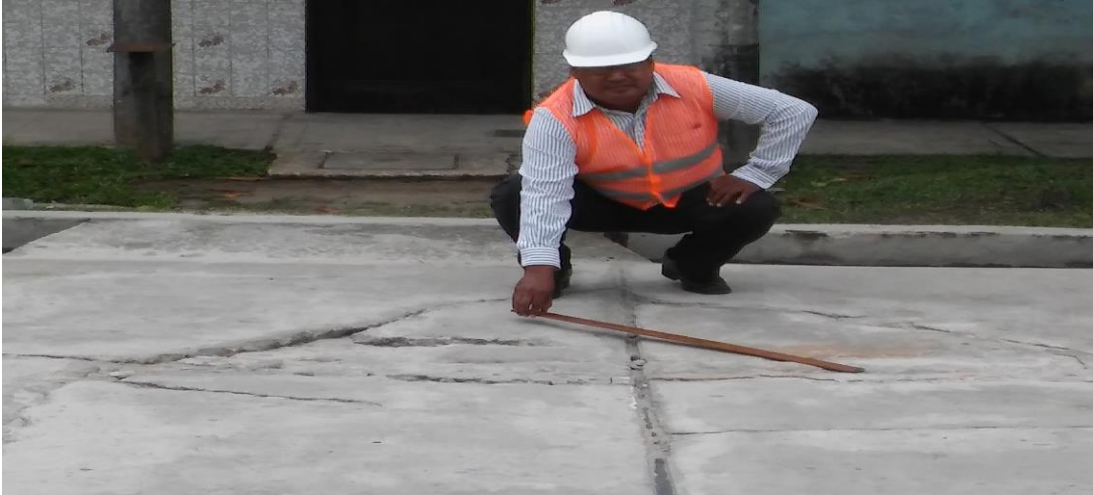
Figura 132: Jirón Sargento lores cuadra 13. Se observa falla Grieta de esquina
