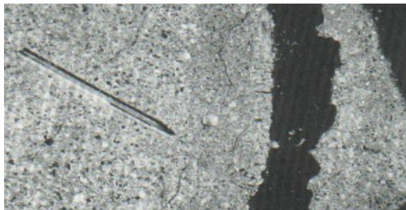
Figura 13: Falla Grieta de duravilidad “D”
