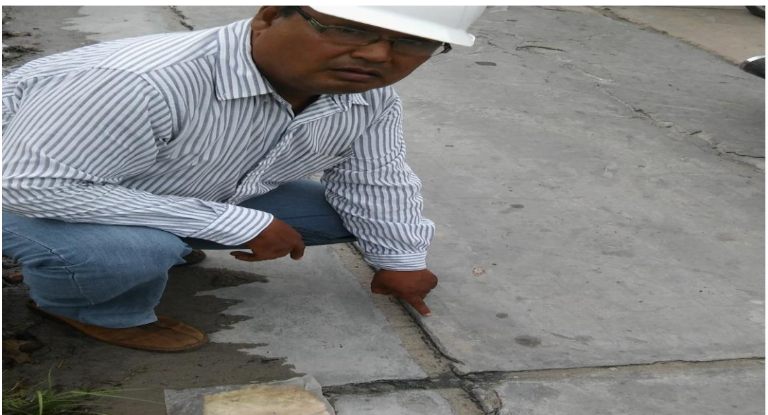
Figura 125: Jirón Sargento Lores cuadra 1, se observa Descascaramiento de junta
