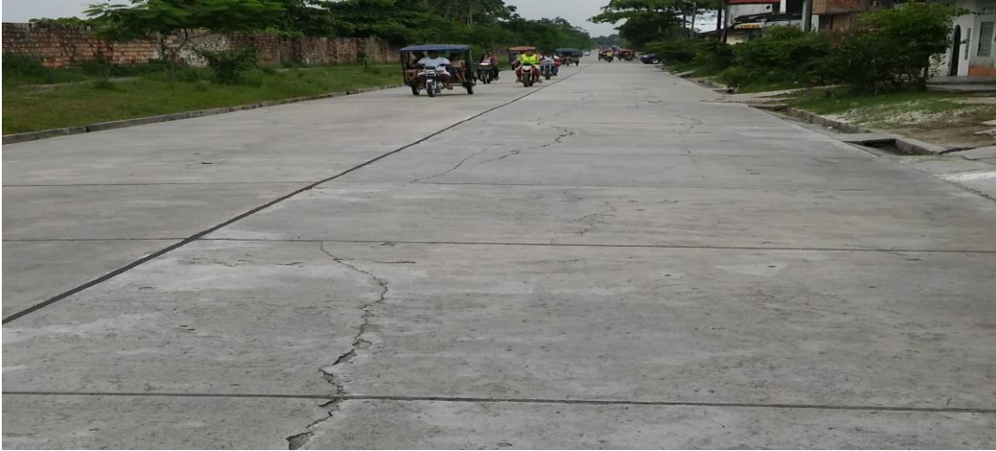
Figura 142: Jirón Sargento lores cuadra 15. Se observa falla Grieta lineal
