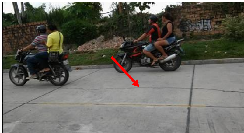
Figura 17: Falla Grieta lineal
