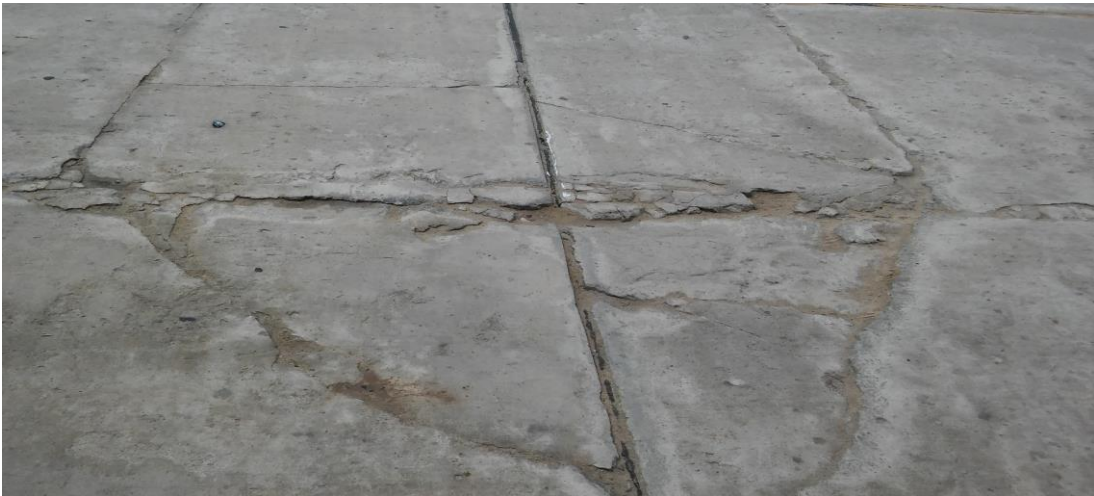
Figura 143: Jirón Sargento Lores cuadra 15, se observa Grieta de Esquina
