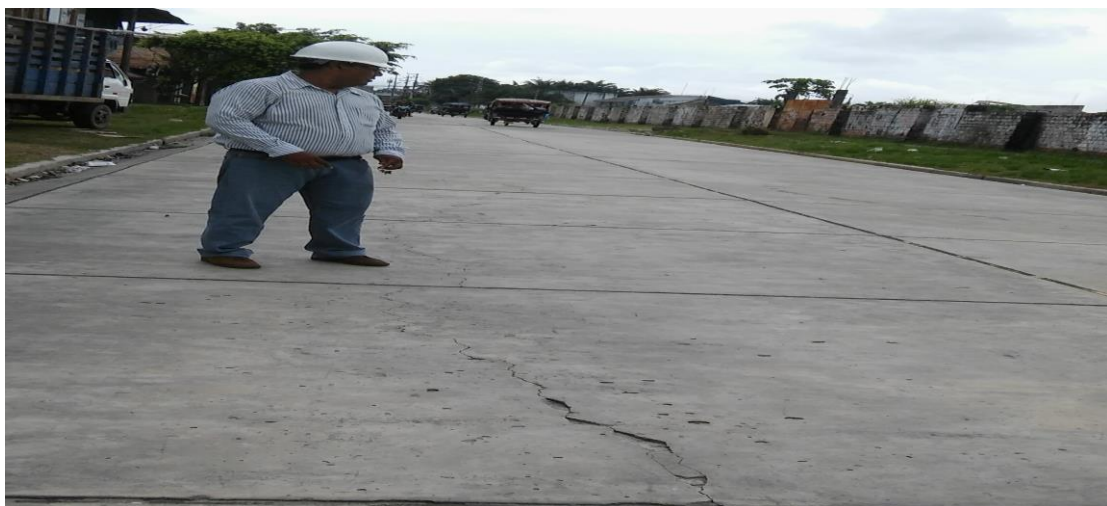
Figura 138: Jirón Sargento Lores cuadra 14, se observa Grieta Lineal
