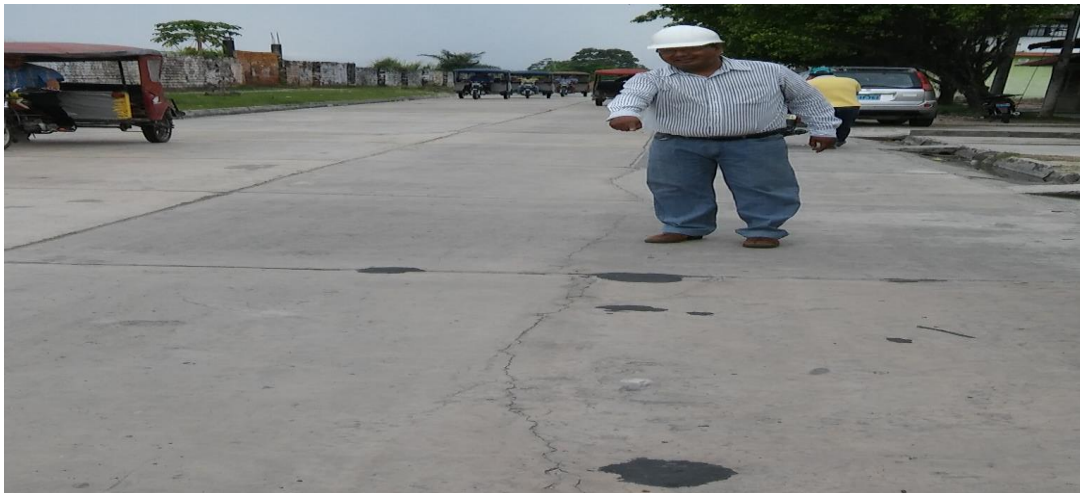
Figura127. Jirón Sargento lores cuadra 12. Se observa falla Grieta lineal media.
