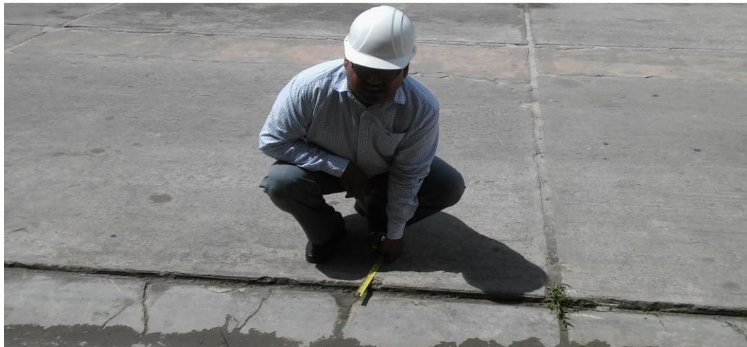
Figura 137: Jirón Sargento lores cuadra 14. Se observa falla Desnivel carril/berma
