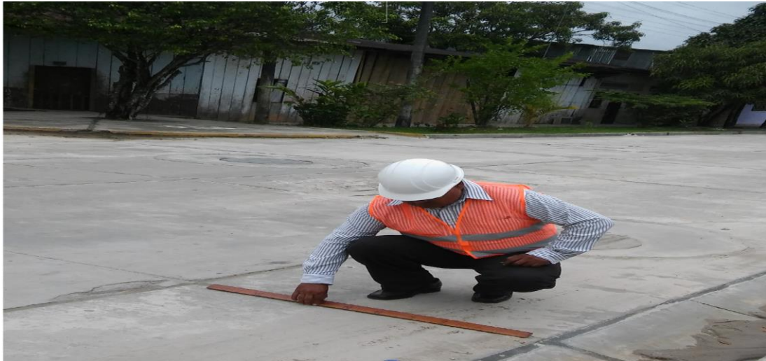
Figura 130: Jirón Sargento lores cuadra 12. Se observa falla Parcheo grande.
