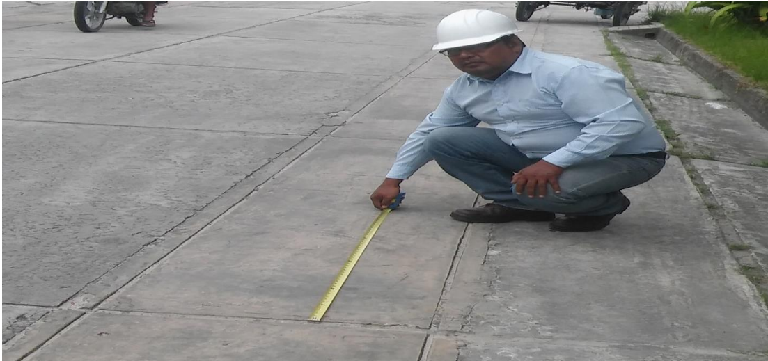
Figura 123: Jirón Sargento lores cuadra 11. Se observa falla Parche grande.
