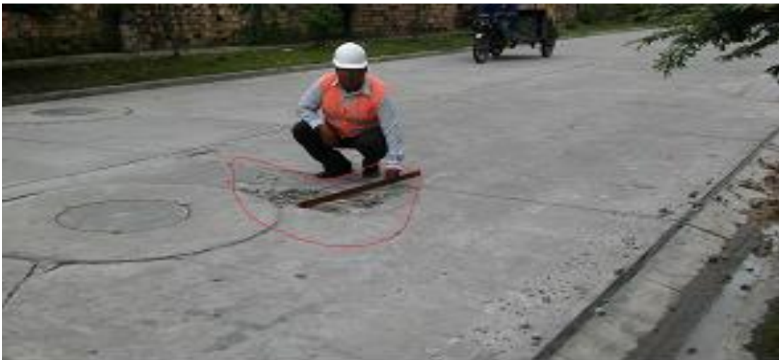
Figura 124: Jirón Sargento Lores cuadra 11, se observa Desconchamiento
