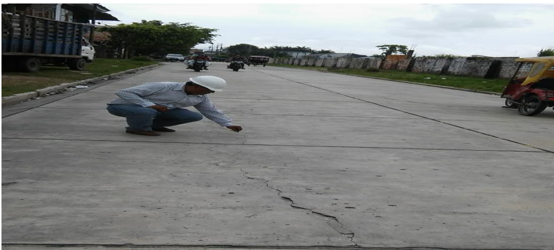
Figura 122: Jirón Sargento lores cuadra 11. Se observa falla Grieta lineal media.
