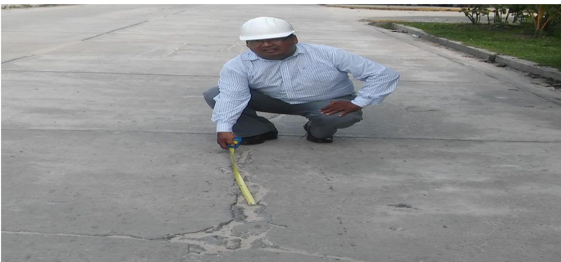
Figura 128: Jirón Sargento lores cuadra 12. Se observa falla Grieta lineal alta.
