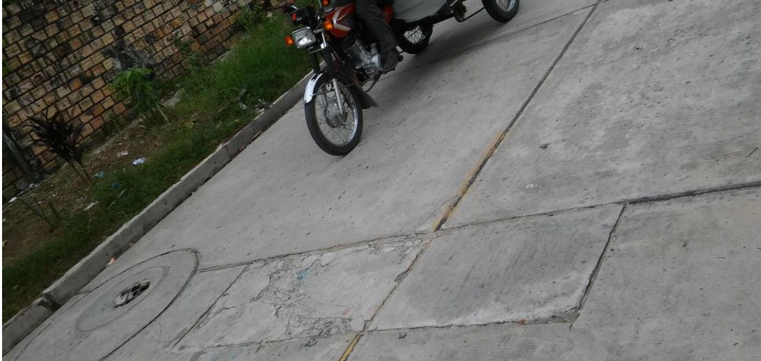
Figura 139: Jirón Sargento lores cuadra 14. Se observa falla Parche pequeño
