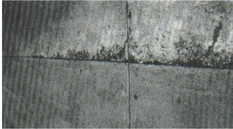
Figura 28: Falla Descascaramiento de la Junta
