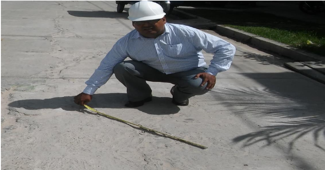
Figura 135: Jirón Sargento lores cuadra 13. Se observa falla Desconchamiento.
