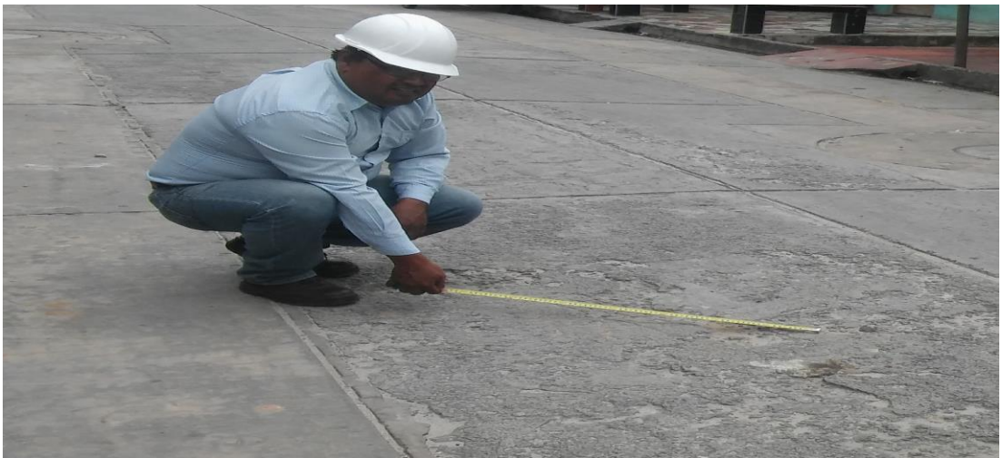
Figura 140: Jirón Sargento Lores cuadra 14, se observa Desconchamiento
