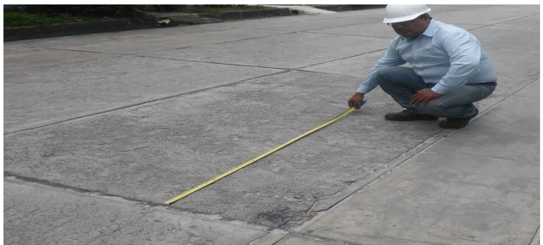
Figura 141: Jirón Sargento lores cuadra 14. Se observa falla Descascaramiento de junta
