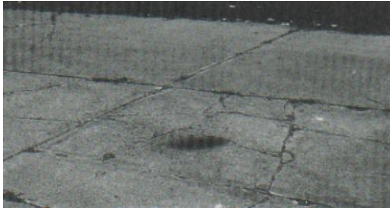
Figura 12: Falla Losa dividida
