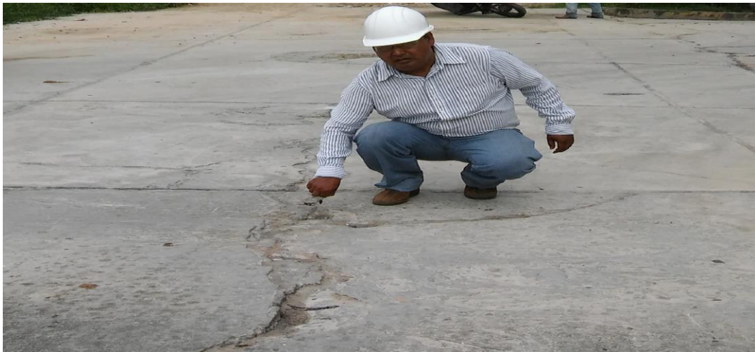
Figura 121: Jirón Sargento lores cuadra 11. Se observa falla Grieta lineal alta.
