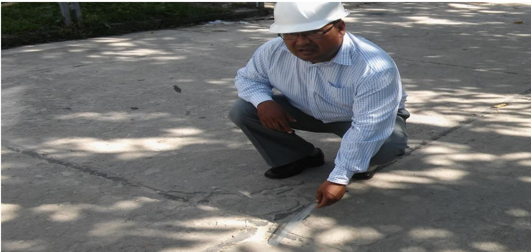
Figura 144: Jirón Sargento lores cuadra 15. Se observa falla Descascaramiento de junta
