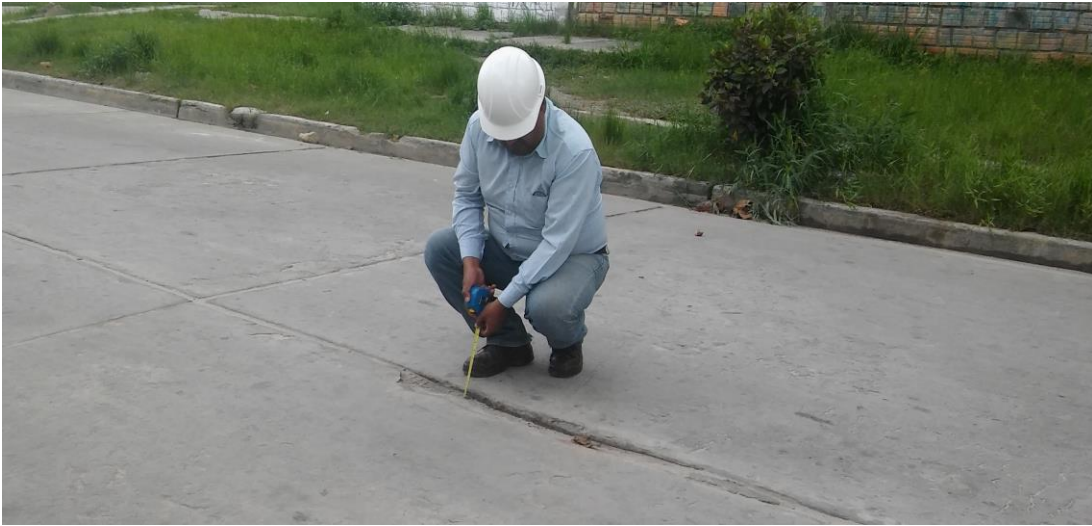
Figura 120: Jirón Sargento lores cuadra 11. Se observa falla Escala.
