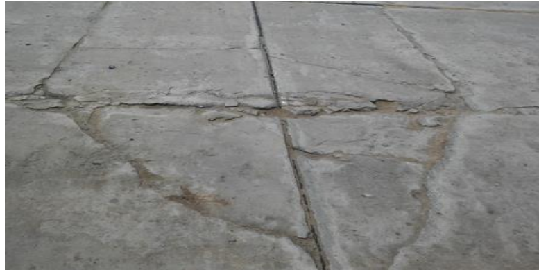
Figura 11: Falla Grieta de esquina
