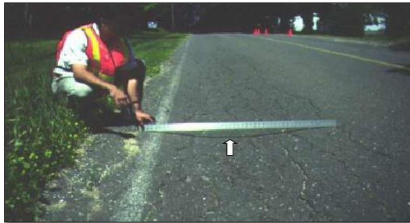
Gráfico 10: Asentamiento considerable en la vía
