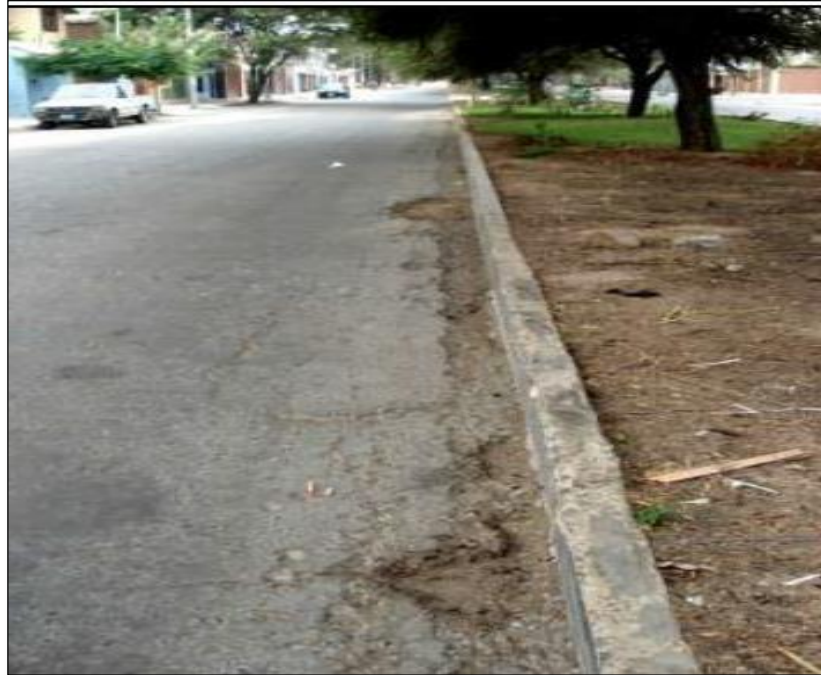
Gráfico 11: Grieta de borde.
