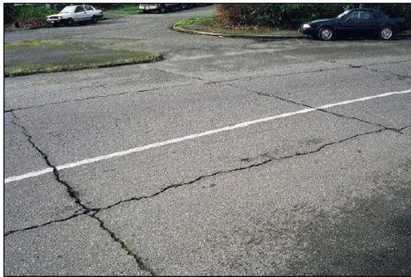
Gráfico 12: Fisura transversal que atraviesa todo el ancho del carril.
