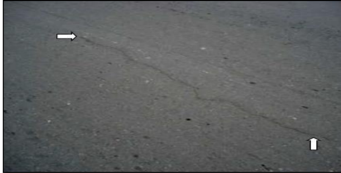
Gráfico 14: Término e inicio de una grieta longitudinal.
