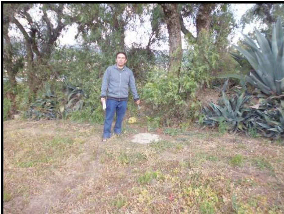
Se observa otro de las buzonetas del sistema de alcantarillado sanitario condominial sector central
