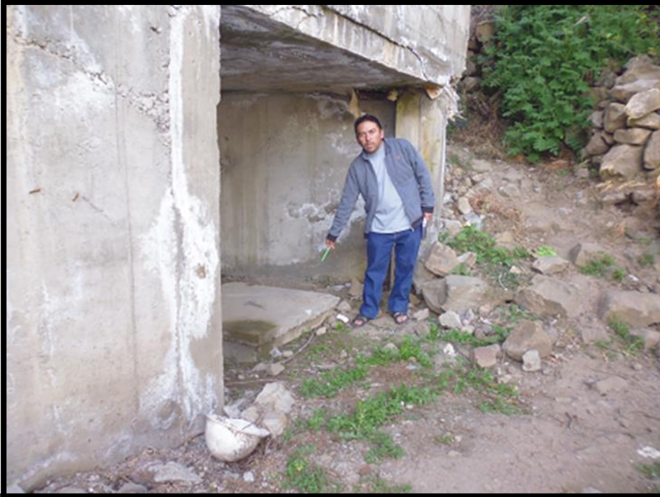
Captación de Shocosh Quita cuenta con un caudal de 2.00 l/s se observa las condiciones en las que se encuentra
