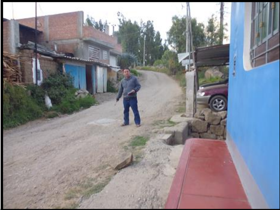
Se observa otro de las buzonetas del sistema de alcantarillado sanitario condominial sector central
