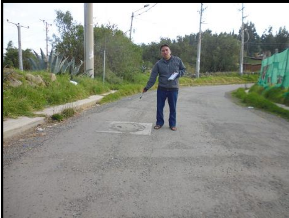
Se observa las buzonetas instaladas en la red de alcantarillado sanitario condominial
