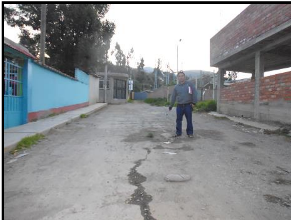
Se observa que la línea de distribución se encuentra en mal estado presentando fuga en el tramo de la escuela de Picup
