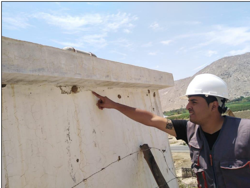
Imágen 5 Las paredes del reservorio presentan fisuras y rajaduras, revestimiento exterior desprendido.
