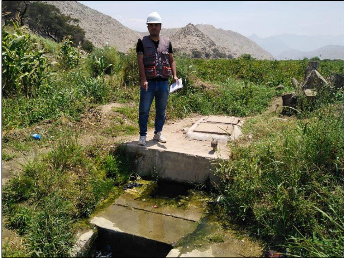
Imágen 6 Obra de captación por manantial (tipo fondo)
