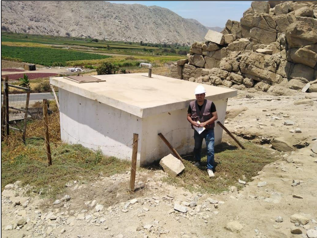
Imágen 4 Reservorio apoyado rectangular Localidad de Cantarilla, sin cerco perimétrico y sistema de desinfección
