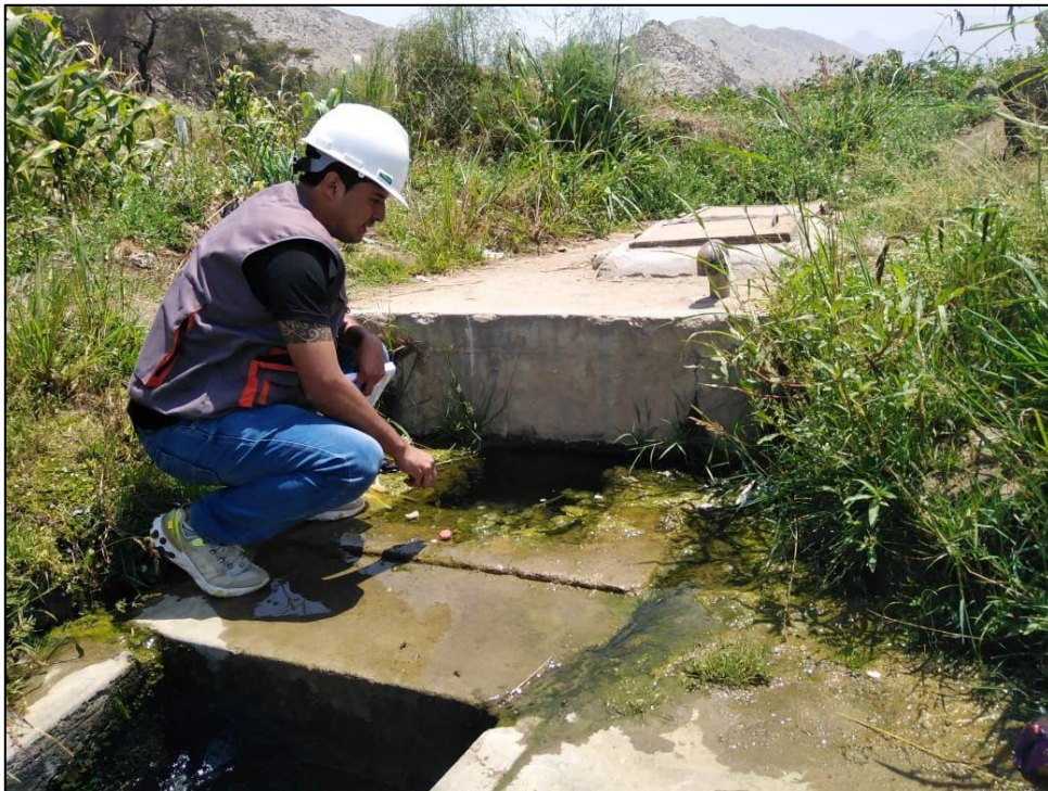
Imágen 2 La estructura de la captación presenta rajaduras por donde existe filtraciones y no cuenta con cerco perimétrico.
