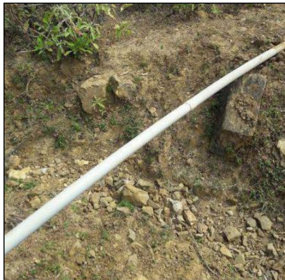
Imágen 7 Línea de conducción
