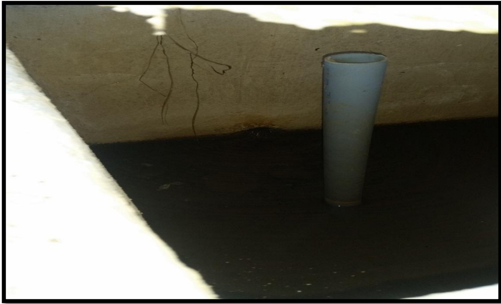
Imagen 2. CRP tipo 6 – existe una pequeña perforación.
