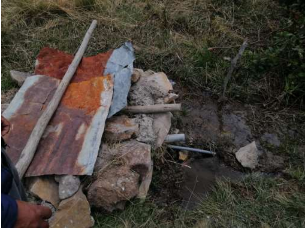
Fotografía 3 Captación artesanal en mal estado
