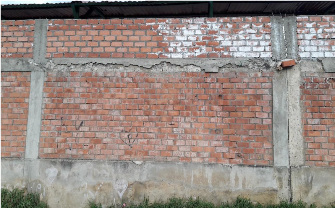
Vista exterior del cerco perimétrico lado oeste con patologías como desintegración , eflorescencia , entre otros, del campo deportivo de la Institución Educativa Simón Antonio Bolívar Palacios en el distrito de Independencia, provincia Huaraz, departamento Áncash.
