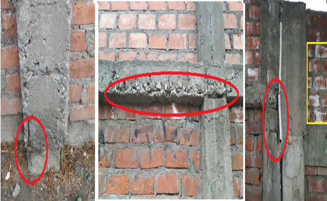
Vista interior del cerco perimétrico lado oeste con patologías como corrosión, eflorescencia , entre otros; del campo deportivo de la institución Educativa Simón Antonio Bolívar Palacios en el distrito de Independencia, provincia Huaraz, departamento Áncash.
