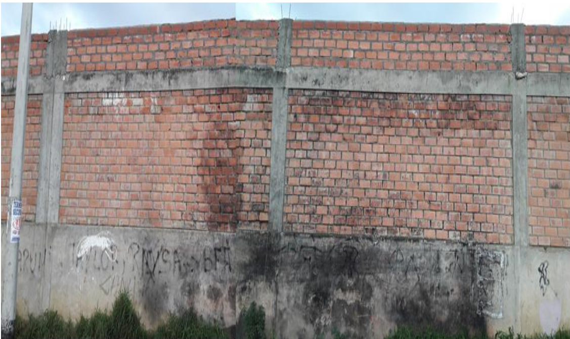
Vista exterior del cerco perimétrico lado oeste con patologías como humedad, fisuras , entre otros, del campo deportivo de la Institución Educativa Simón Antonio Bolívar Palacios en el distrito de Independencia, provincia Huaraz, departamento Áncash.
