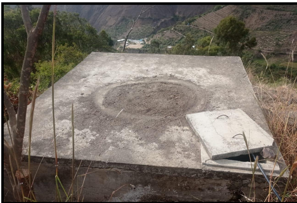
Imagen 6 Reservorio del Área N° 1, del caserío de Allpamarca presenta grietas y fisuras en su estructura.
