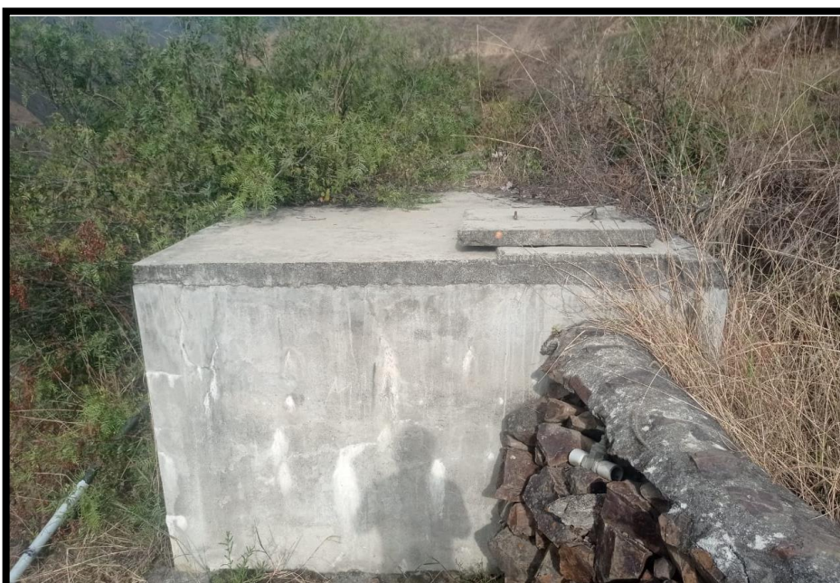
Imagen 8 Reservorio del Área N° 2, del caserío de Allpamarca presenta grietas y fisuras en su estructura por su antigüedad.
