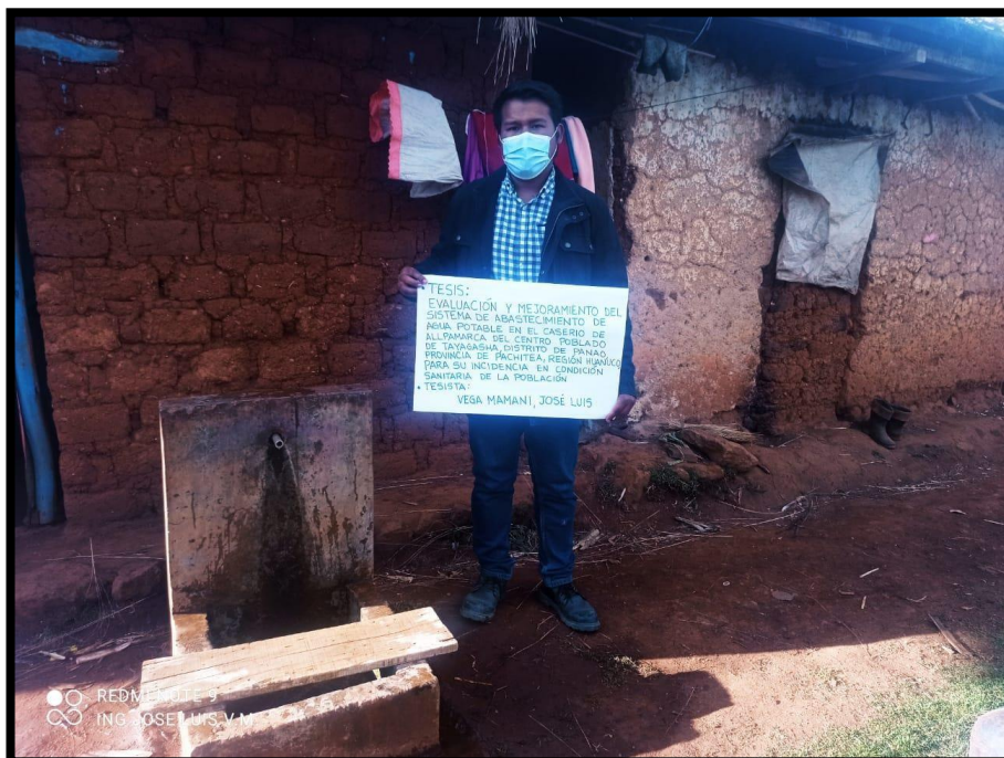
Imagen 11 Pileta publica N° 01 dentro de la red de distribución del área n° 02, del caserío de Allpamarca.
