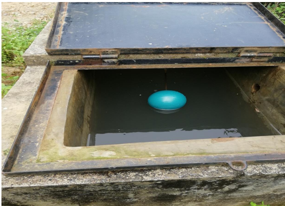
IMAGEN N° 10: CAMARAS ROMPE PRESIÓN EXISTENTE TIPO VII
