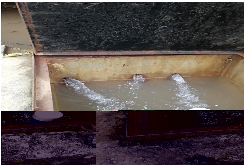
IMAGEN N° 03: CAPTACIÓN EXISTENTE DE MANANTIAL “EL GUINEAL”
