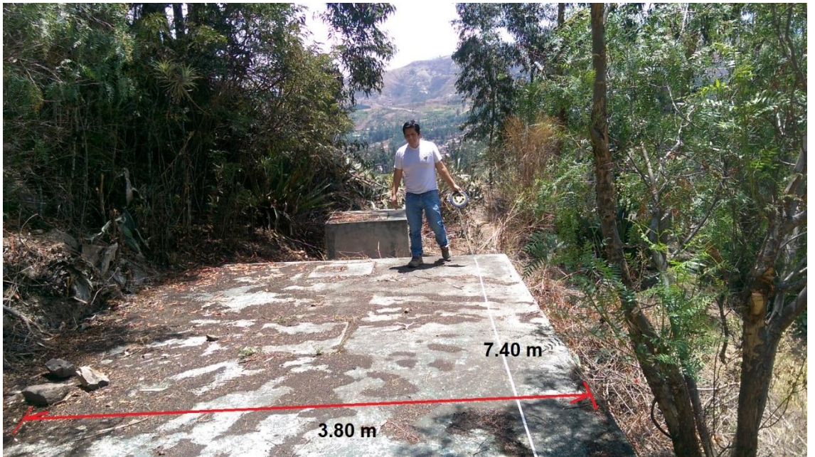
Imagen 16. Características físicas de tanque séptico
