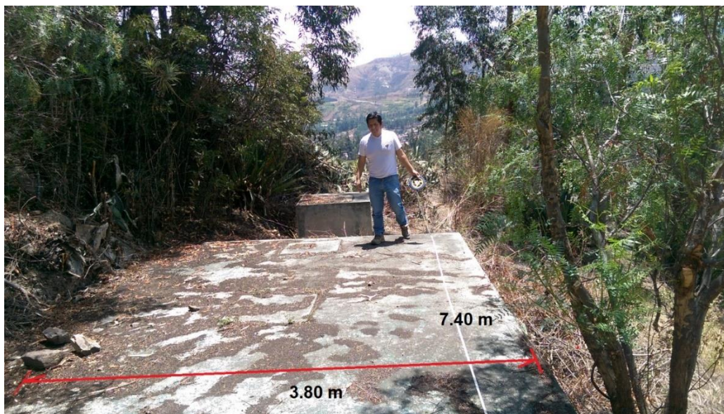
Imagen 8. Características físicas de tanque séptico
