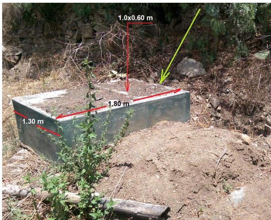
Imagen 7. Características físicas de la cámara de almacenamiento primario
