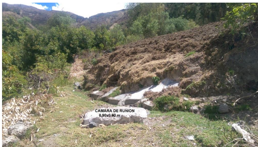
Imagen 07. Se aprecia Captación 02, no presenta cerco perimétrico
