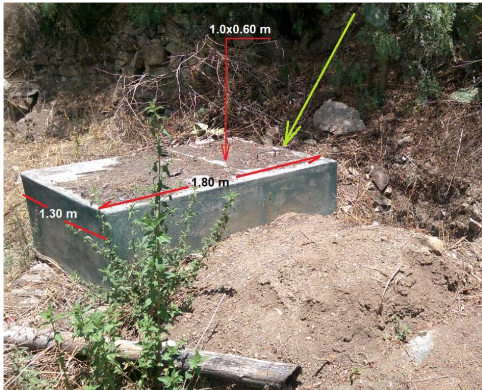
Imagen 14. Características físicas de la cámara de almacenamiento primario
