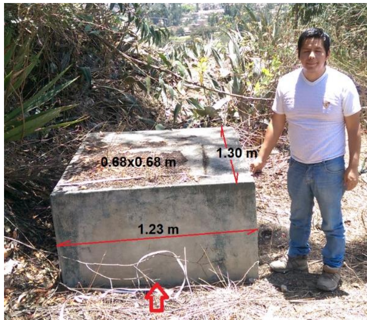
Imagen 9. Características físicas de la cámara de distribución
