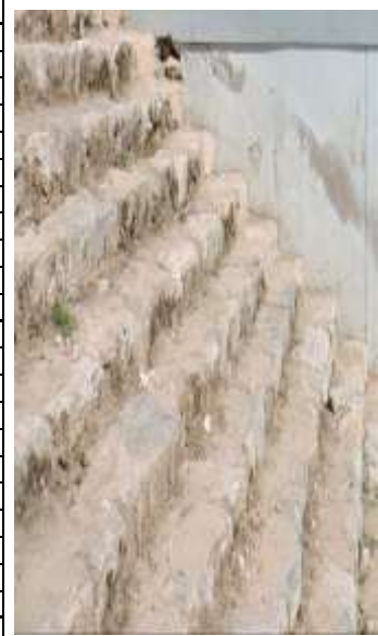
FOTOGRAFÍA DE LA PATOLOGÍA
