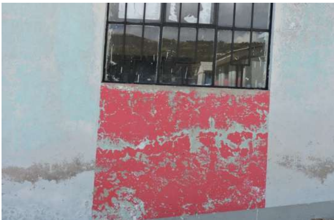
Fotografía 09- Vista del muro con presencia de descascaramiento ubicado en el lado derecho frontal externo de la Institución Educativa Publica Santa Fe Tumpa-Yungay.
