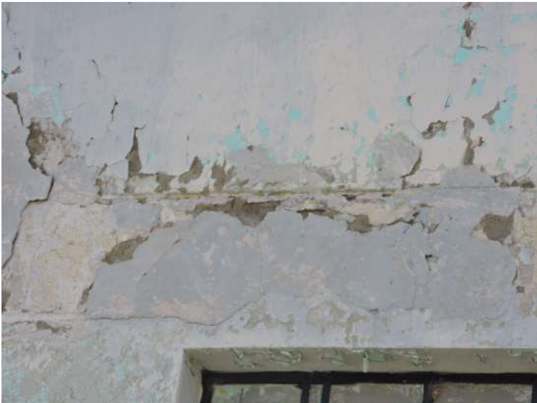
Fotografía 07- Vista del muro con presencia de desprendimiento ubicado en el lado lateral izquierda externo de la Institución Educativa Publica Santa Fe Tumpa-Yungay.
