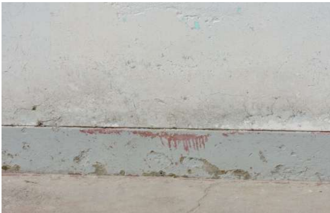
Fotografía 08- Vista del sobre cimientto - muro con presencia de descascaramiento ubicado en el lado lateral frontal externo de la Institución Educativa Publica Santa Fe Tumpa-Yungay.
