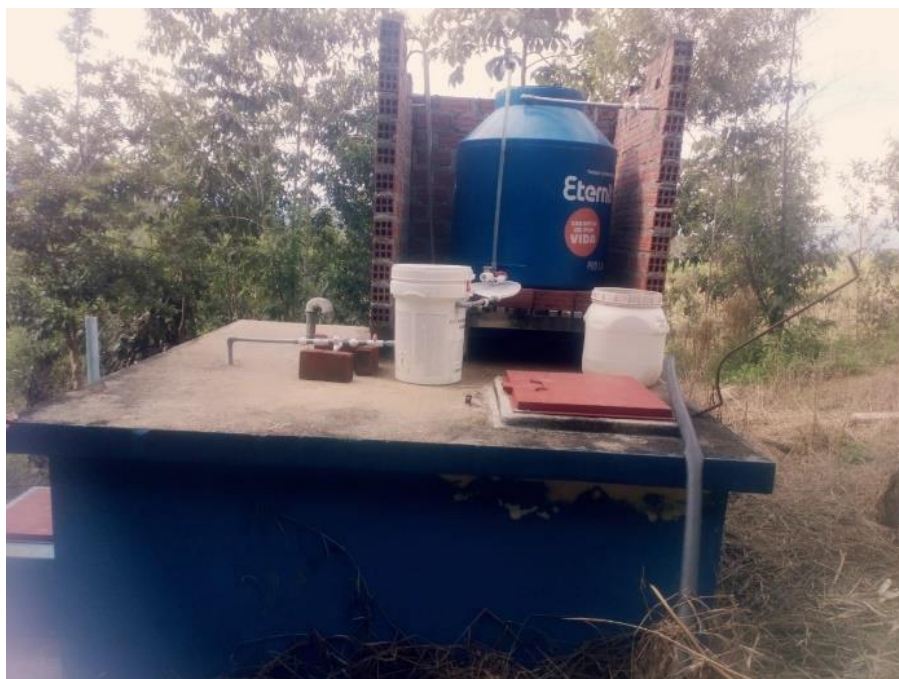
Primer reservorio del centro poblado, cuenta con sistema de desinfeccion y esta en condiciones optimas.
