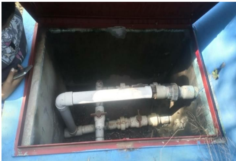
Caja de valvulas del reservorio del centro poblado Hermosa Pampa.
