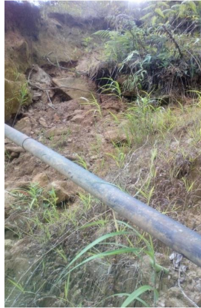
Tramo por donde atraveza la linea de conduccion, presenta desprendimiento de rocas y riesgos de derrumbes.
