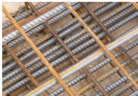
Imagen 2. Error en el diseño de la armadura, la cantidad de varilla no deja el espacio entre las mismas
