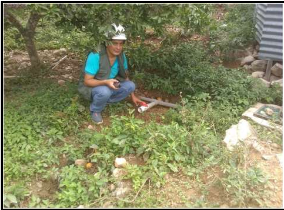
Foto 05: Vista panorámica de válvula de aire en la línea de aducción.
