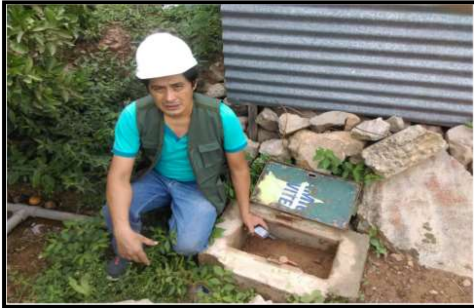
Foto 06: Vista panorámica de válvula principal de red de distribución.
