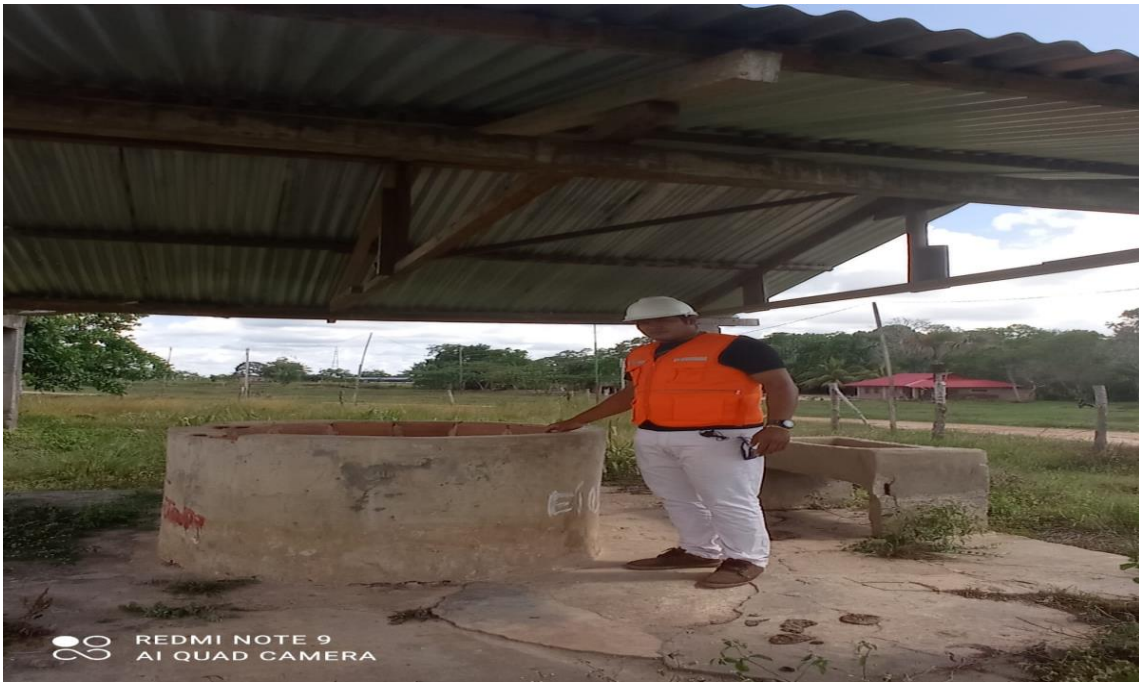
Fotografía 03: caserío Dos Unidos, pozo artesanal en mal estado y fuera de funcionamiento
