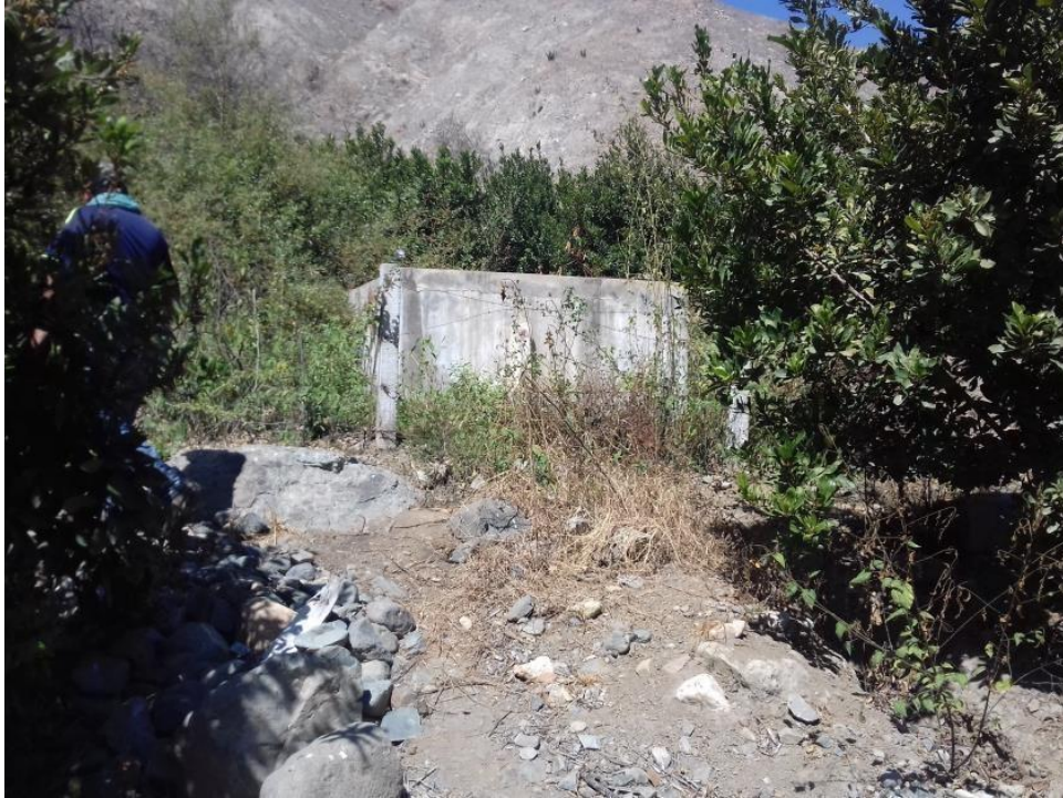
FOTO N° 05: VISTA DEL RESERVORIO EXISTENTE EN ESTADO DE DETERIORO QUE REQUIERE SU RECONSTRUCCION
