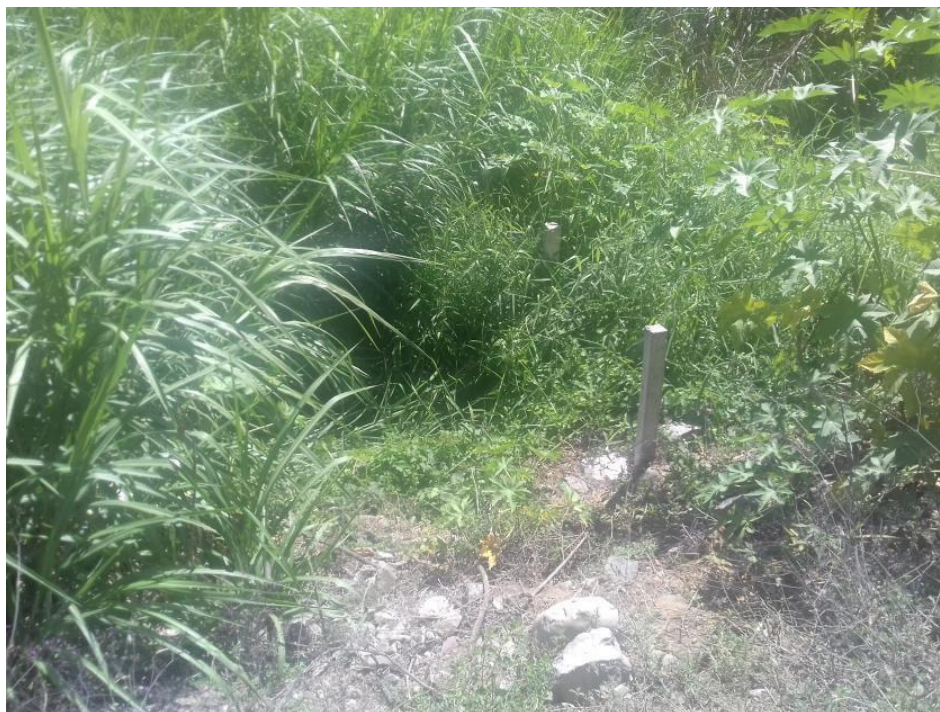
FOTO N° 01: VISTA DE LA CAPTACION DE HUARMEY EN ESTADO DE COLAPZO Y LLENO DE VEGETACION
