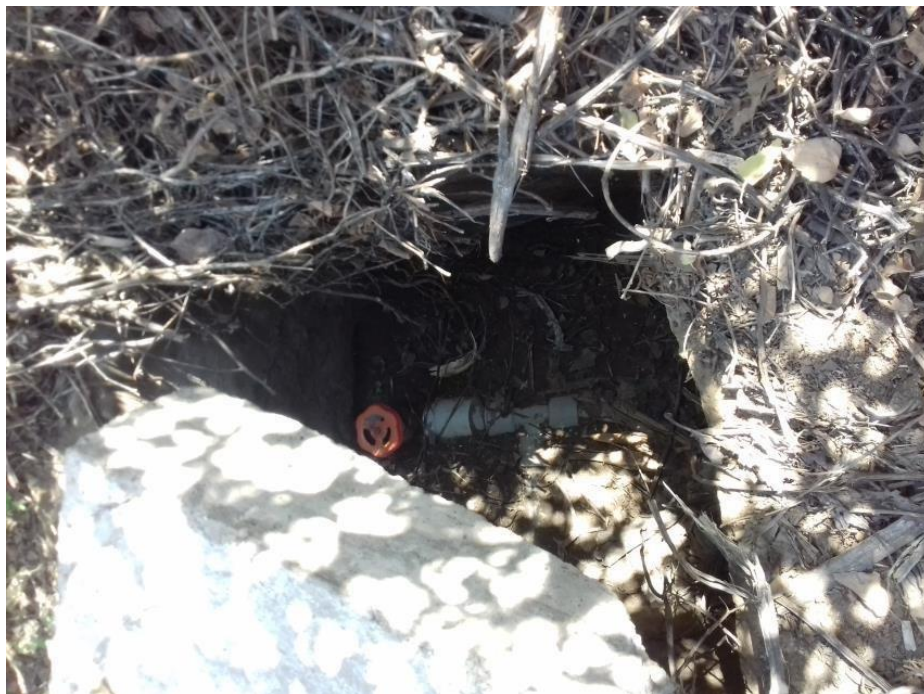
FOTO N° 08: VISTA DE LAS VALVULAS DE CONTROL DE DIAMETRO DE 1 ½", EN LAS RED DE ADUCCION Y DISTRIBUCION EN ESTADO DETERIORADO REQUIERE RECONSTRUCCION
