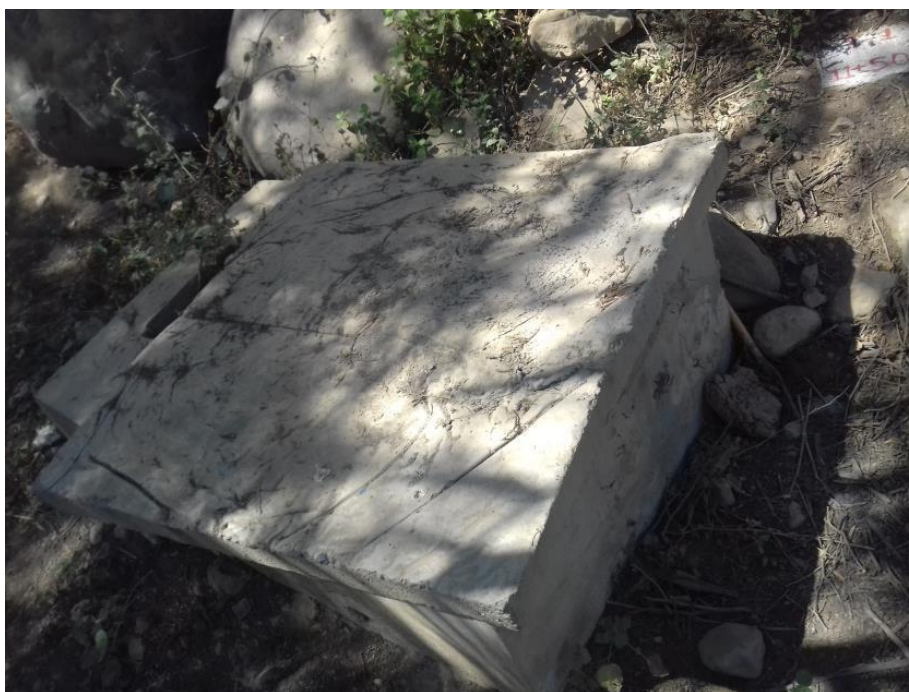
FOTO N° 04: VISTA DEL CRP T-6 EXISTENTE EN ESTADO DETERIORADO YA QUE CUMPLIO SU VIDA UTIL
