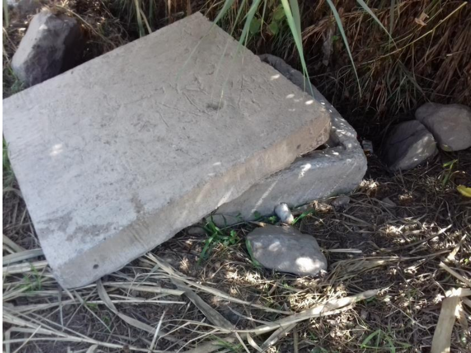
FOTO N° 07: VISTA DEL CRP T-7 EN LA LINEA DE ADUCCION EN ESTADO DETERIORADO REQUIERE SU RECONSTRUCCION URGENTE.
