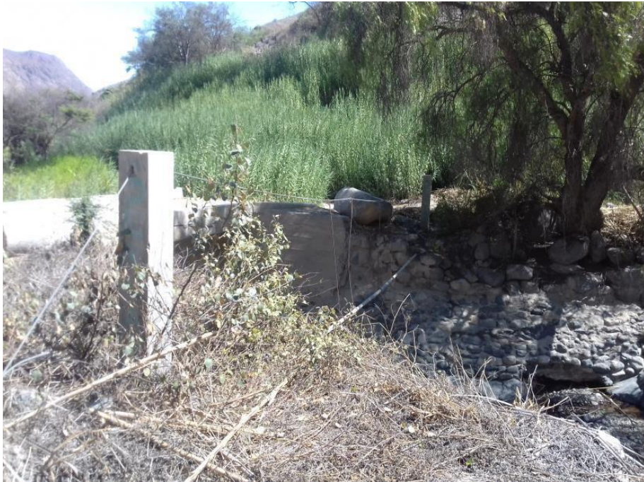
FOTO N° 06: VISTA DEL TRASVASE EXISTENTE EN LA LINEA DE CONDUCCION DEL SISTEMA DE AGUA POTABLE DEL CASERIO MOLINOPAMPA REQUIERE SU RECONSTRUCCION
