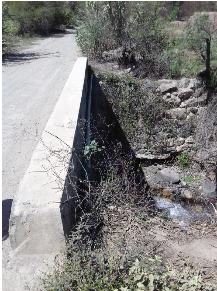
FOTO N° 10: VISTA DEL PASE AERE DE LA TUBERIA DE DIAMETRO 1 ½", EN LA LINEA DE ADUCCION, REQUIERE SU CAMBIO URGENTE
