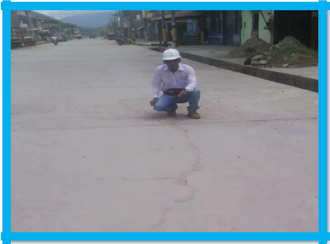
Figura 88. Fotografía de grietas lineales cuadra 02.
