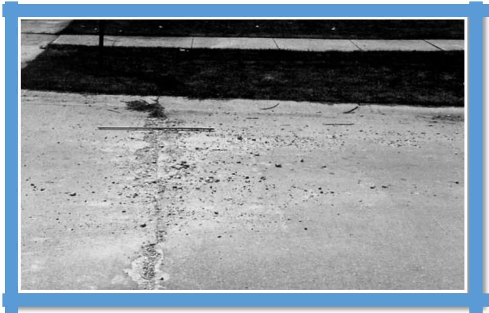
Figura 09. Falla por blowups-buckles.
