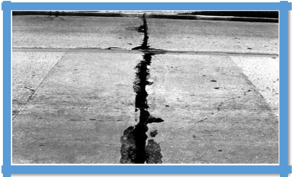
Figura 14. Daño de sello de junta
