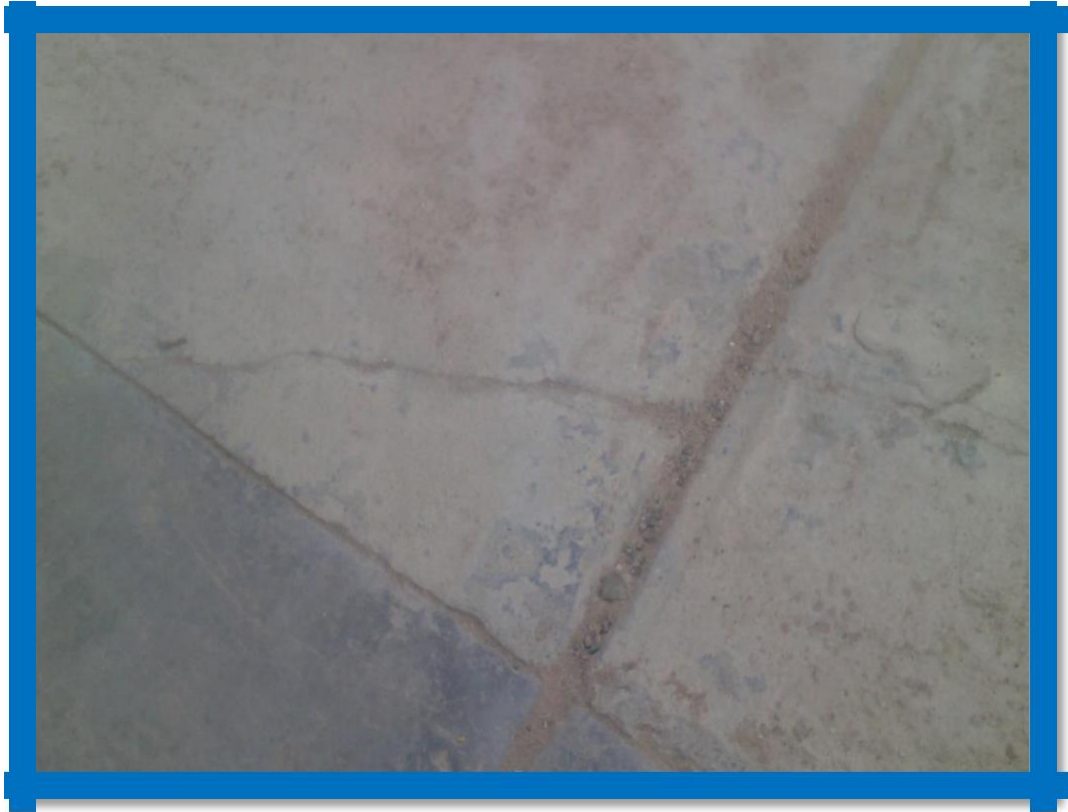
Figura 100. Grieta de esquina cuadra 04.
