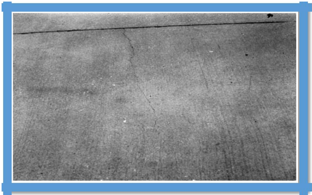
Figura 25. Grietas de retracción.
