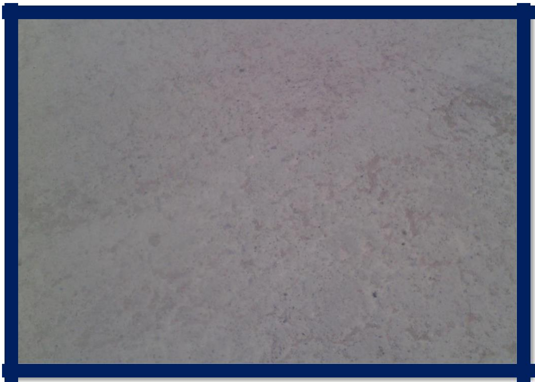
Figura 95. Grietas de retracción cuadra 03
