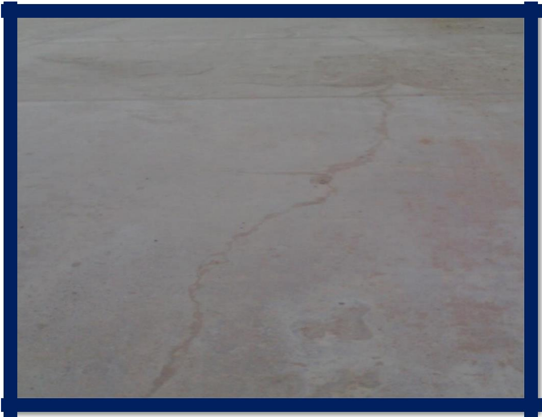
Figura 93. Grietas lineales cuadra 03.
