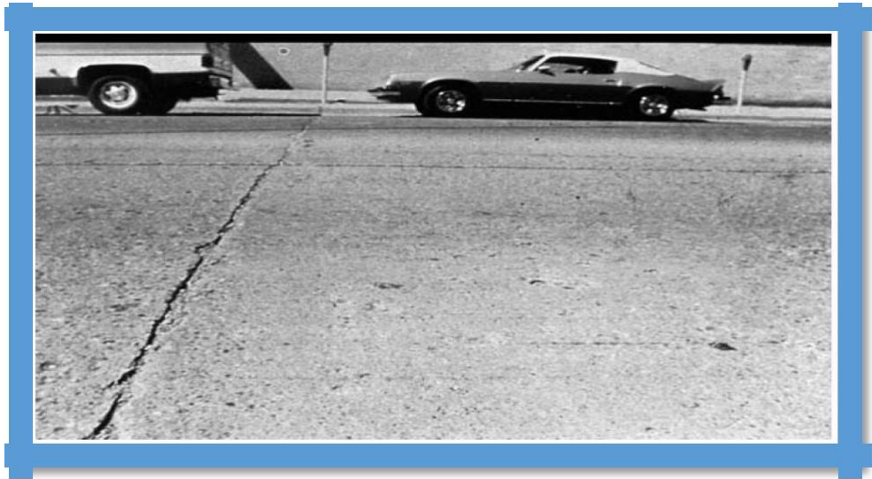
Figura 27. Descascaramiento de junta
