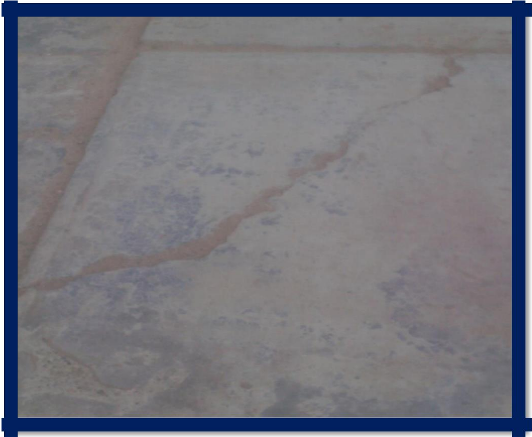
Figura 94. Grieta de esquina 03.
