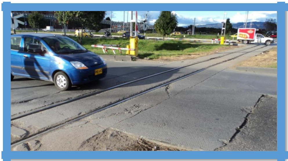
Figura 23. Falla por el cruce de vía férrea.
