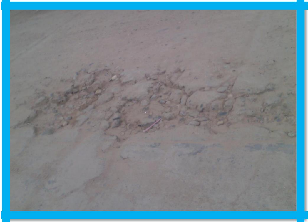
Figura 90. Desconchamiento, mapa de grietas, craquelado cuadra 02
