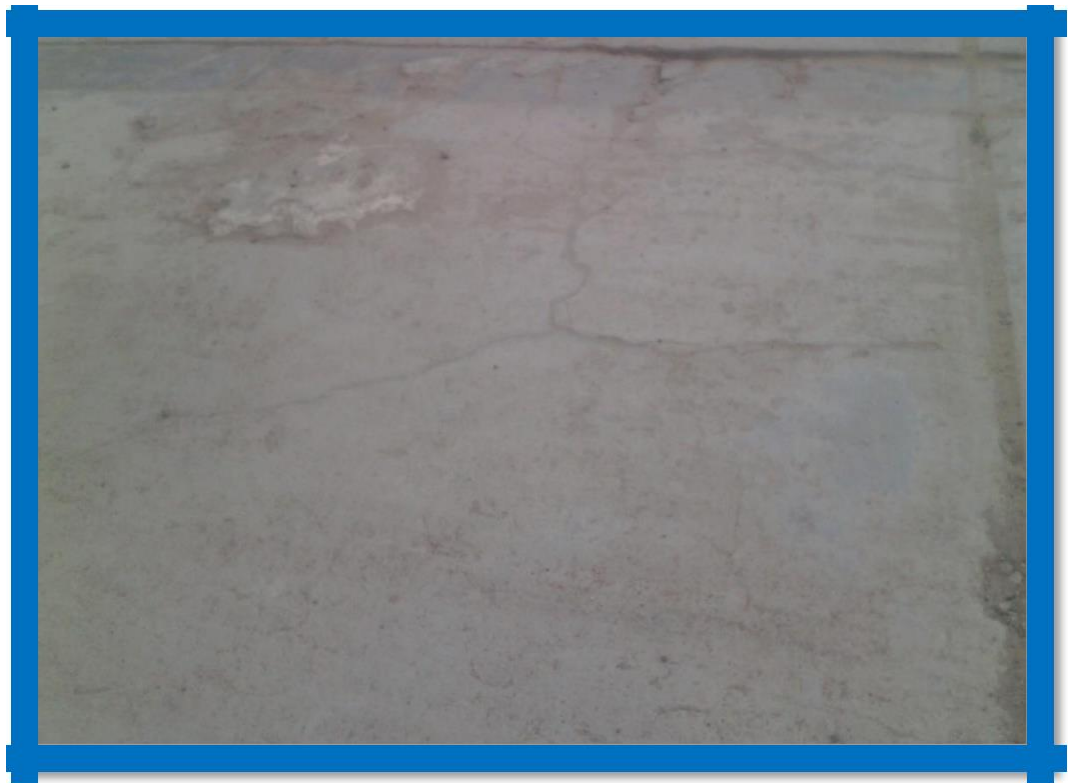
Figura 99. Grietas lineales cuadra 04.
