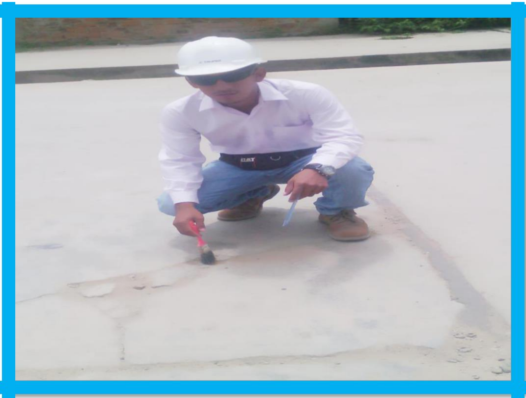
Figura 89. Fotografía de grieta de esquina cuadra 02.
