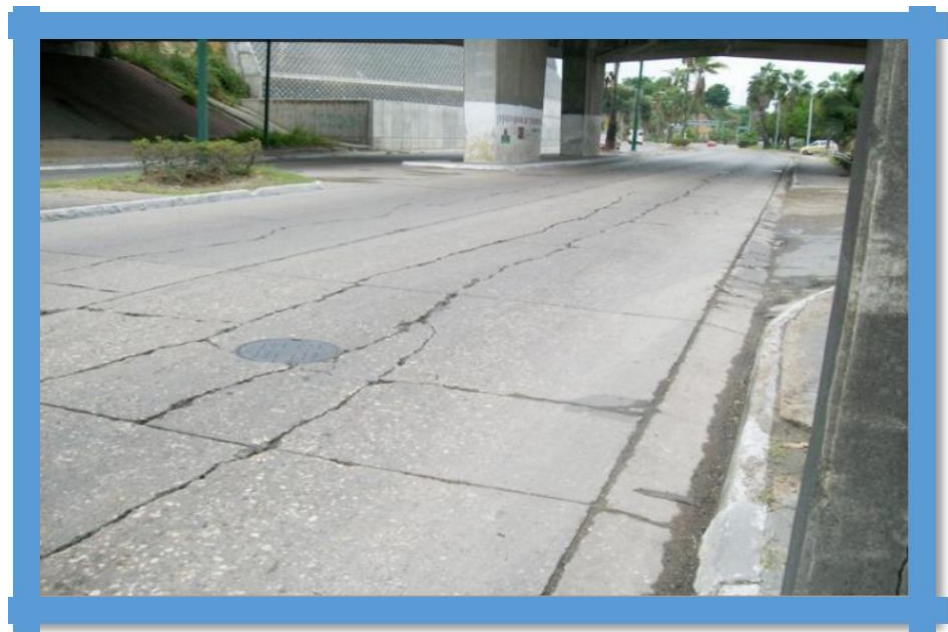
Figura 08. Deterioros más comunes en pavimento.
