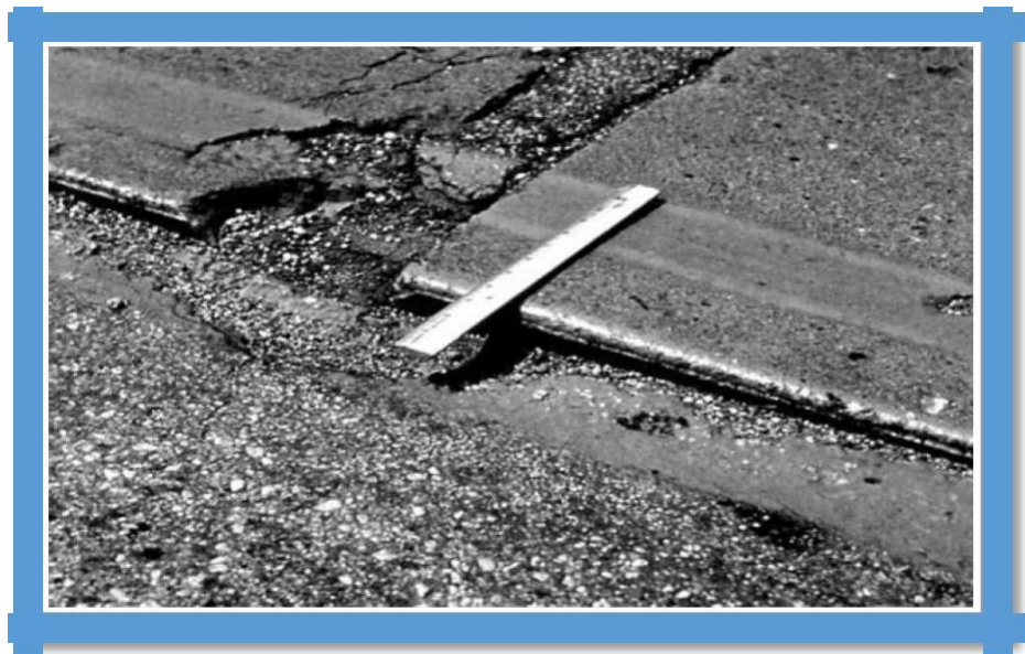
Figura 15. Desnivel de carril / berma.
