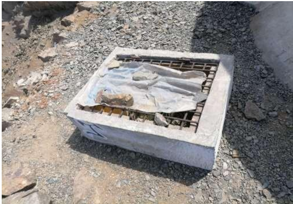
Fotografía 6 cámara rompe presión tipo7
