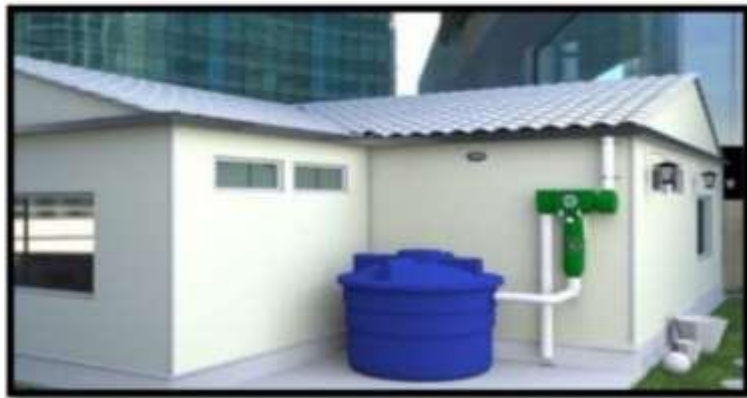
Imagen 3 Captación de agua pluvial
