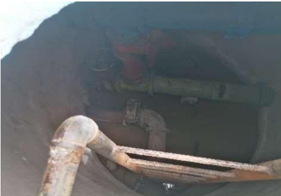
Fotografía 4 Cámara de válvulas del reservorio de almacenamiento
