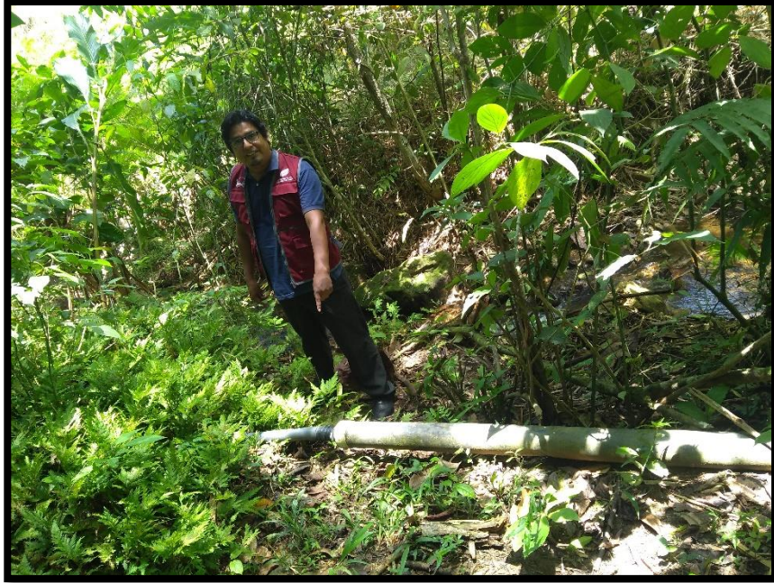
Figura 21 – Muestra de las uniones de tuberías con fugas de agua
