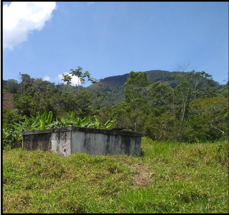
Figura 23 – Vista del reservorio de la comunidad
