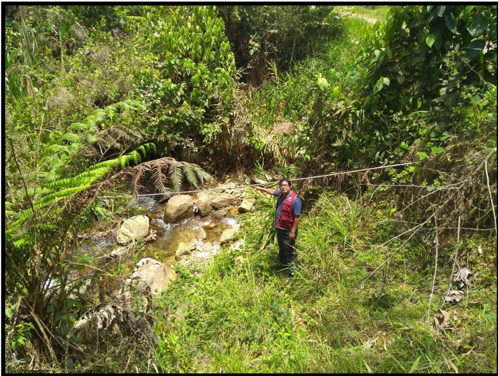
Figura 22 – Instalaciones de tuberías improvisadas
