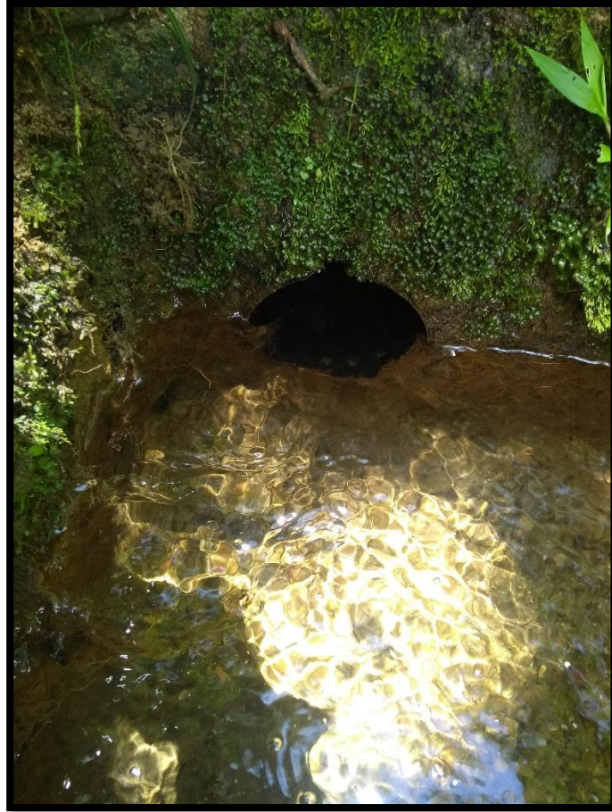
Figura 19 - Muestra de tubería de salida de la captación
