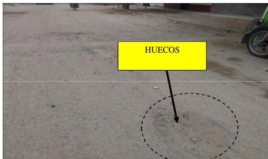
GRAFICO No 34. Patologías de huecos en la cuadra 1
