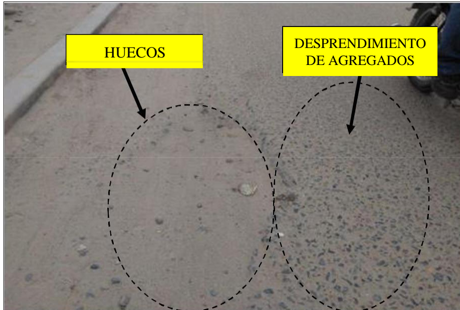
GRAFICO No 35. Desprendimiento de Agregado y huecos en la cuadra 1
