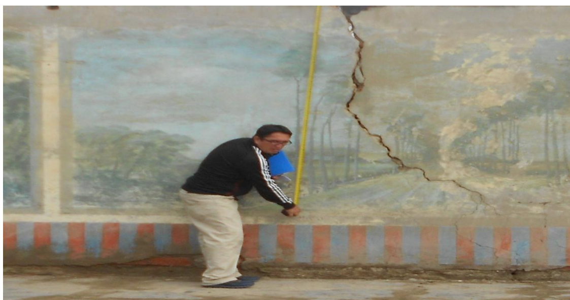
Fotografía 02: Se aprecian la presencia de grietas en muros del cerco perimétrico del ex local comercial los 6 hermanos.
