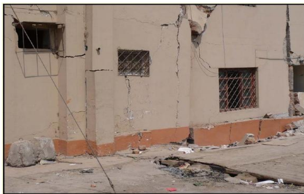
Imagen 14: Asentamientos diferenciales de los cimientos.
