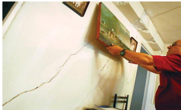
Imagen 12: Fisuras debido a acciones mecánicas externas.
