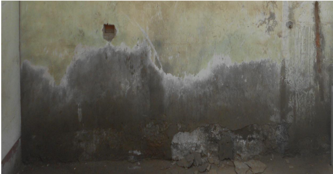
Fotografía 03: Se observa la presencia de eflorescencia en muros del cerco perimétrico del ex local comercial los 6 hermanos.
