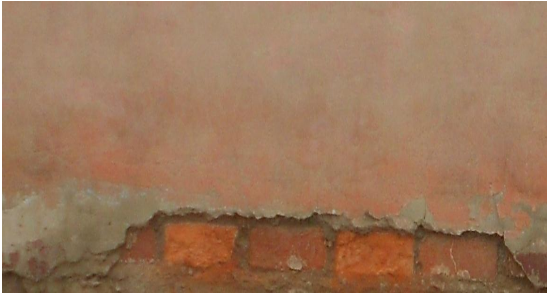
Fotografía 05: Se visualizan la presencia de erosión en muros del cerco perimétrico del ex local comercial los 6 hermanos.
