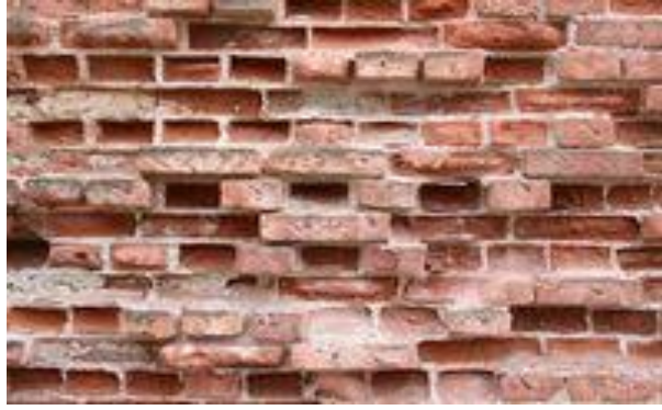
Imagen 20: Erosión por acción eólica.
