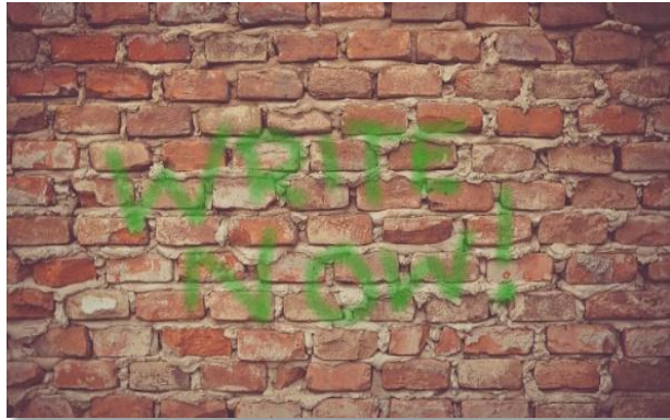
Imagen 11: Fisuras por deficiencias de colocación del ladrillo.
