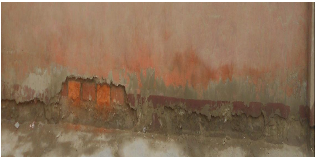
Fotografía 04: Se observan la presencia de eflorescencia y erosión en muros del cerco perimétrico del ex local comercial los 6 hermanos.
