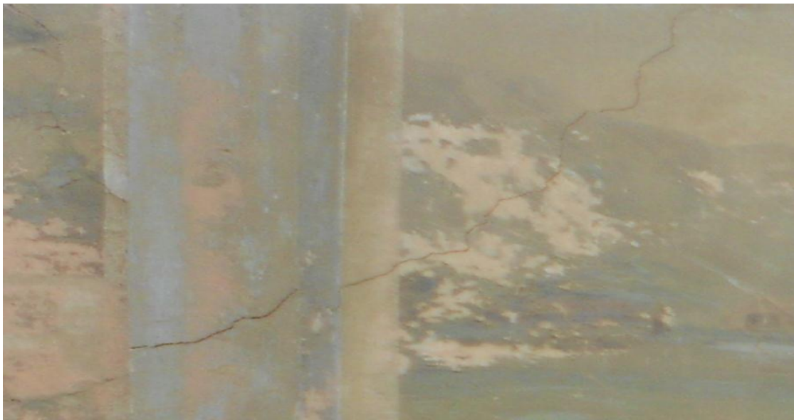
Fotografía 06: Se visualizan la presencia de fisuras en muros y columnas del cerco perimétrico del ex local comercial los 6 hermanos.
