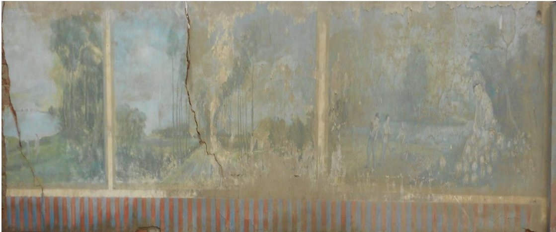
Fotografía 01: Se aprecia la presencia de grieta en muro.
