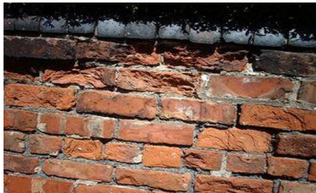
Imagen 19: Erosión impactos y rozamientos.
